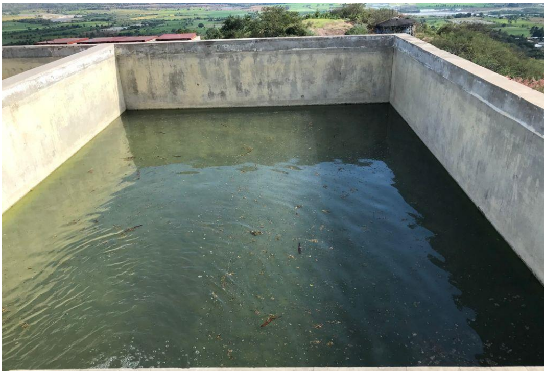
Figura 15. foto de la planta de tratamiento con presencia de malezas.
