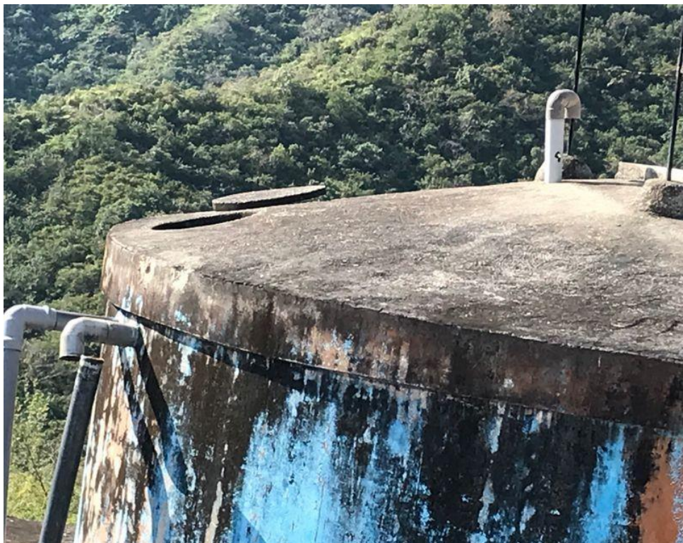
Figura 13. Tapa del reservorio fuera de su lugar.
