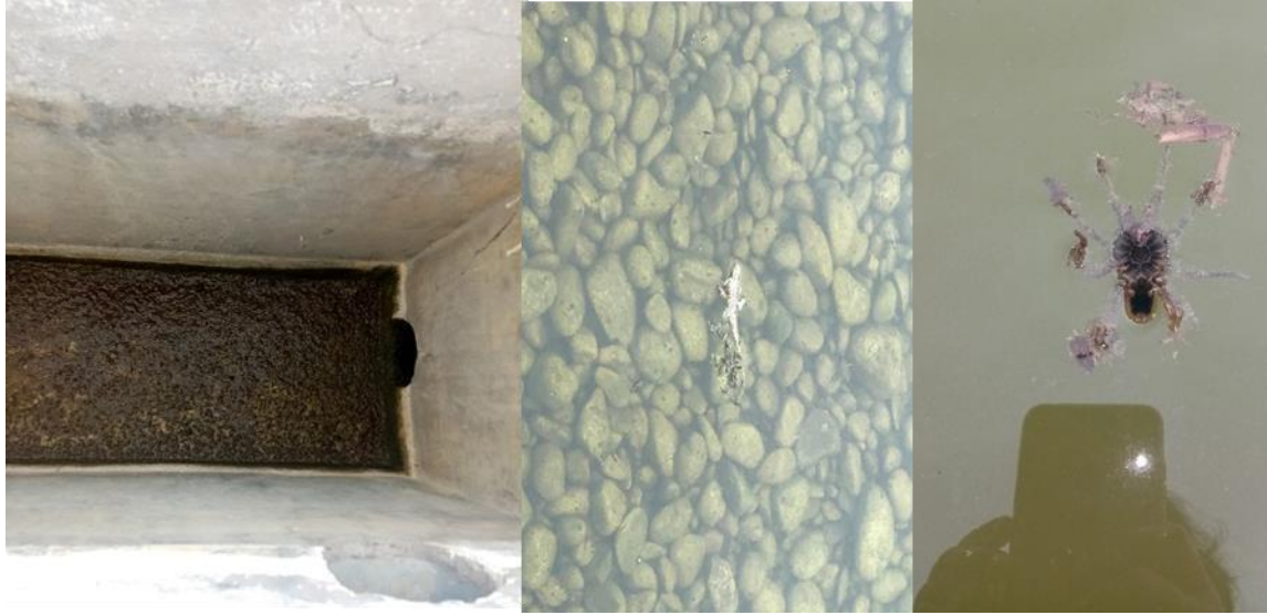
Figura 18. presencia de barro marrón en la canaleta en ausencia de agua y animales en descomposición en la planta de tratamiento.
