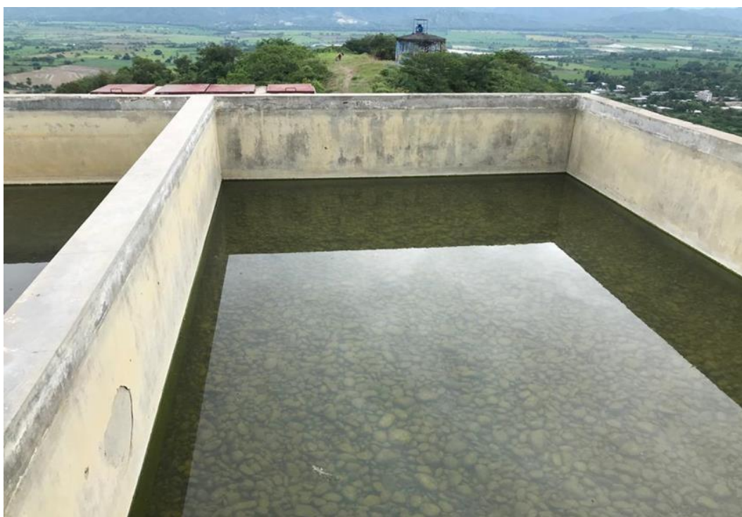
Figura 11. Segundo pozo de la planta de tratamiento y al fondo se observa el reservorio y la caseta de cloración.
