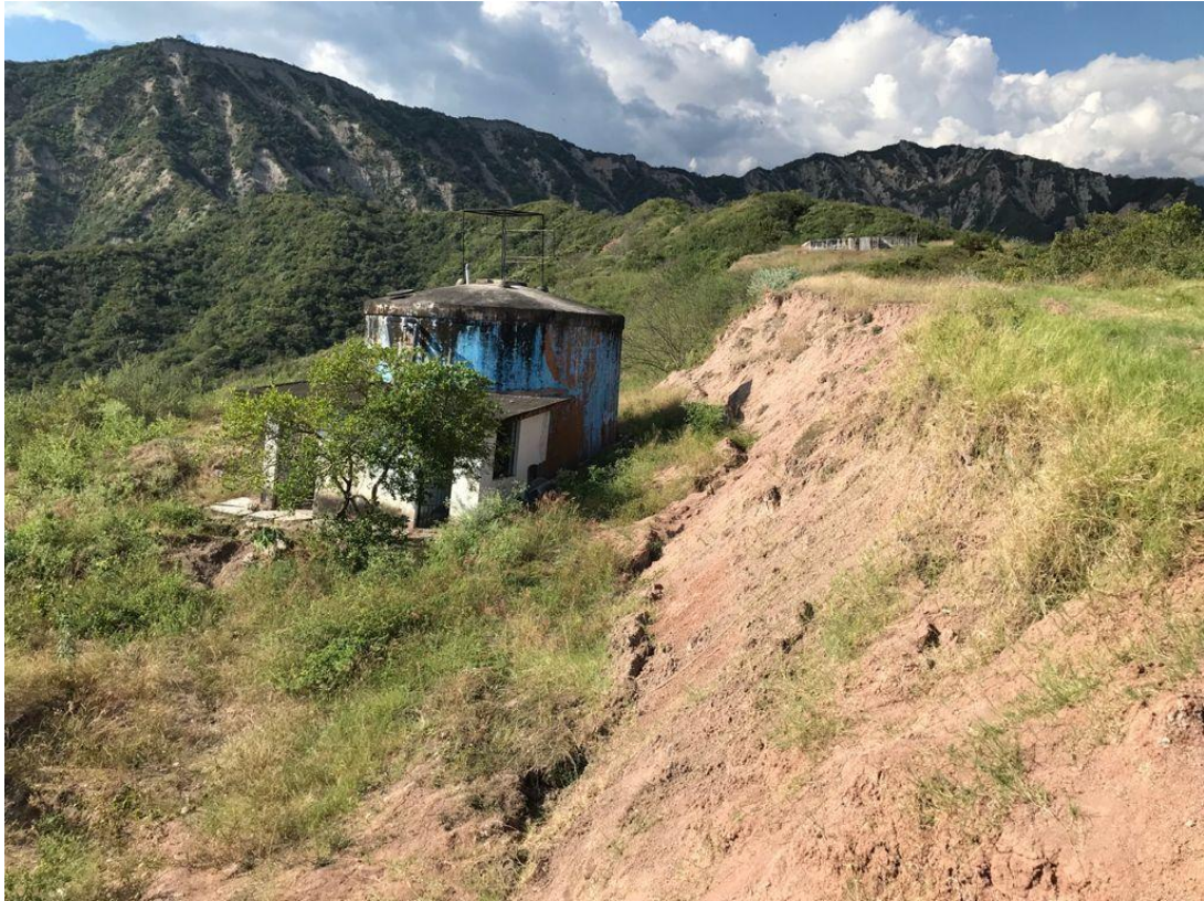
Figura 12. Deslizamiento del reservorio.
