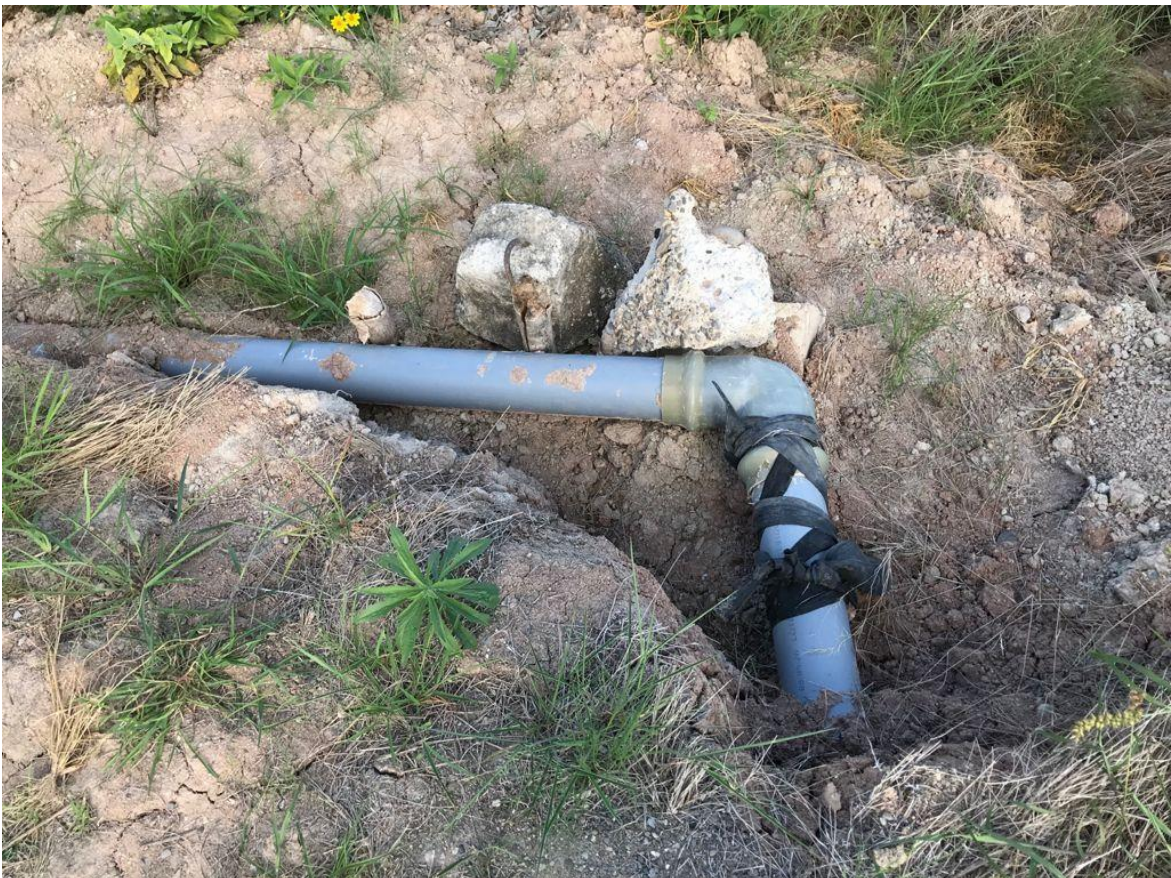
Figura 19. tubería del agua que llega a la planta de tratamiento en mal estado.
