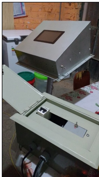
Figura 64 Montaje mecánico del prototipo y tablero de control eléctrico. Fuente : Elaboración propia.
