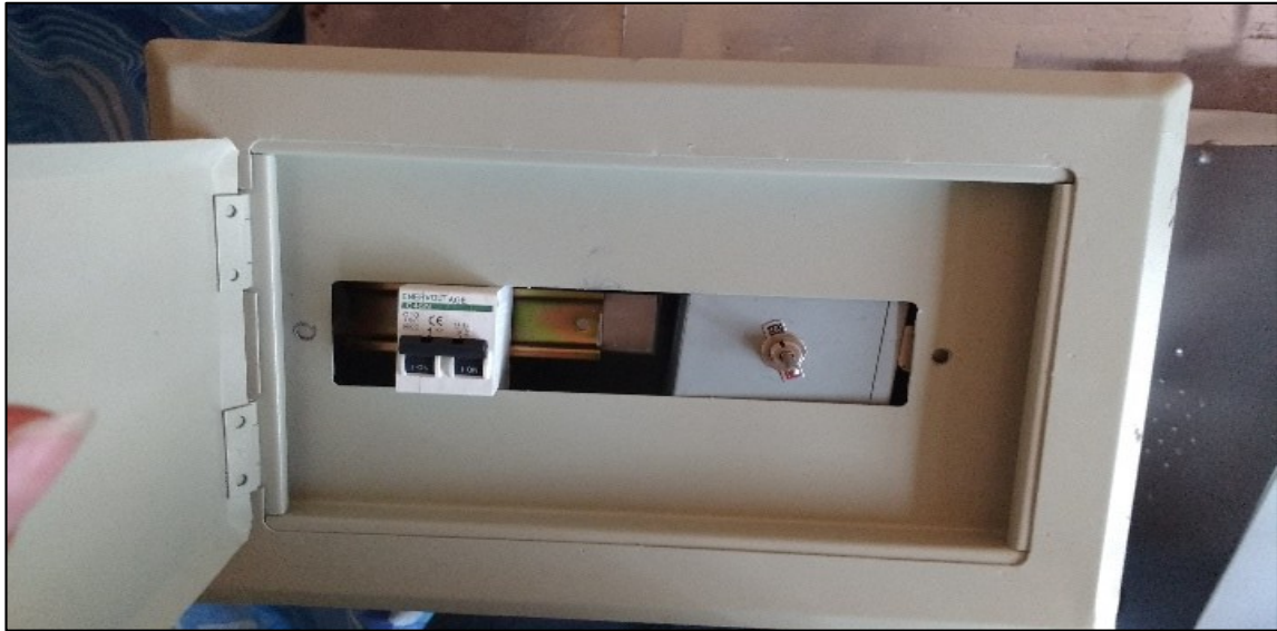
Figura 58 Ensamble de tapa en tablero de alimentación y protección.
