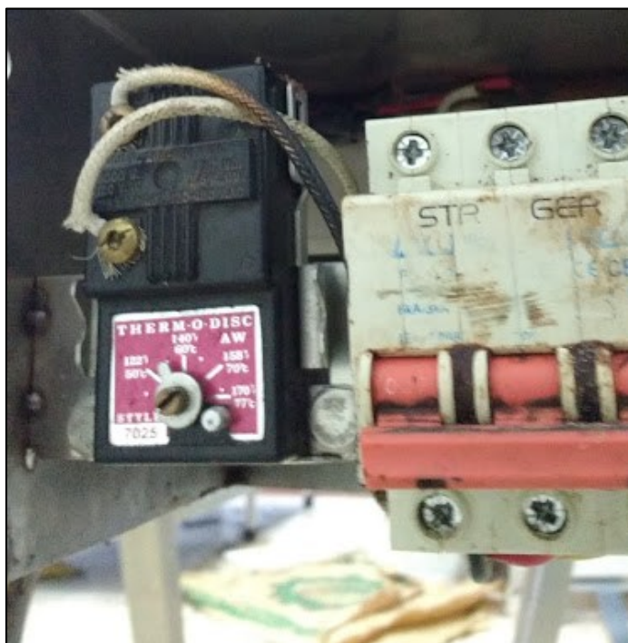
Fotografía 1 Termostato de regulación analógica y control on – off. Fuente : Elaboración propia.
