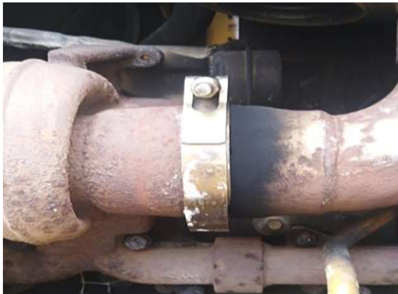
Figura 11. Falla en el codo de tubería de aire, funcionando a altas temperatura
