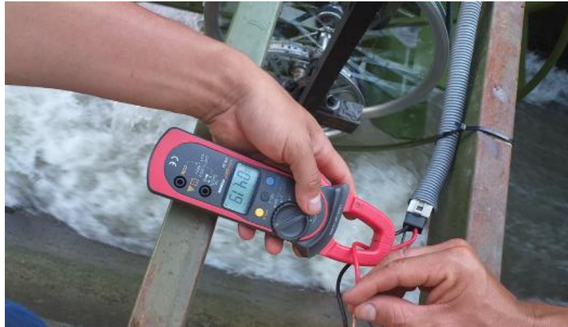
Figura 32. Toma fotográfica de medición de corriente de carga a la batería de almacenamiento con 4,19 A.
