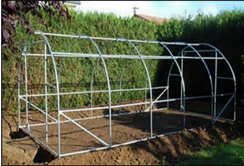
Figura 12. Estructura de hierro galvanizado de la cámara de secado
