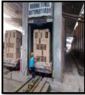
Figura 10. Ingreso de estanterías al horno túnel en fábrica industrial
