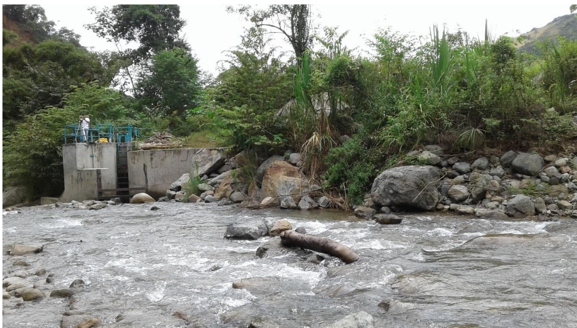
Descripción: Bocatoma del río Amojú – sector La Corona Jaén-Cajamarca; Margen Izquierda de la sección del cauce principal.
