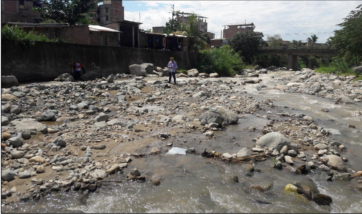
Trabajo en campo de topografía con estación total, toma de detalles de la sección del río Amojú, aguas arriba del puente Orellana.
