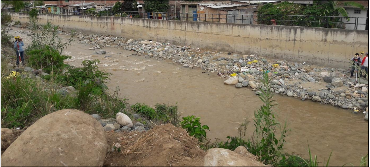
Trabajo en campo de topografía con estación total, toma de detalles de las márgenes y sección del río Amojú – Sector San Camilo
