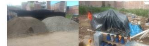
Imagen 01: Obra – Vivienda Calle Mariscal Ureta, se puede apreciar a la mano derecha el apilamiento de Bolsas de Cemento y a la izquierda el agregado almacenado, ambos de forma deficiente.
