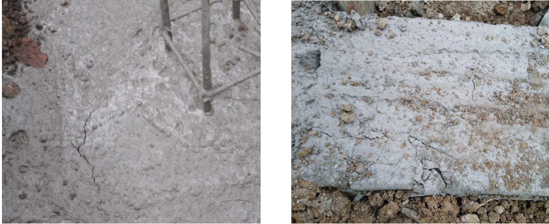
Figura 53. Figura 54. Fisuras producidas en zapata y viga de cimentación como consecuencia de no haber sido curadas.
