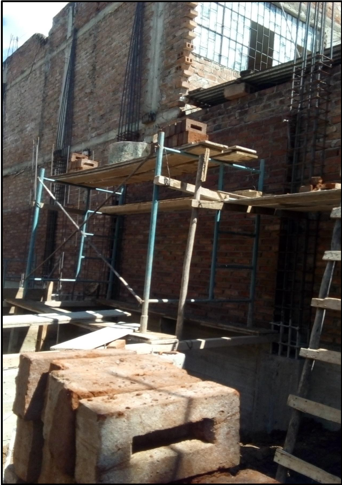
Figura. 11. Se puede observar que los andamios son usados deficientemente
