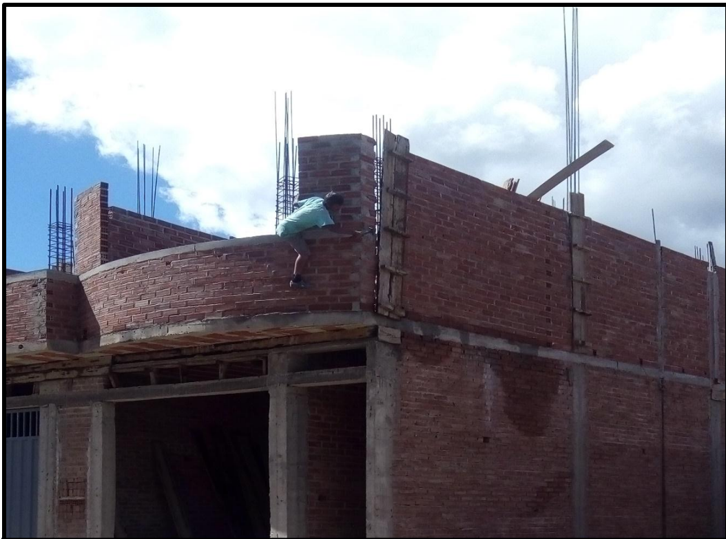
Figura. 13. Se puede observar que el trabajador no cuenta con Arnes de Seguridad
