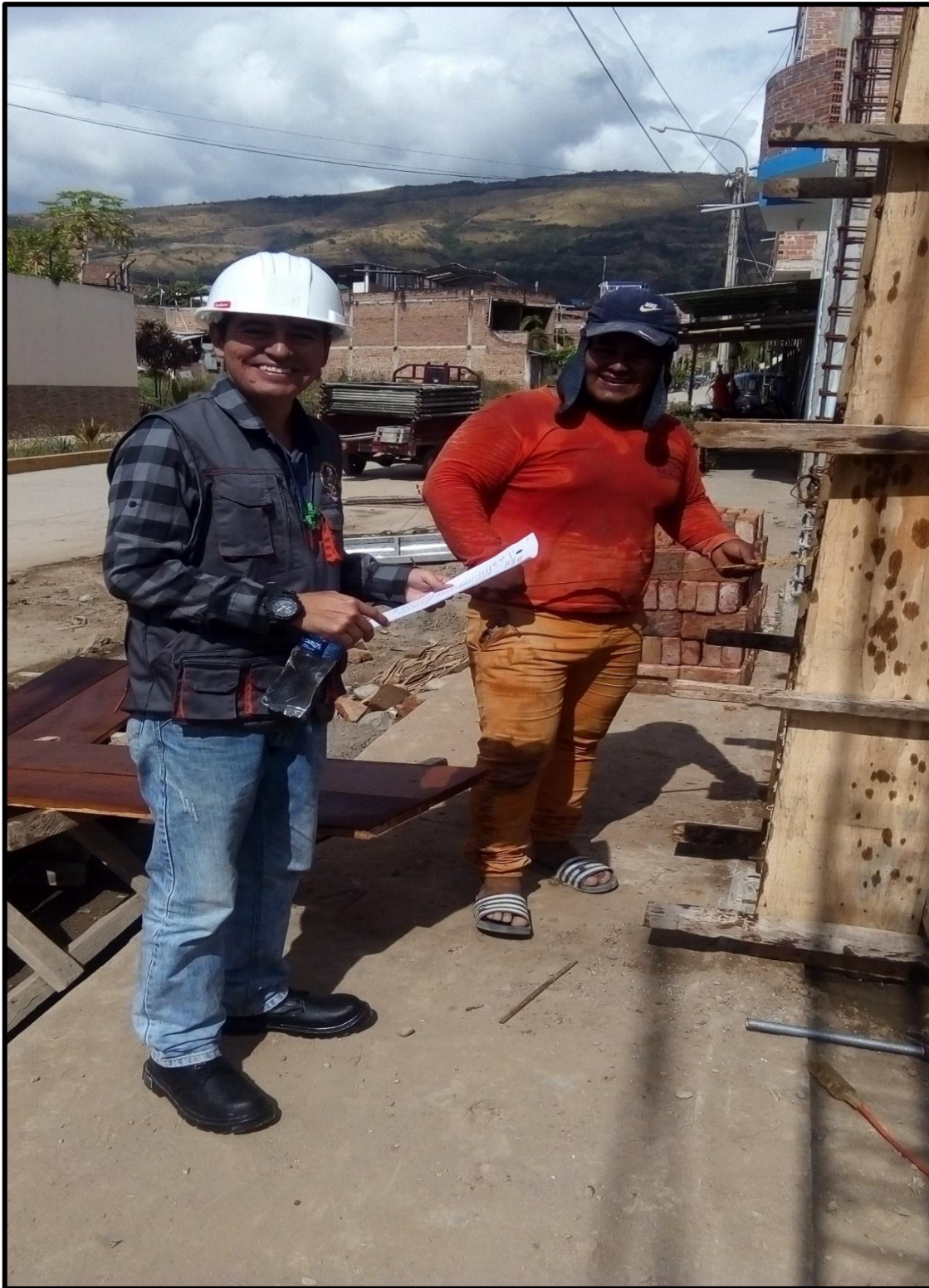
Figura 06. Se puede observar que el trabajador no cuenta con los EPI adecuados
