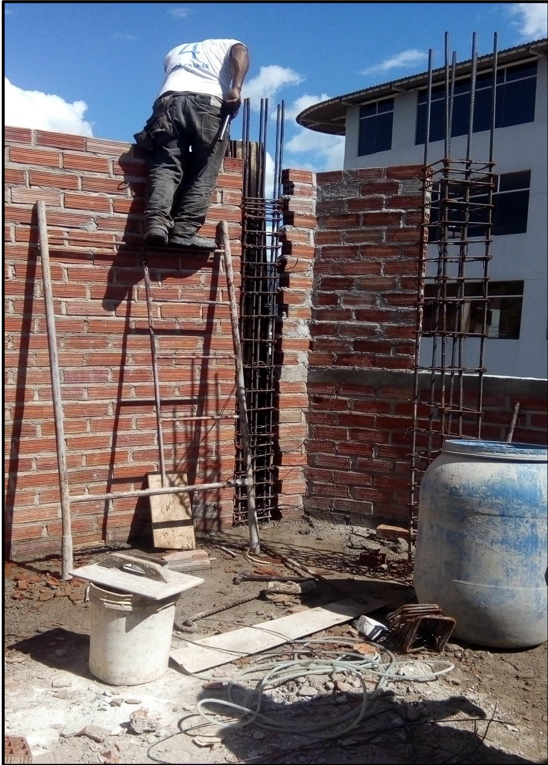
Figura. 07. Se puede observar que no existe un adecuado Orden y Limpieza, además de una mala utilización del andamio
