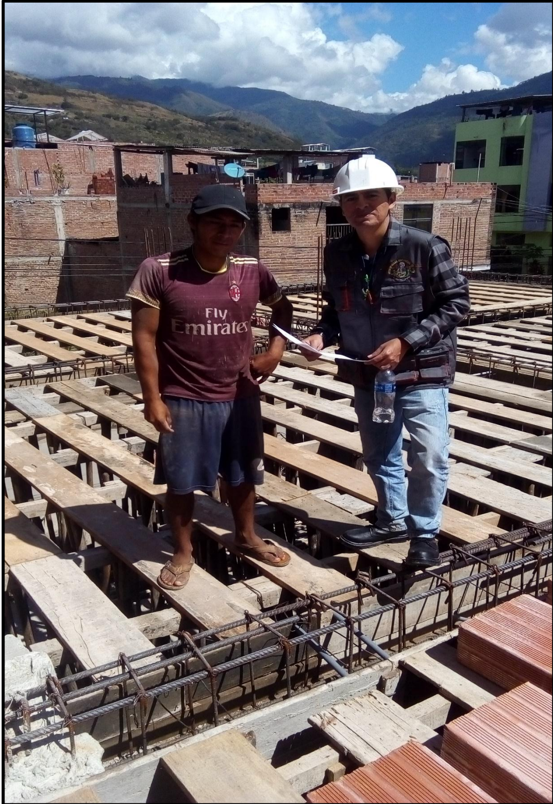
Figura. 10. Se puede observar que el trabajador no cuenta con los EPI adecuados
