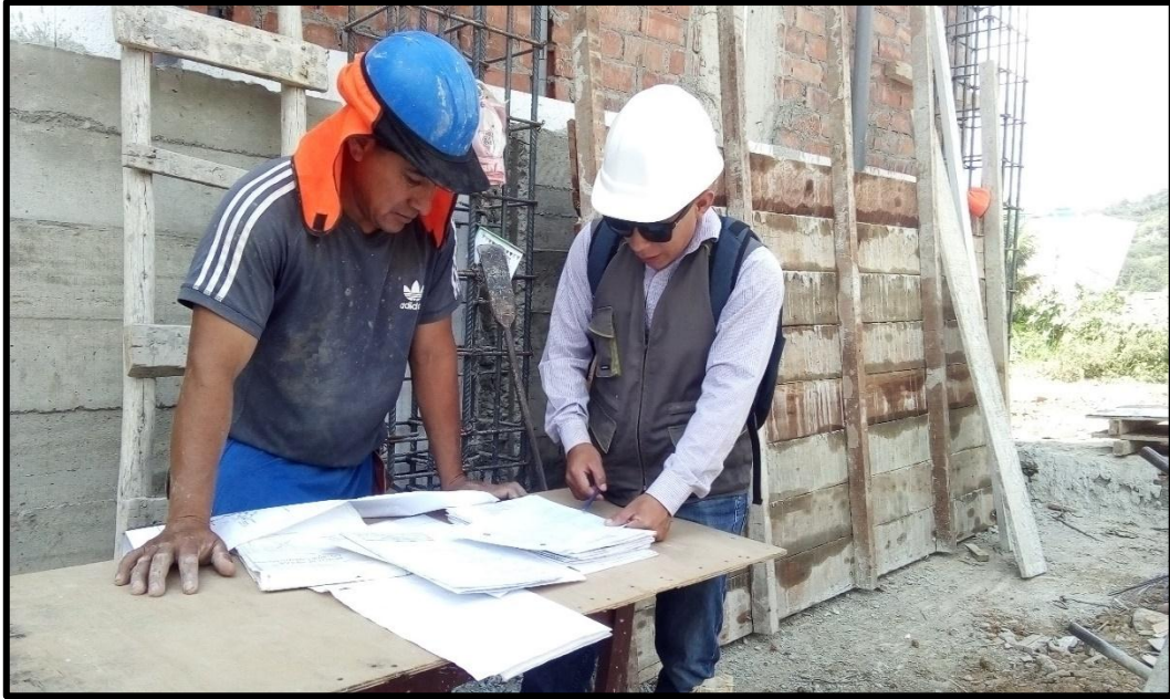
Figura. 12. Se puede observar que el trabajador cuenta parcialmente con los EPI
