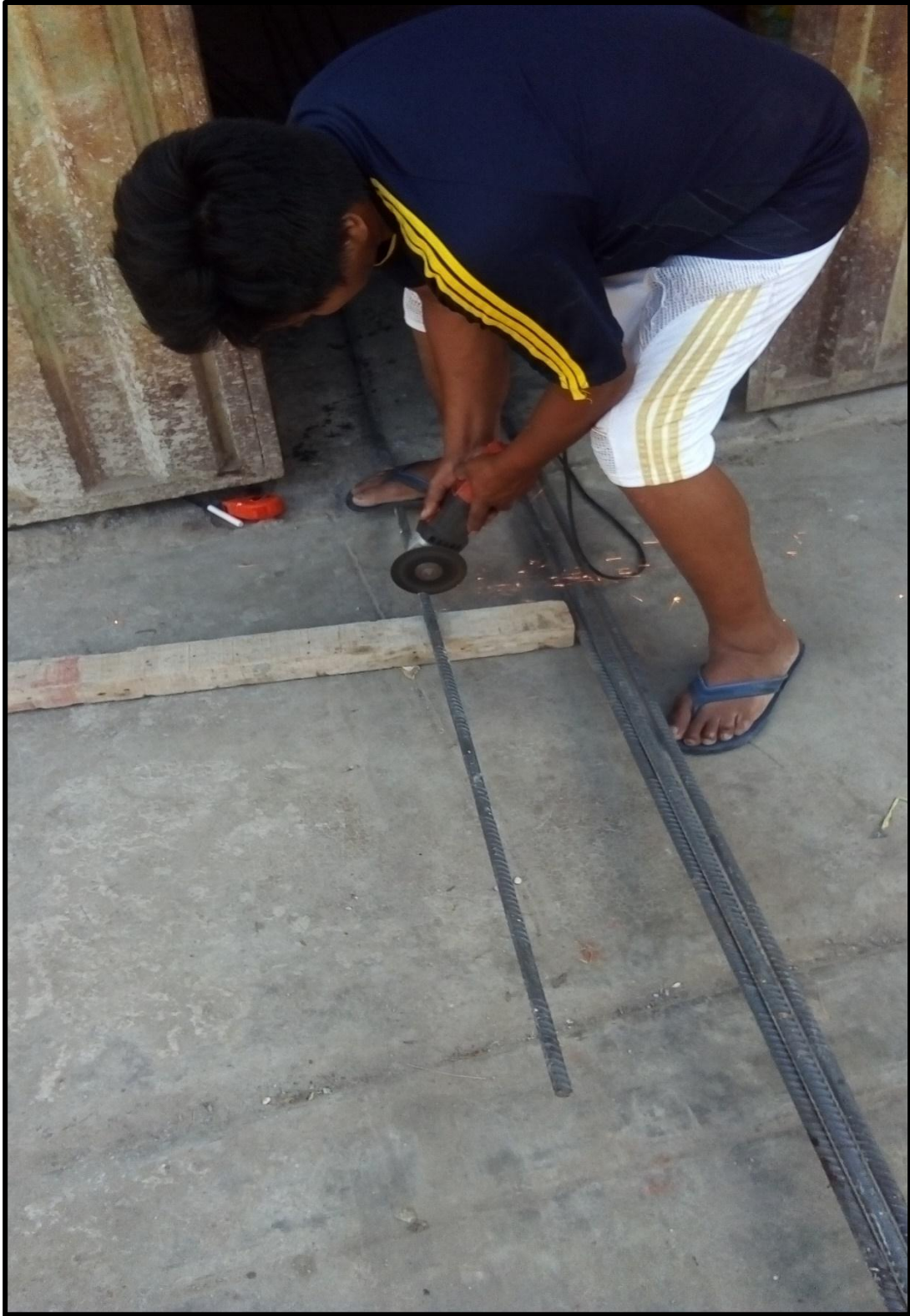
Fig. 15. Se puede observar que el trabajador no cuenta con los EPI adecuados
