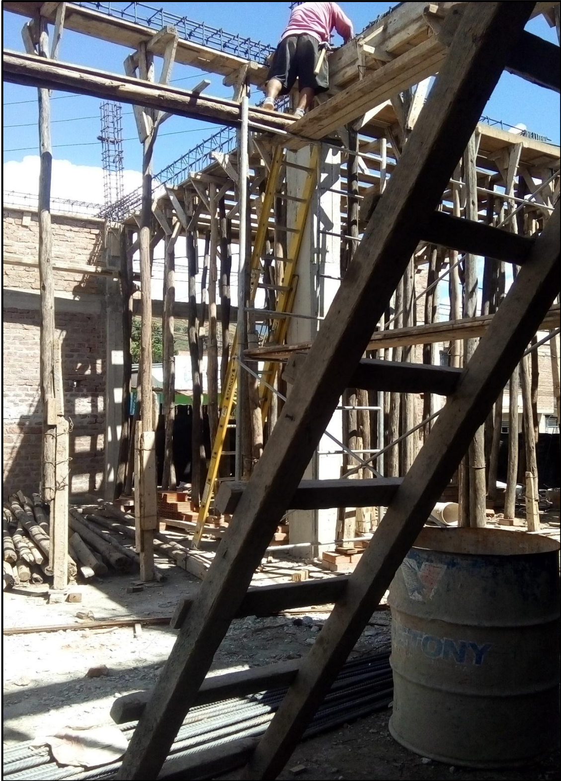
Figura. 09. Se puede observar que el trabajador no cuenta con un Arnés de Seguridad
