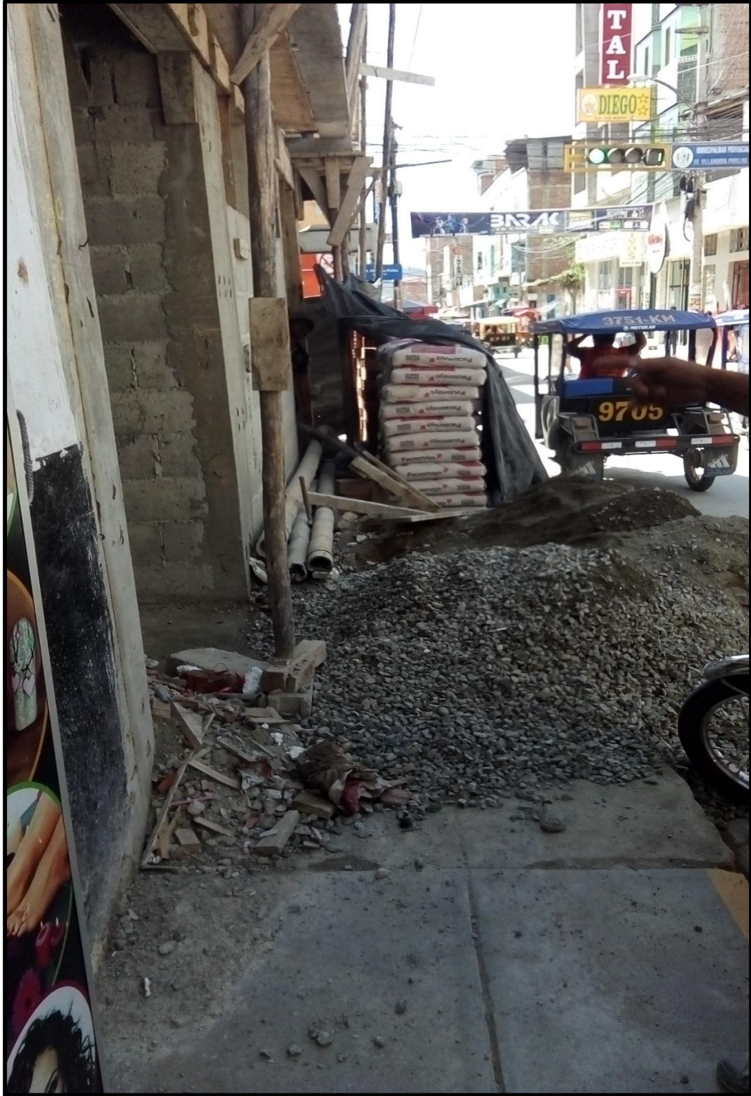
Figura. 16. Se puede observar que existe un incorrecto acopio de materiales y una mala disposición de desmonte, obstruyendo la circulación peatonal.
