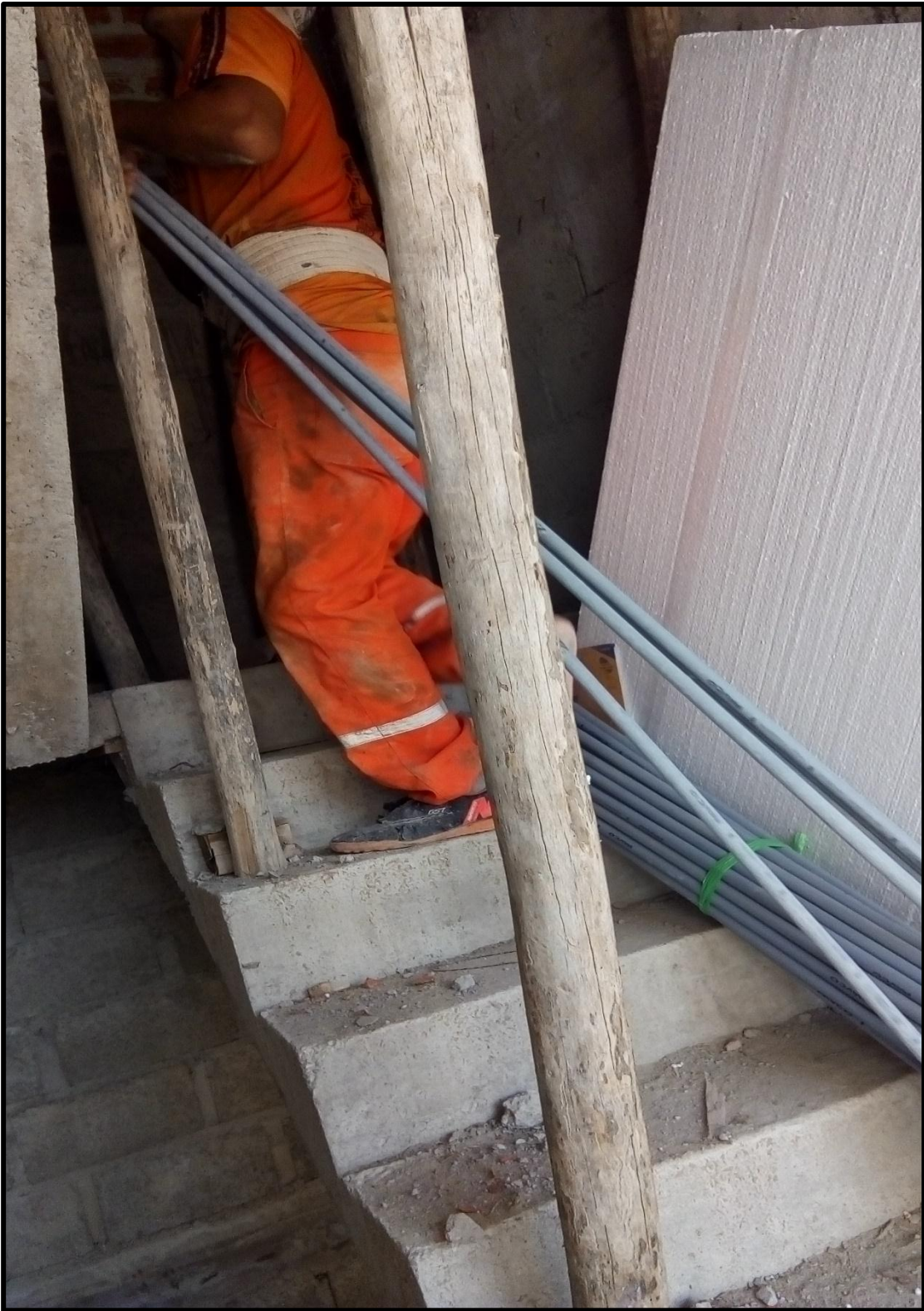
Figura. 14. Se puede observar que se obstaculiza circulación de los trabajadores
