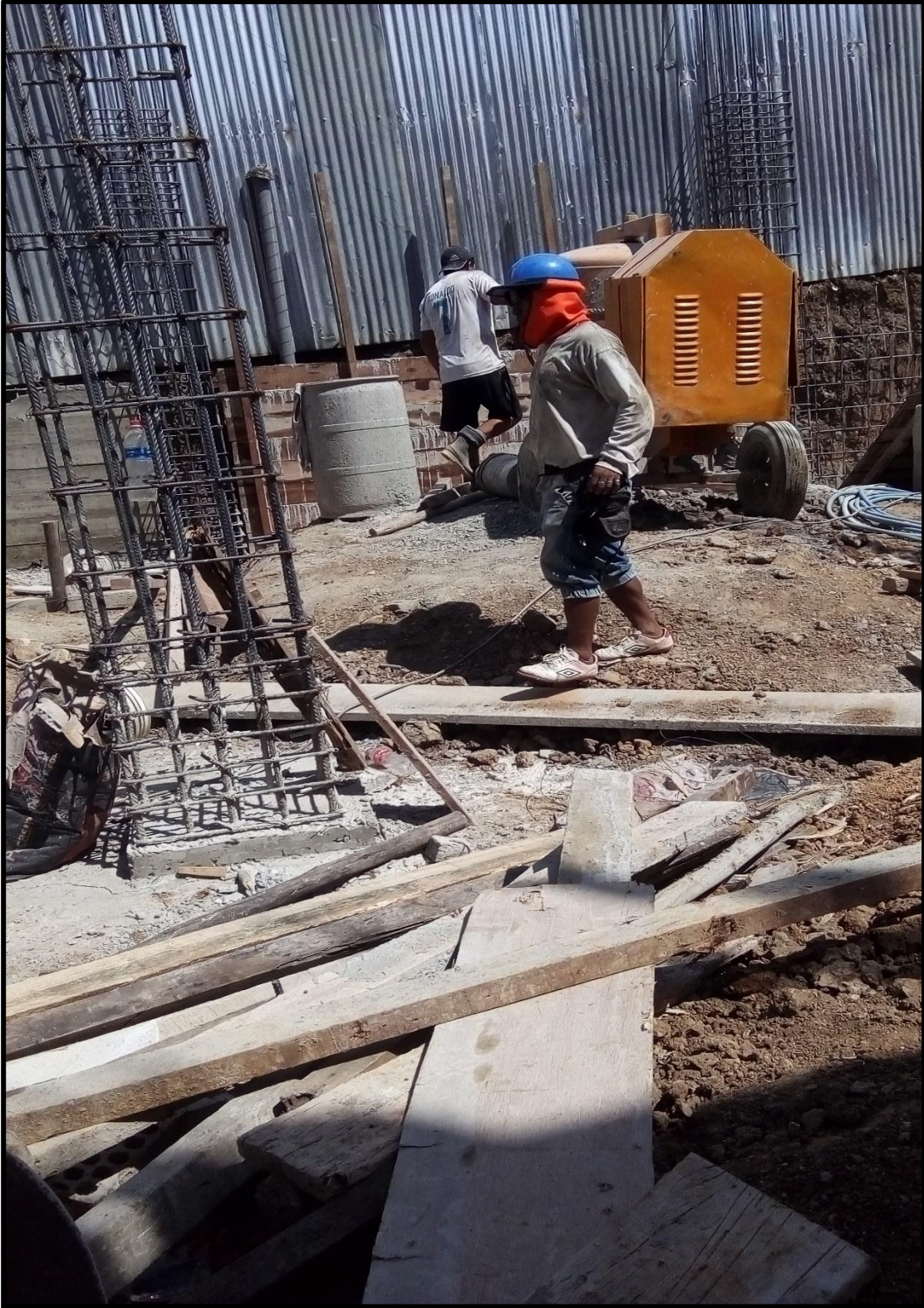
Figura. 08. Se puede observar que no existe un adecuado Orden y Limpieza.
