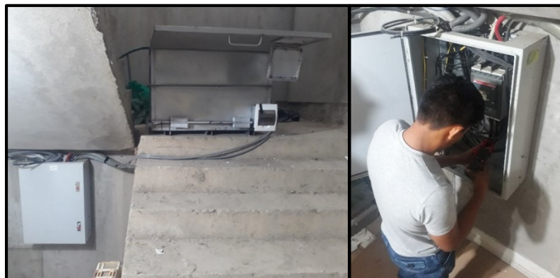
Figura 9. Instalación eléctrica externa del tanque de curado acelerado.
