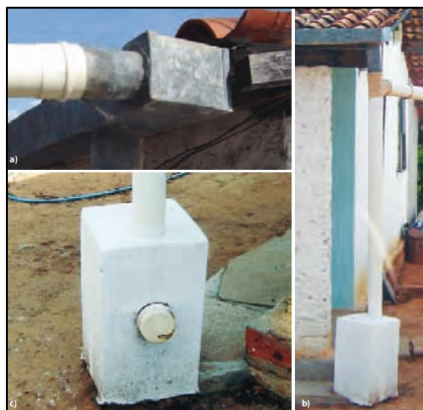
Figura N° 52. Sistema de acople empírico entre canaleta y bajante hacia el interceptor y tubo de conducción al almacenamiento. Fuente: FAO.
