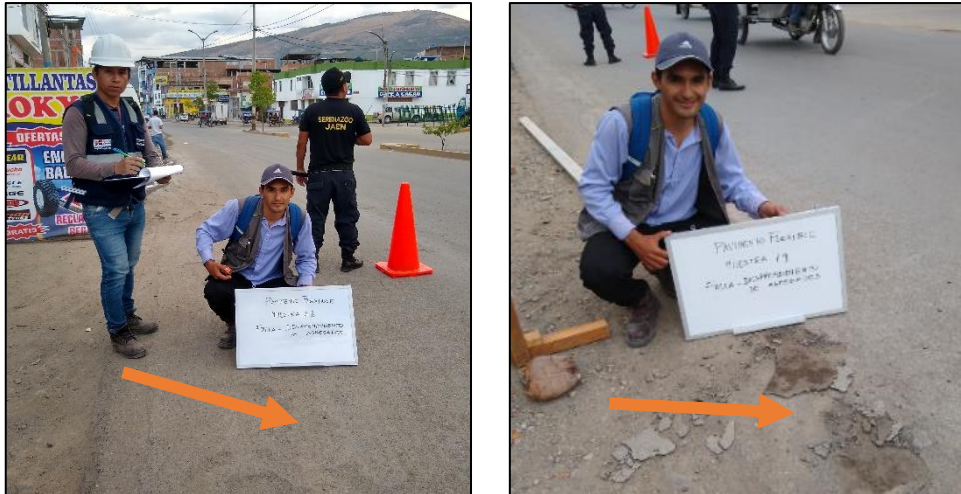
Figura 17. Figura 18. Falla-desprendimiento de agregados en pavimento flexible.
