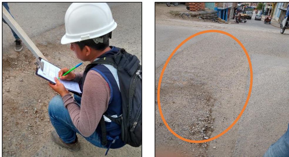
Figura 19. Figura 20. Falla-parche utilitario en pavimento flexible.
