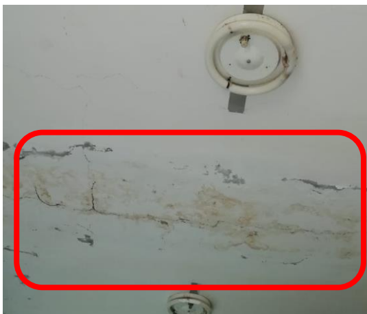
Figura 33. Fisura en losa aligerada (módulo 01).
