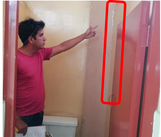
Figura 29. Fisura en columna-muro (módulo 3).
