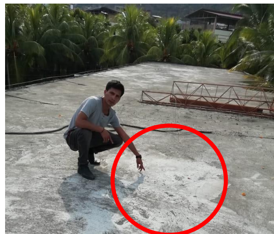
Figura 32. Lugar de filtración de agua en losa (módulo 01).
