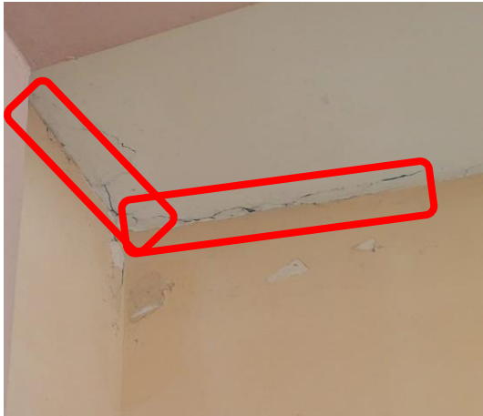
Figura 28. Fisuras presentadas en la losa-columna (módulo 1).
