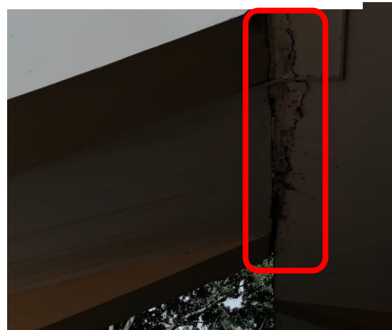
Figura 30. Mala conexión en escalera (módulo 01).
