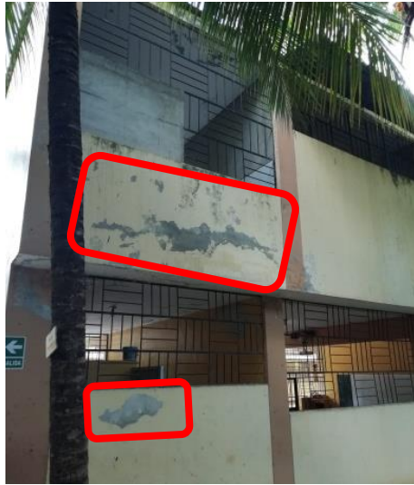
Figura 38. Descascaramiento de pintura.
