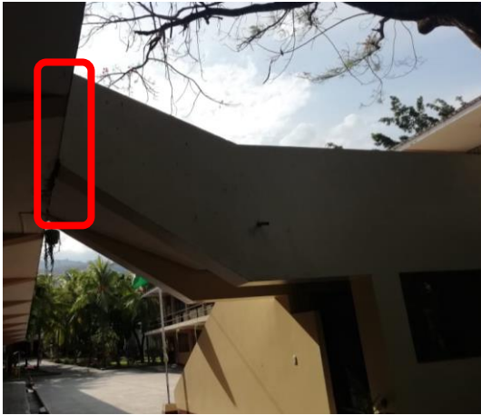
Figura 22. Fisura en escalera de 4 mm aproximadamente.
