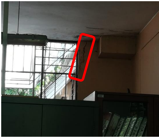
Figura 44. Fisura en pared de módulo 03.
