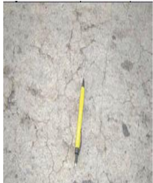
Fig. 60: Fisuración o Grietas de Retracción
