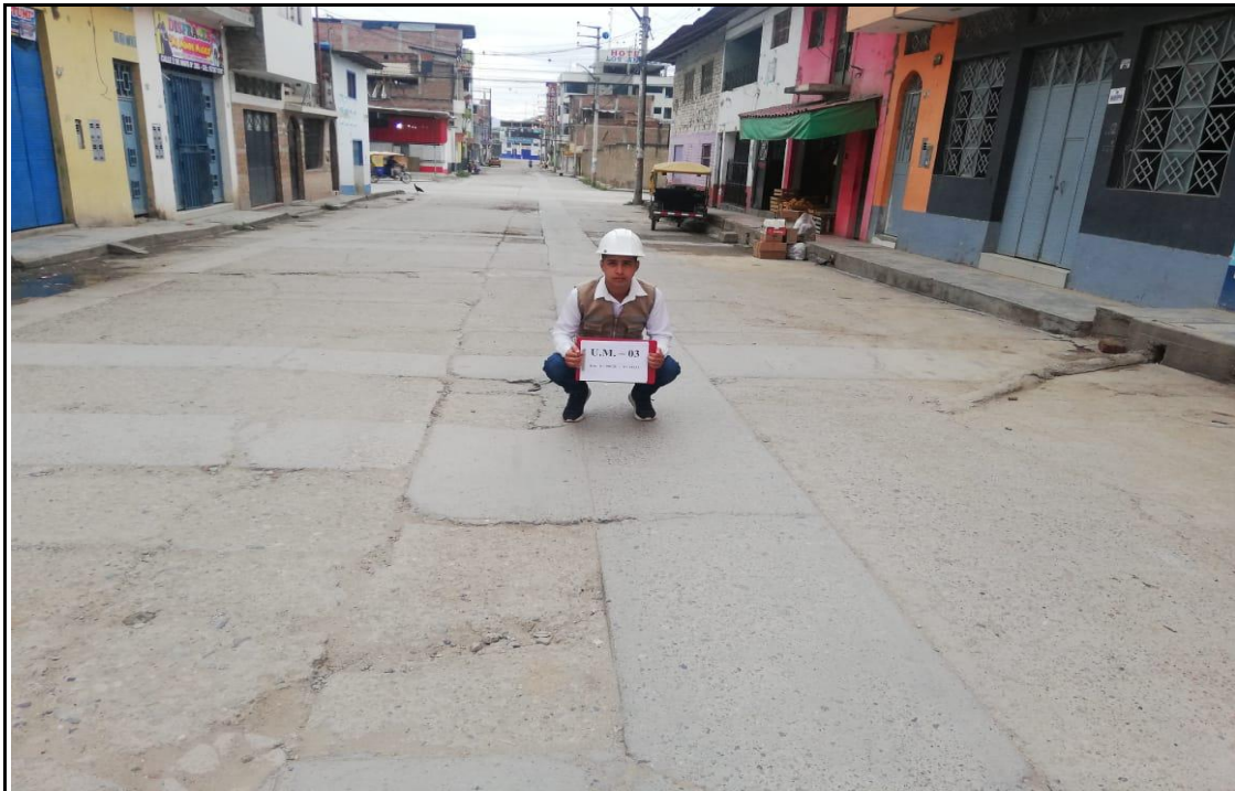
Foto 3. UNIDAD DE MUESTRA N° 03: Ubicado en la calle Dos de Mayo en la progresiva Km 0+090.26 al Km 0+142.11, en la Cuadra N° 02; conformado por los paños del 41 al 60 (izquierda y derecha). En la U.M. N° 03 presenta fallas de: Grietas de Esquina (22) de Severidad Media, Losa Divida (23) de Severidad alta, Grietas Lineales (28) de Severidad Media , Parche Grande (29) de Severidad Media y Grietas de Retracción (37) de Severidad Leve.
