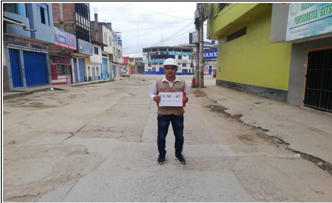
Foto 7. UNIDAD DE MUESTRA N° 07: Ubicado en la calle Dos de Mayo en la progresiva Km 0+269.36 al Km 0+306.01, en la Cuadra N° 04; conformado por los paños del 115 al 128 (izquierda y derecha). En la U.M. N° 07 presenta fallas de: Grietas de Esquina (22) de Severidad Media, Losa Divida (23) de Severidad alta, Grietas Lineales (28) de Severidad Media, Parche Grande (29) de Severidad Media y Grietas de Retracción (37) de Severidad Leve.
