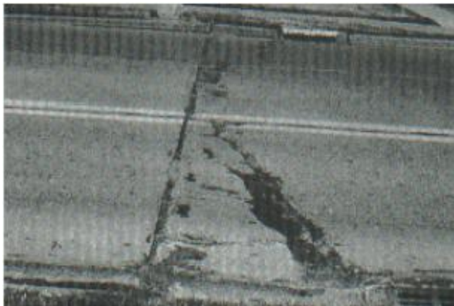
Fig. 36: Punzonamiento de severidad media
