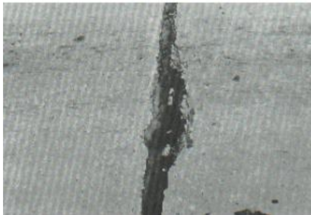
Fig. 17: Daño del sello de junta de severidad media
