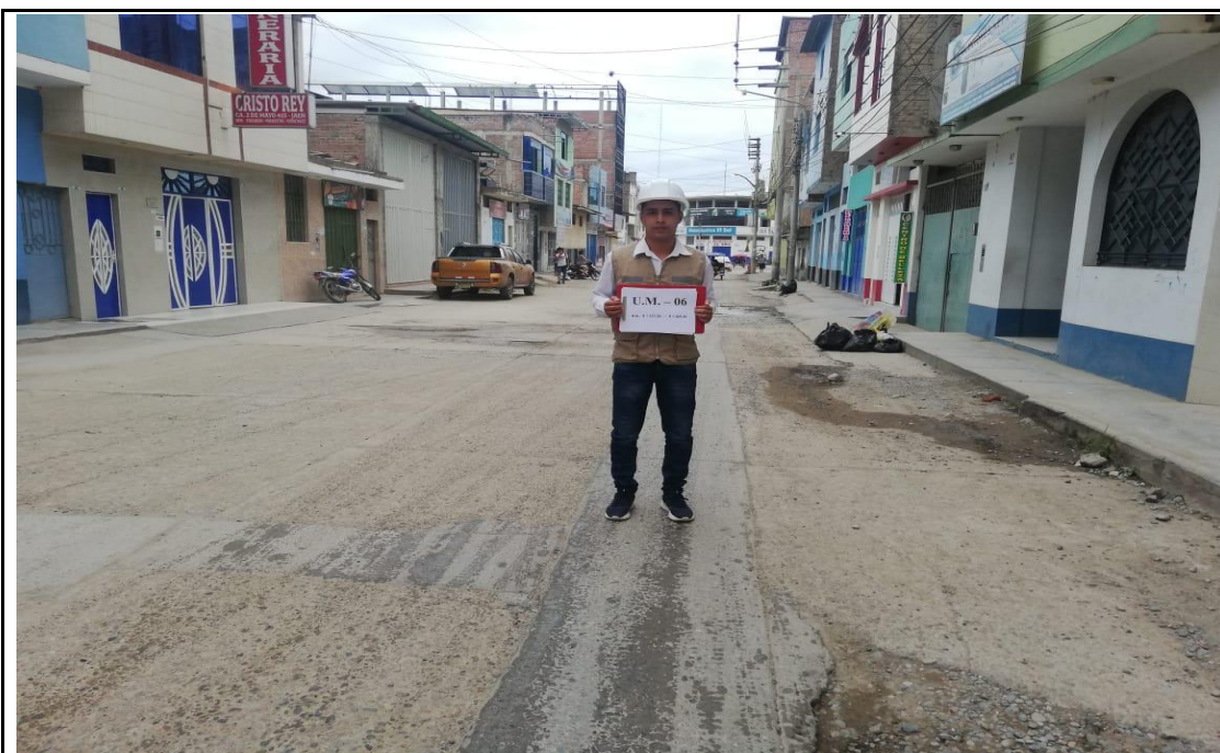
Foto 6. UNIDAD DE MUESTRA N° 06: Ubicado en la calle Dos de Mayo en la progresiva Km 0+237.30 al Km 0+269.36, en la Cuadra N° 04; conformado por los paños del 101 al 114 (izquierda y derecha). En la U.M. N° 06 presenta fallas de: Grietas de Esquina (22) de Severidad Media, Losa Divida (23) de Severidad alta, Grietas Lineales (28) de Severidad Media , Parche Grande (29) de Severidad Media y Grietas de Retracción (37) de Severidad Leve.
