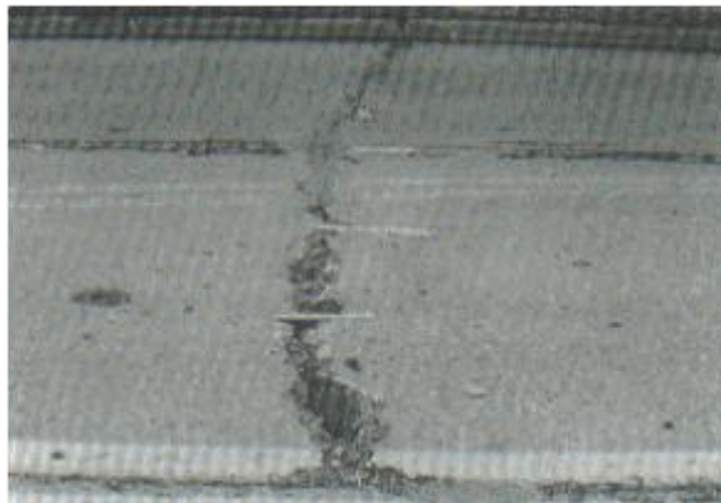
Fig. 21: Grietas lineales de severidad alta en losa
