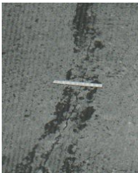
Fig. 19: Grietas lineales de severidad leve
