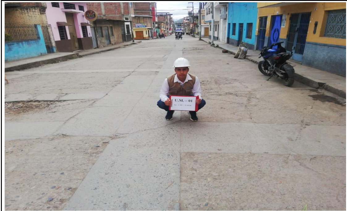
Foto 1. UNIDAD DE MUESTRA N° 01: Ubicado en la calle Dos de Mayo en la progresiva Km 0+00 al Km 0+047.48, en la Cuadra N° 01; conformado por los paños del 01 al 20 (izquierda y derecha). En la U.M. N° 01 presenta fallas de: Grietas de Esquina (22) de Severidad Media, Losa Divida (23) de Severidad alta, Grietas Lineales (28) de Severidad Media , Parche Grande (29) de Severidad Media y Grietas de Retracción (37) de Severidad Leve.
