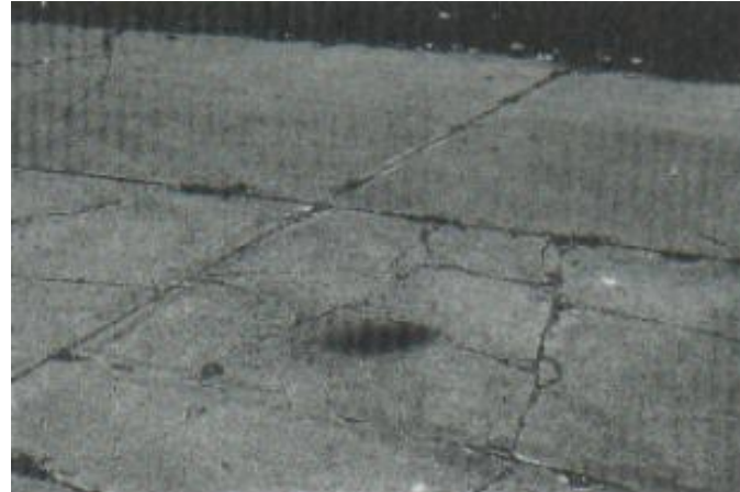
Fig. 10: Losa dividida de severidad alta
