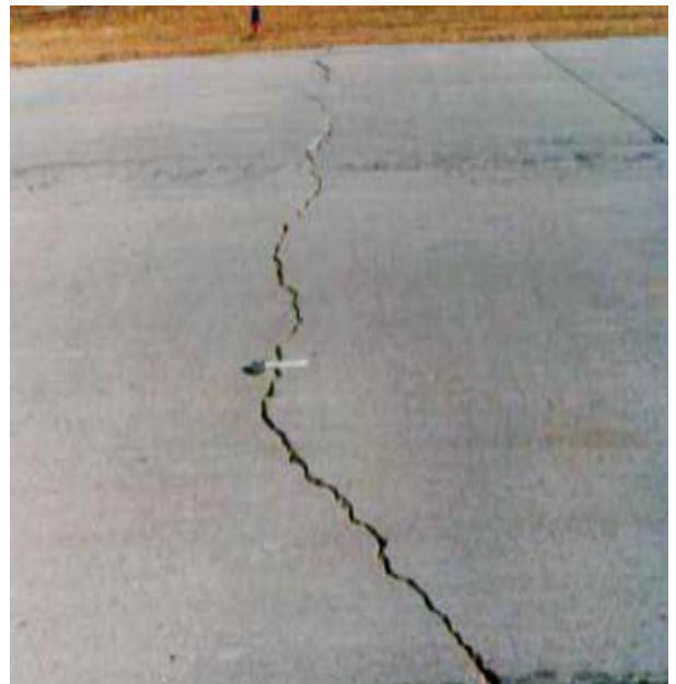
Fig. 54: Fisuración o Grieta Transversal
