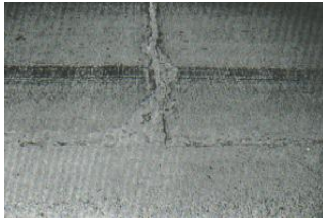
Fig. 46: Descascaramiento de esquina de severidad media
