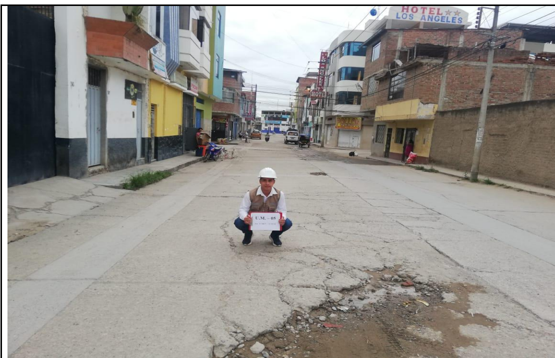
Foto 5. UNIDAD DE MUESTRA N° 05: Ubicado en la calle Dos de Mayo en la progresiva Km 0+188.77 al Km 0+237.30, en la Cuadra N° 03; conformado por los paños del 81 al 100 (izquierda y derecha). En la U.M. N° 05 presenta fallas de: Grietas de Esquina (22) de Severidad Media, Losa Divida (23) de Severidad alta, Grietas Lineales (28) de Severidad Media , Parche Grande (29) de Severidad Media y Grietas de Retracción (37) de Severidad Leve.
