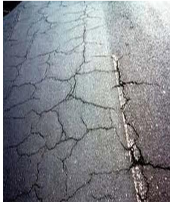
Fig. 57: Fisuras en Bloque
