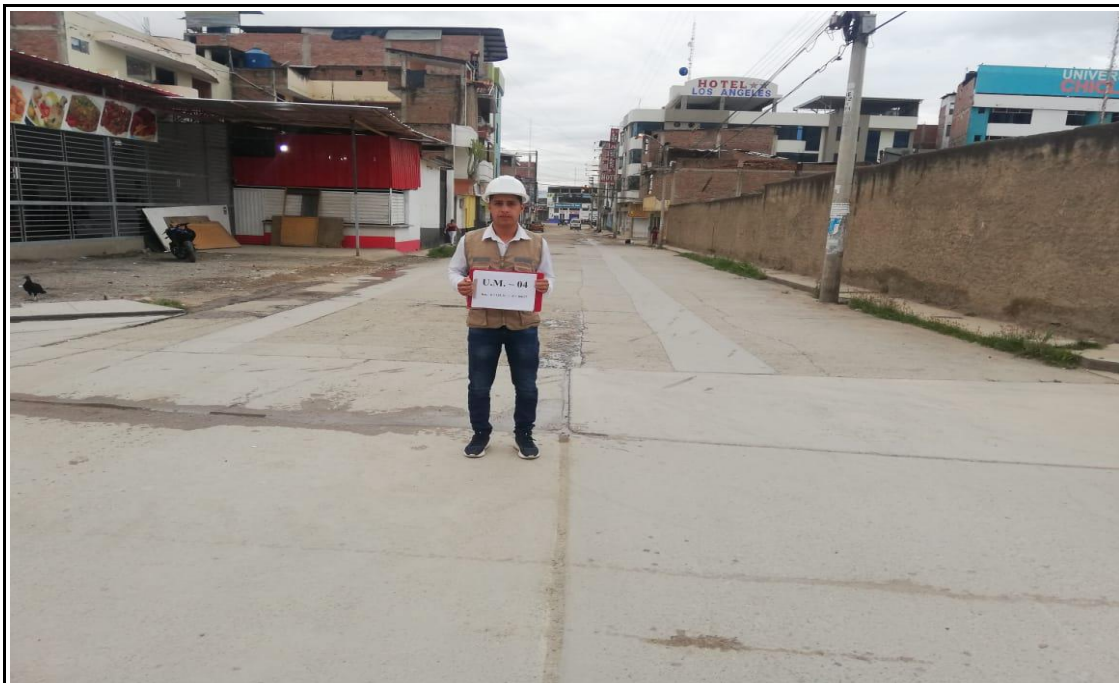
Foto 4. UNIDAD DE MUESTRA N° 04: Ubicado en la calle Dos de Mayo en la progresiva Km 0+142.11 al Km 0+188.77, en la Cuadra N° 03; conformado por los paños del 61 al 80 (izquierda y derecha). En la U.M. N° 04 presenta fallas de: Grietas de Esquina (22) de Severidad Media, Losa Divida (23) de Severidad alta, Grietas Lineales (28) de Severidad Media , Parche Grande (29) de Severidad Media y Grietas de Retracción (37) de Severidad Leve.
