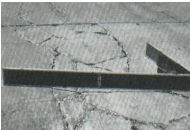
Fig. 37: Punzonamiento de severidad alta
