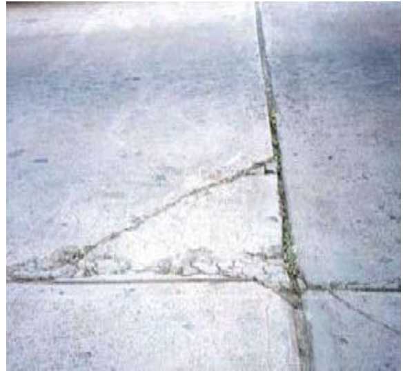
Fig. 53: Roturas o Grietas de Esquina
