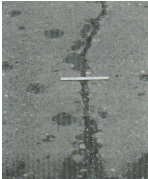
Fig. 20: Grietas lineales de severidad media
