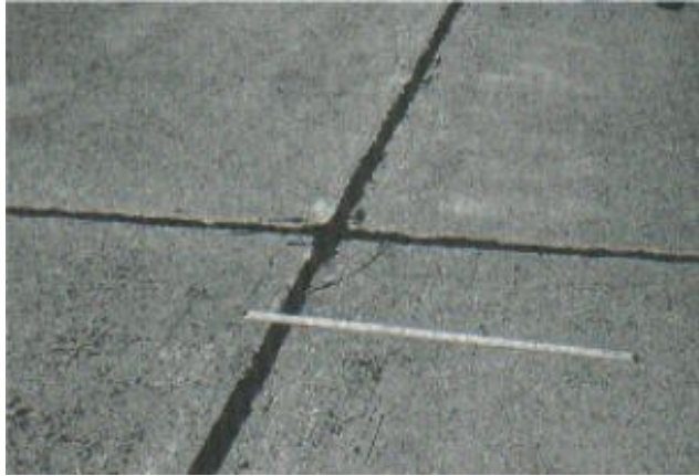
Fig. 45: Descascaramiento de esquina de severidad leve
