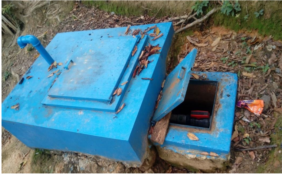
Figura 28. Cámara rompe presión tipo 07 con deficiencias.
