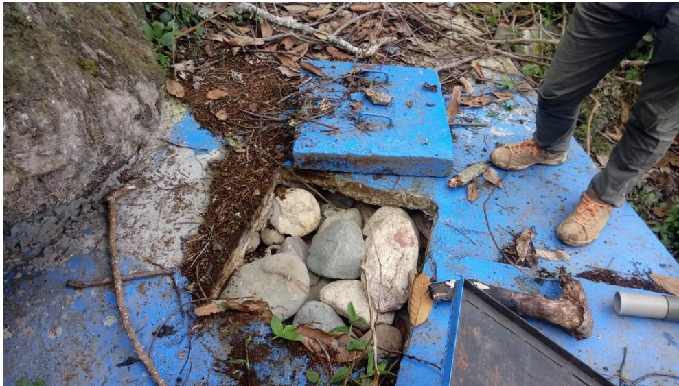
Figura 7. Material filtrante inadecuado y contaminado en Captación.
