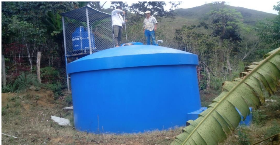
Figura 14. Reservorio y caseta de cloración en buen estado.
