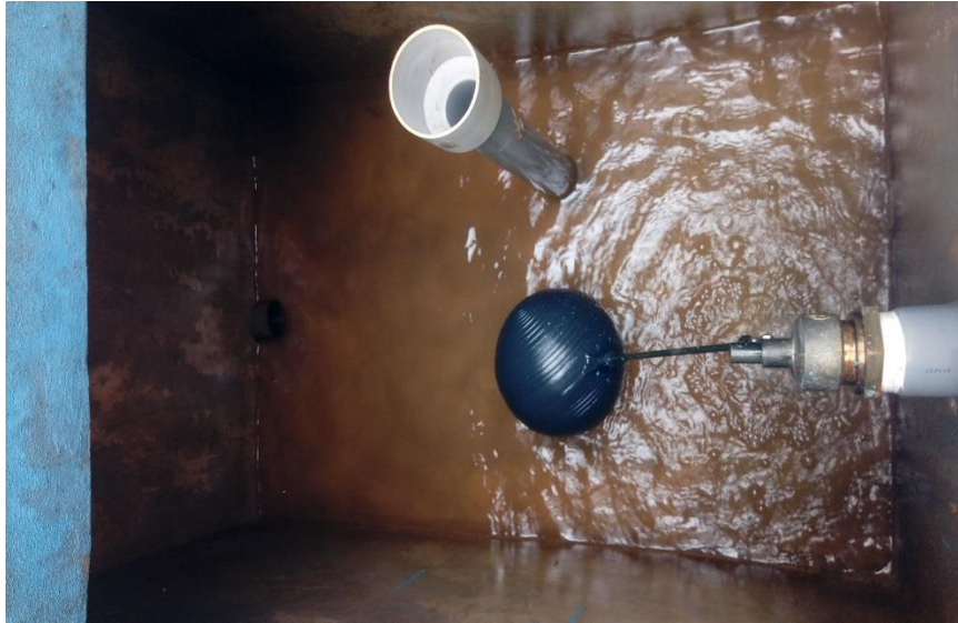
Figura 30. Cámara rompe presión tipo 07 sin canastilla de salida.
