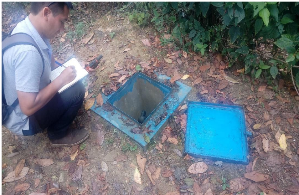
Figura 33. Válvula de aire en red de distribución.
