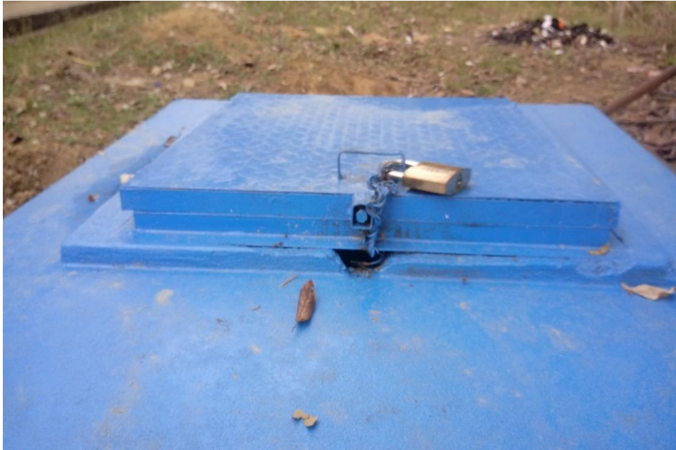
Figura 29. Cámara rompe presión tipo 07 con deficiencias.
