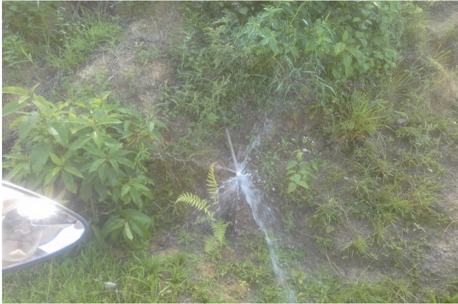
Figura 20. Fugas en la línea de distribución.
