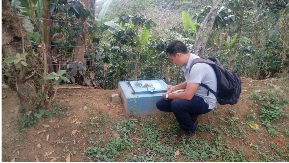
Figura 32. Válvula de purga en red de distribución.
