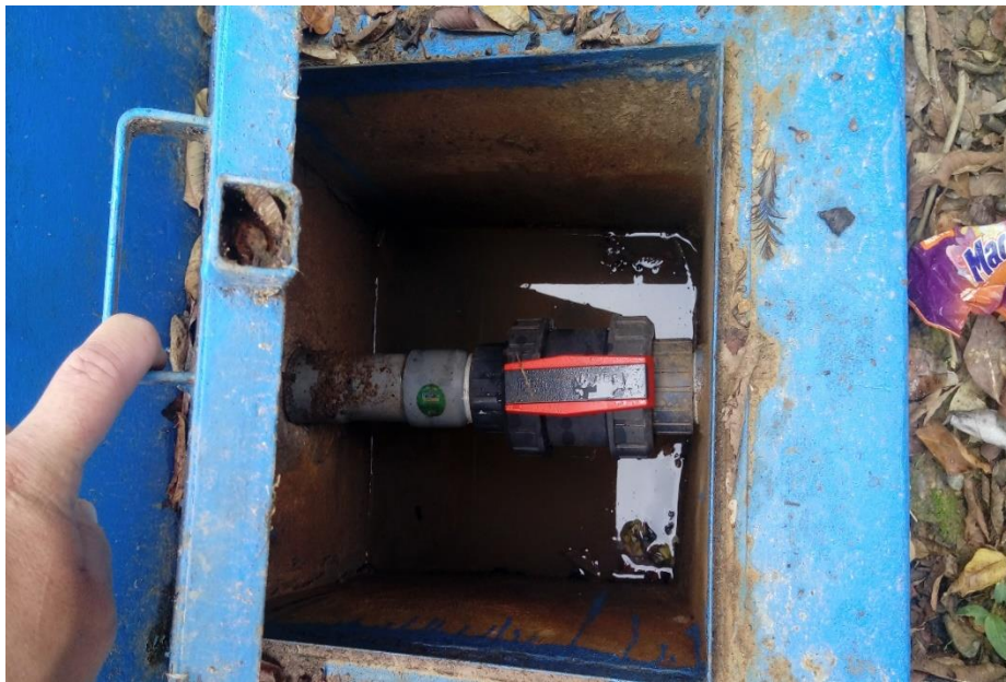
Figura 27. Detalle de llave de control con varias deficiencias.
