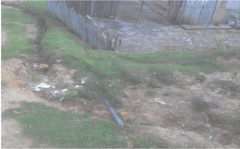
Figura 23. Fugas en tubería expuesta.
