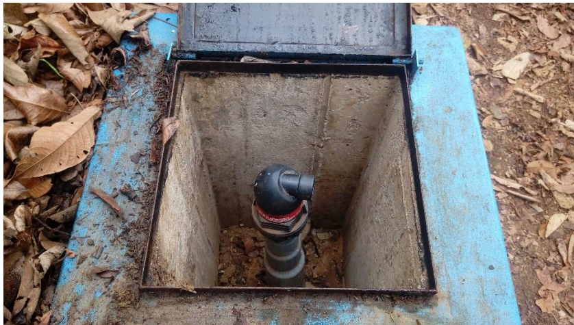
Figura 11. Válvula de aire en línea de conducción.
