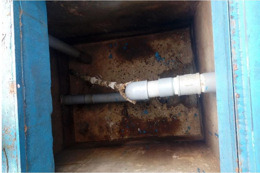
Figura 24. Cámara rompe presión 07 directa, sin boya, ni válvula flotadora.
