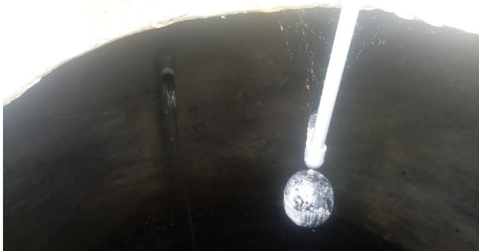
Figura 41. Estado de la boya del reservorio No 1 por cloración deficiente.
