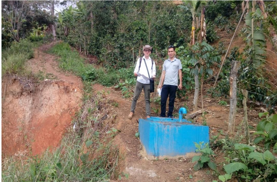
Figura 31. Cámara rompe presión tipo 07 con filtraciones y sin seguridad. Las filtraciones han ocasionado el deslizamiento del terreno.
