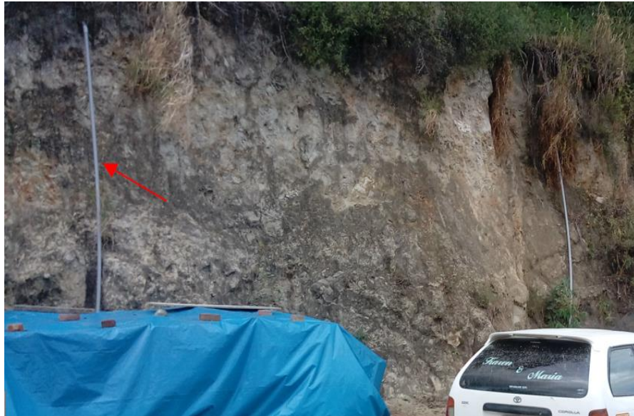
Figura 22. Tubería expuesta por terreno abrupto.
