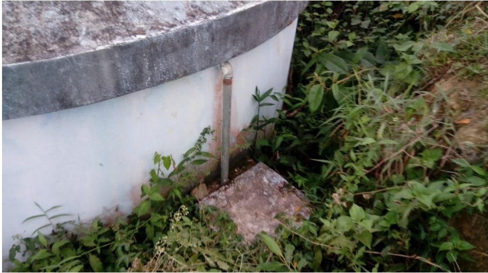
Figura 19. Caja de válvula del reservorio San Miguel.
