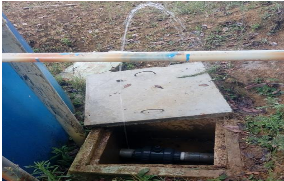
Figura 15. Caja de válvula con perforaciones.
