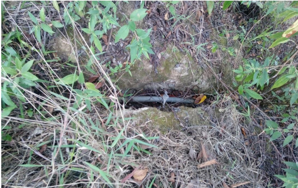
Figura 21. Tubería expuesta en red de distribución.
