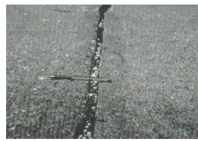
Daño del sello de la junta alta severidad.
