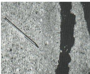
Grieta de durabilidad “D” baja severidad
