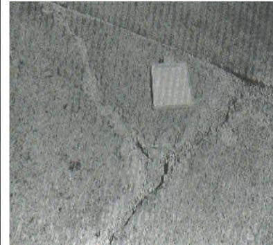
Grieta de esquina de alta severidad.
