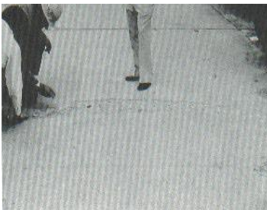
Grieta de durabilidad “D” severidad media
