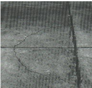
Grieta de esquina de baja severidad.
