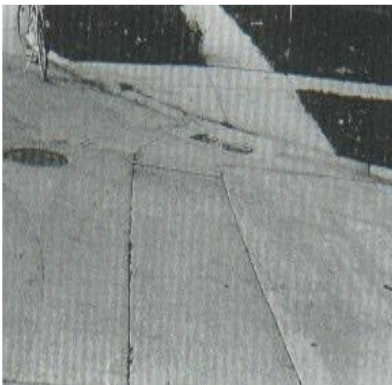
Parche grande y acometidas de servicios públicos de baja severidad
