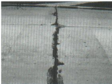
Daño del sello de la junta baja severidad
