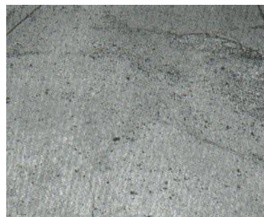
Grieta de durabilidad “D” alta severidad.
