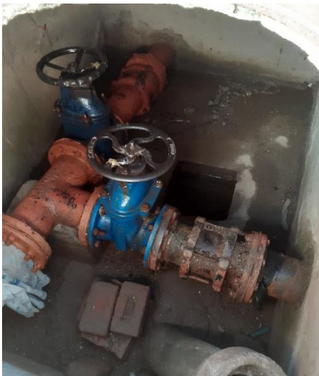
Figura 8: Fuga de agua en válvula que sale de reservorio circular.
