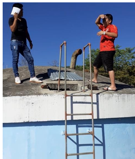
Figura 7: Reservorio circular de 265 metros cúbicos de capacidad.
