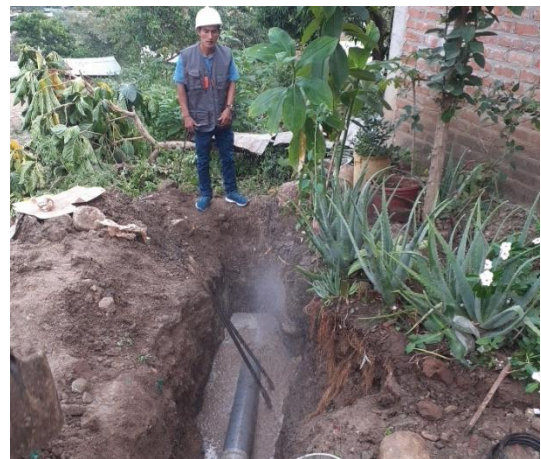
Figura 34: Fuga de agua en tubería.
