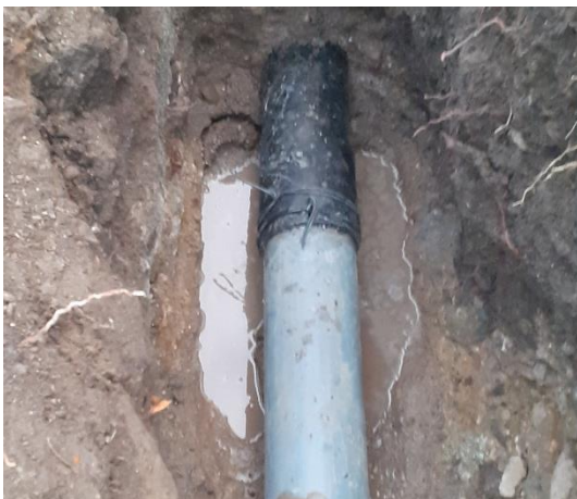
Figura 33: Fuga de agua en tubería.
