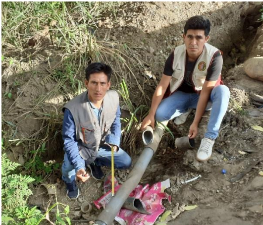
Figura 16: Tubería no reparada de manera correcta.
