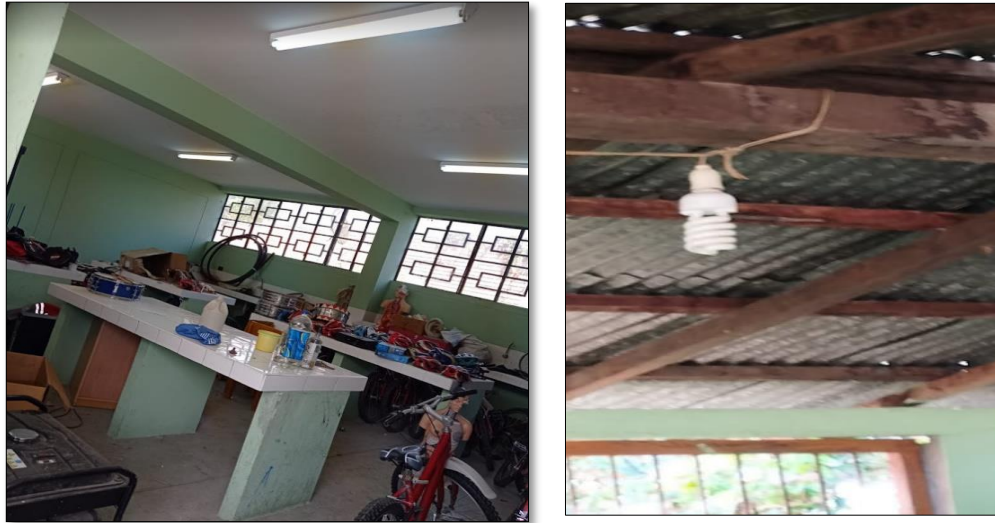
Iluminación con tubo fluorescente y foco ahorrador
