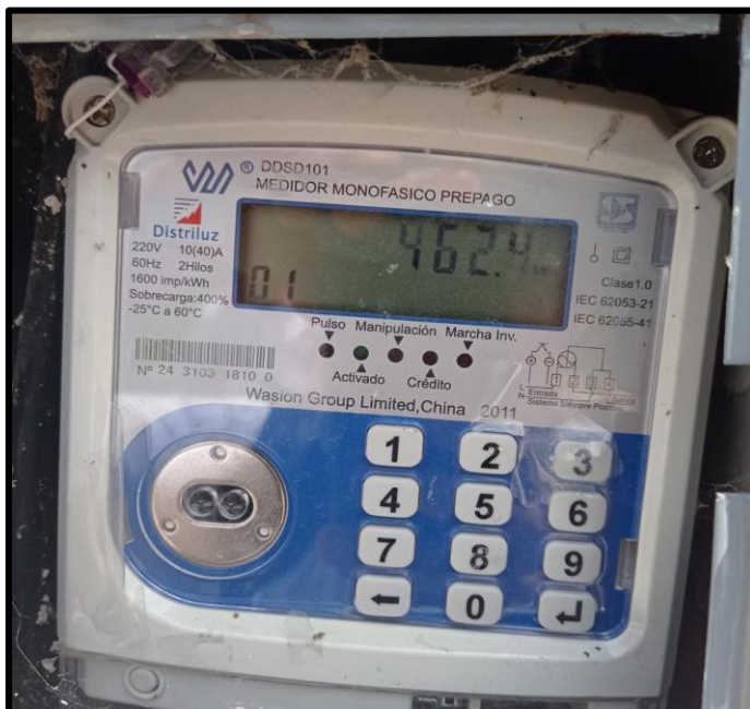
Medidor monofásico prepago de la Institución Educativa José Olaya
