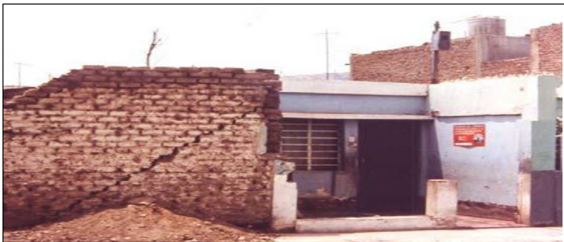
Daño Registrado en una Vivienda por falla de corte de tracción diagonal
