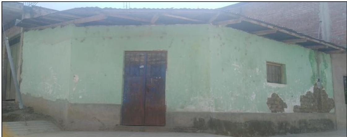
Edificación de Adobe con Presencia de humedad y estado de conservación deteriorado
