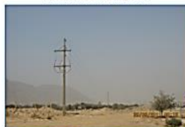
Línea de subtransmisión 22,9 kV
