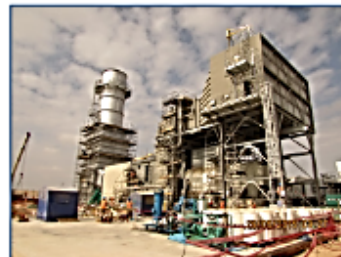
Turbogenerador y equipos auxiliares
