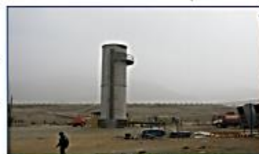
Quemador de biogás
