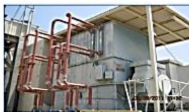
Generador Eléctrico ABB de 30 MW
