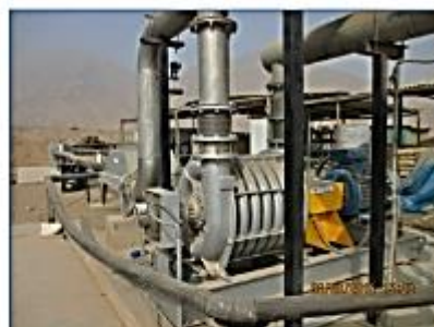
Planta de tratamiento de biogás
