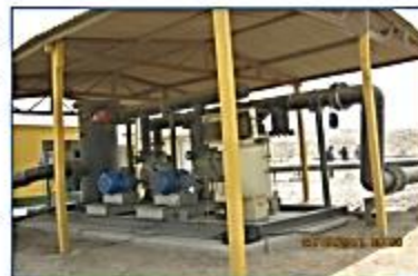
Planta de tratamiento de biogás
