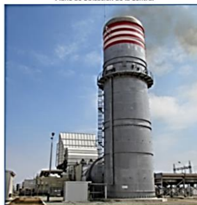
Unidad de generación turbina a gas
