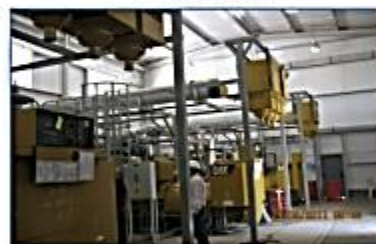
Grupos de Generación 3 x 1,6 MW
