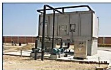
Torre de Enfriamiento de la Planta
