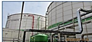
Tanques de almacenamiento de agua
