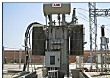
Transformador ABB de 42 MVA 60/13,8 kV
