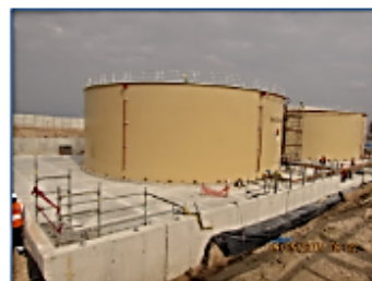
Tanques de almacenamiento de combustible Diésel B5
