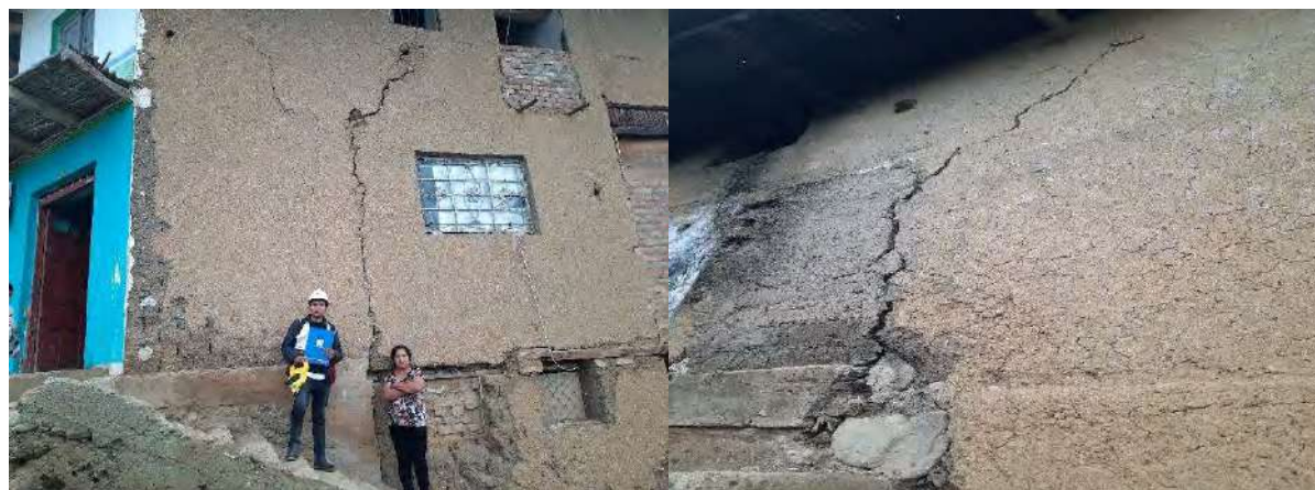
Vivienda de dos niveles, presenta grietas en sus muros.
