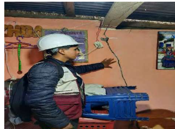
Vivienda N° 23 presenta grietas en sus paredes.
