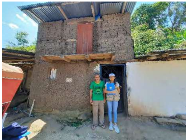
Vivienda N° 25 con vulnerabilidad alta en AV. Francisco Bolognesi.
