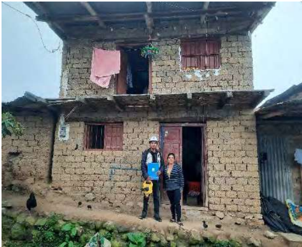
Vivienda de dos niveles con elementos no estructurales mal conectados.
