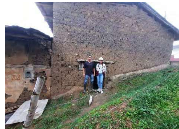
Vivienda N° 24 con vulnerabilidad alta en AV. Francisco Bolognesi.
