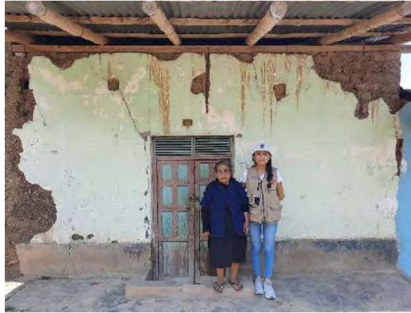
Vivienda N° 28 con vulnerabilidad alta en calle San Martín.
