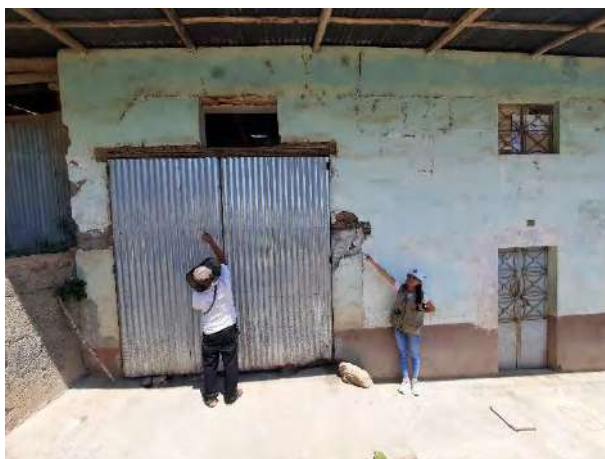
Vivienda N° 21 con vulnerabilidad alta en calle San Martín.
