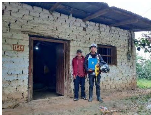
Vivienda N° 11 con vulnerabilidad alta en calle San Martín.
