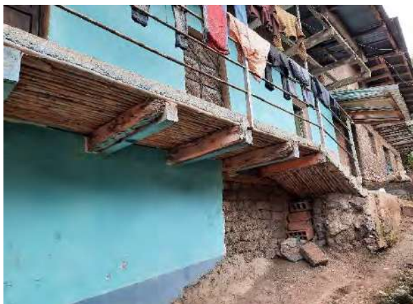
Vivienda de dos niveles en mal estado de conservación.
