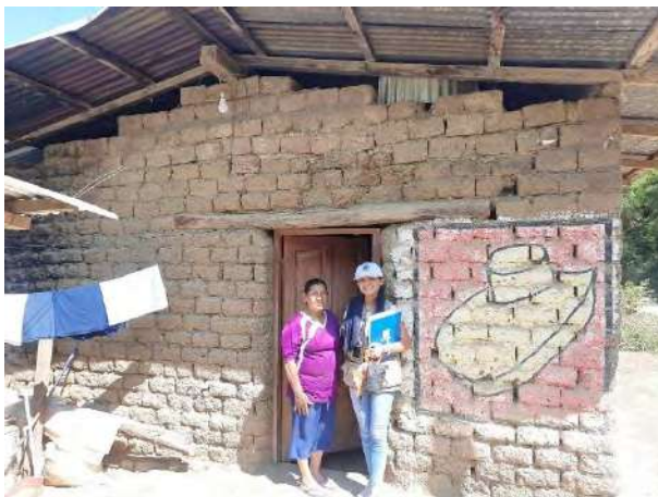
Vivienda N° 44 con vulnerabilidad alta en calle San Martín.
