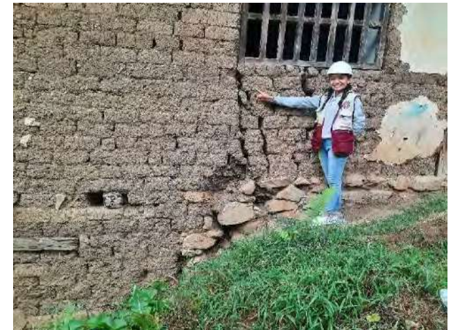
Vivienda de dos niveles con grietas en sus muros.
