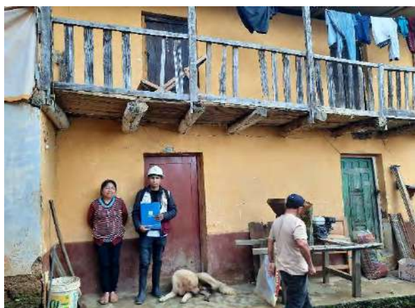
Vivienda con elementos no estructurales en mal estado de conservación.
