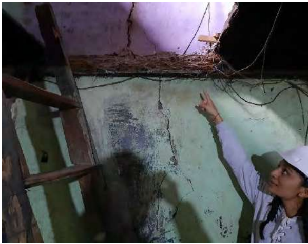
Vivienda en mal estado de conservación con grietas en sus muros.
