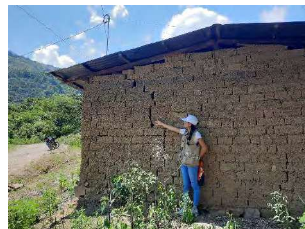
Vivienda N° 12 con vulnerabilidad alta en calle San Martín.
