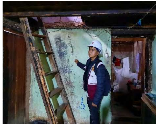
Vivienda N° 24 con vulnerabilidad alta, presenta grietas en sus paredes.
