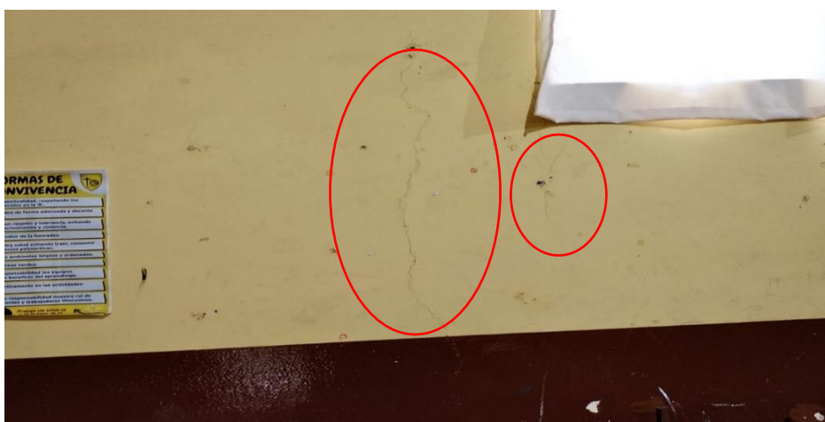
Presencia de fisuras en los muros del Aula 1
