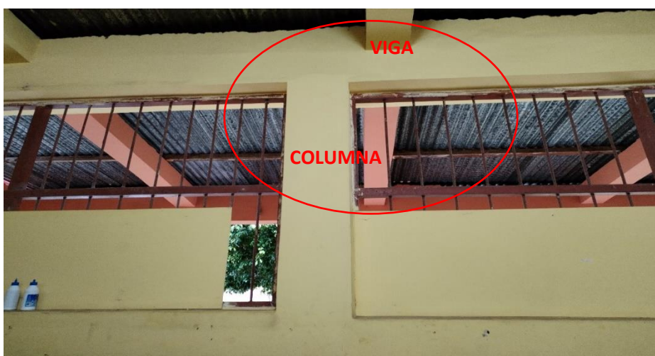
Columnas y vigas no alineadas
