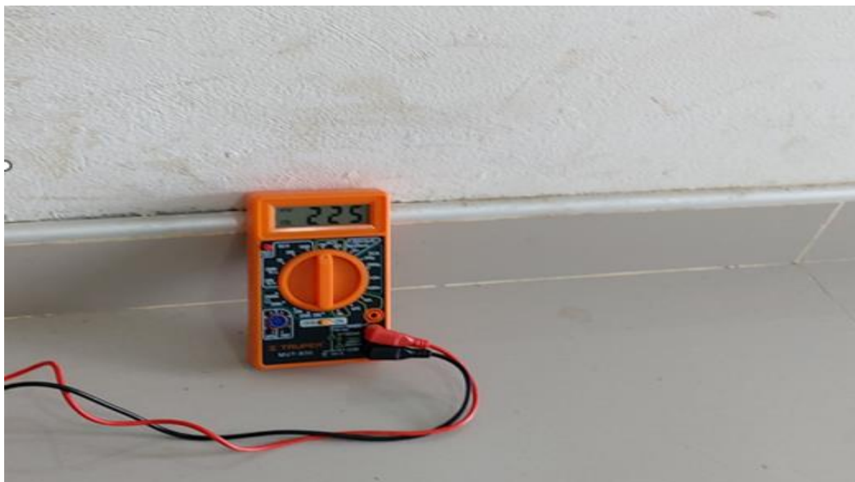
Figura N°54: Realizando el diagnóstico de la tensión en los tomacorrientes con Multitester.
