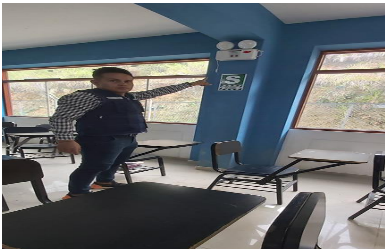
Figura N° 55: Realizando el diagnóstico de la iluminación de emergencia de la I.E.S.
