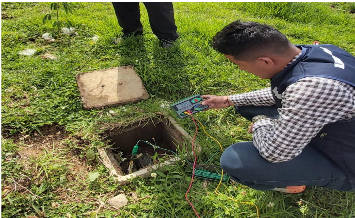
Figura N°53: Resultado de Ohmios del Pozo Tierra utilizando telurómetro.
