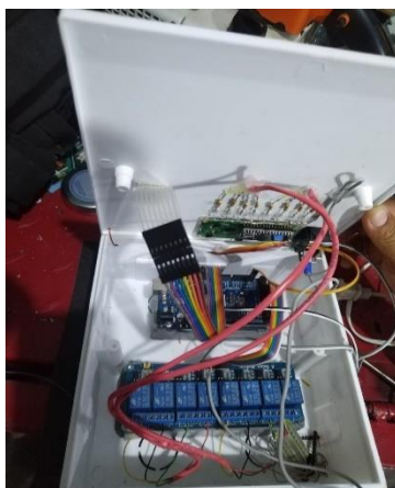
Figura 33. Cableado de los equipos
