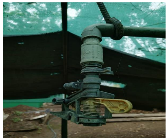
Anexo 7. Sistema de riego automatizado sin funcionamiento
