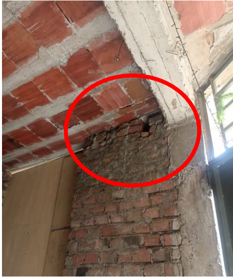
Conexión muro a techo en mal
