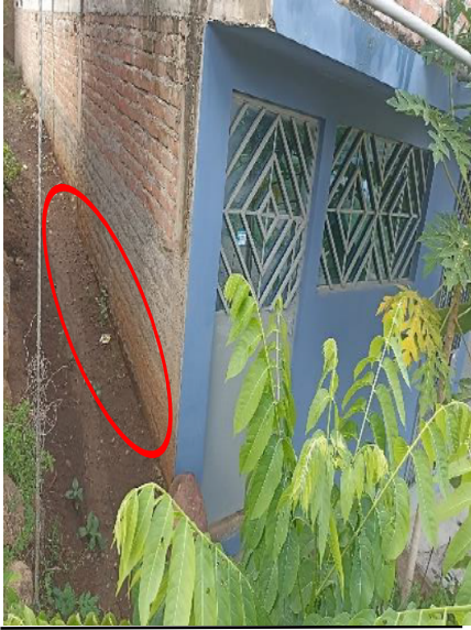
Humedad en muros por filtración en terreno colindante
