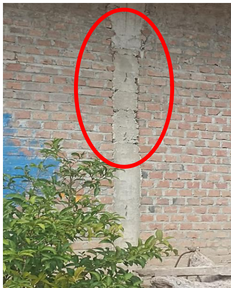
Muro no endentado y sin mechas de conexión con la columna.
