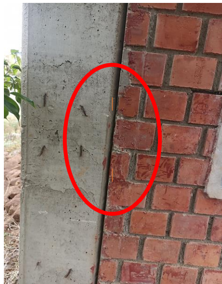
Separación muro-columna y ausencia de junta sísmica
