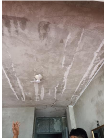
Eflorescencia en el concreto de la losa aligerada
