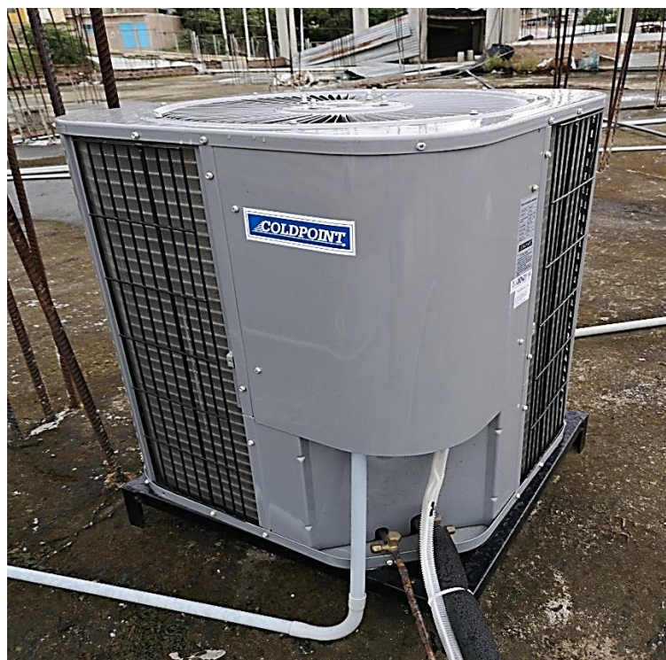
Figura 30. Equipo del sistema de aire acondicionado utilizado en el inventario de equipos.
