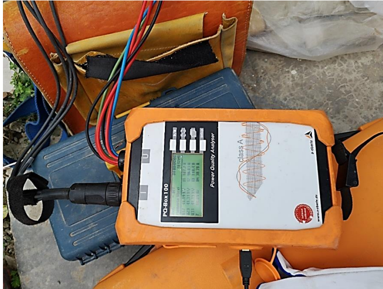
Figura 25. Toma de datos de la potencia y consumo de energía eléctrica.
