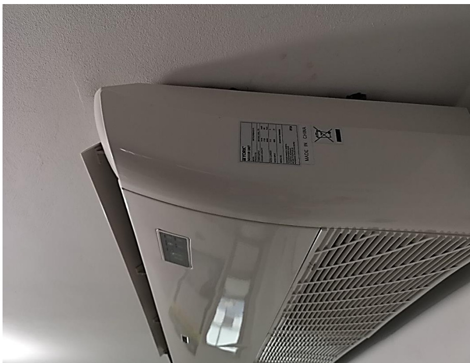
Figura 29. Split de aire acondicionado utilizado en el inventario de equipos.
