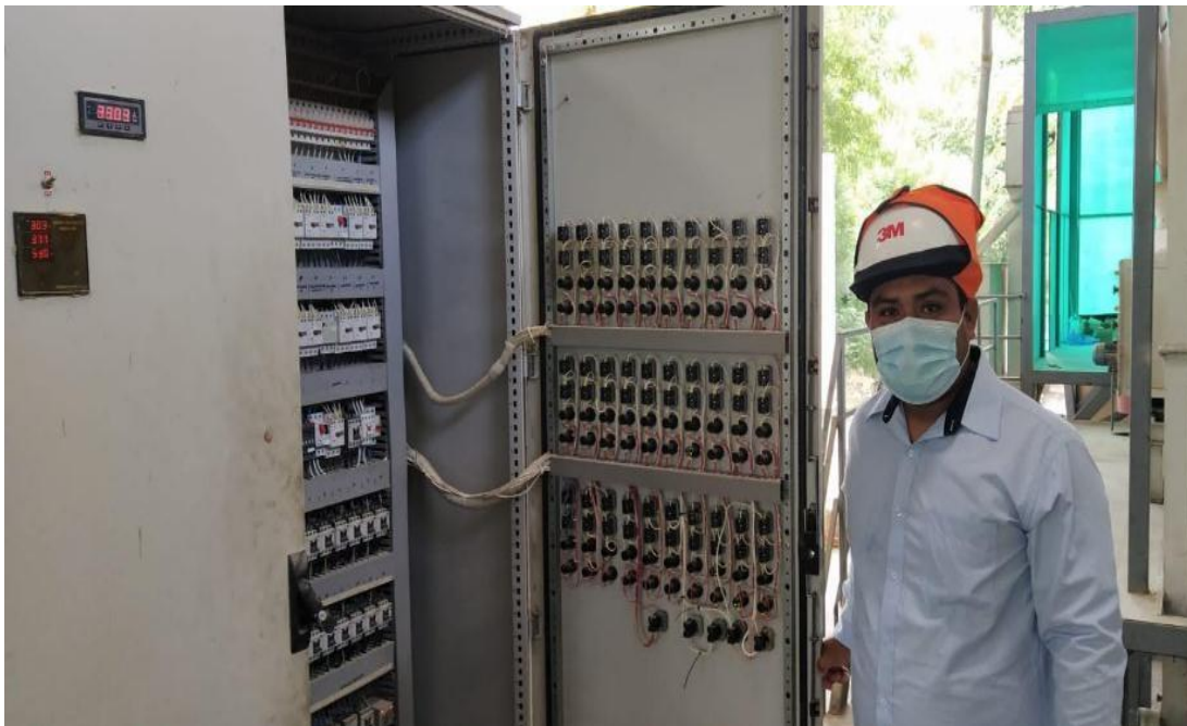
Nota. Tesista verificando tablero eléctrico de control.
