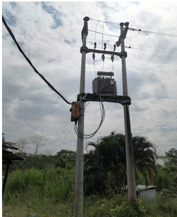
FOTO N°: 02 Subestación de 250 kVA 22.9/0.40-0.23 kV que suministra energía eléctrica a la empresa
