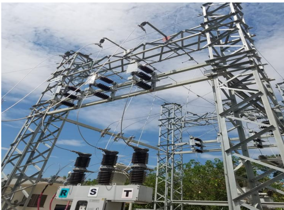
Figura 29. Barra de 22,9 kV de la subestación Nueva Jaén
