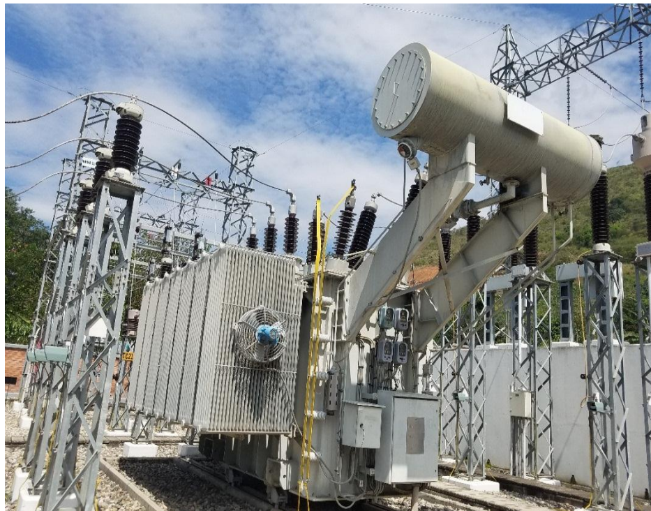
Figura 30. Transformador de potencia de 20 MVA.
