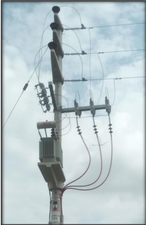
Transformados trifasico de 75 KVA
