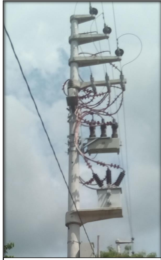
Estructura del Recloser y Trafomix
