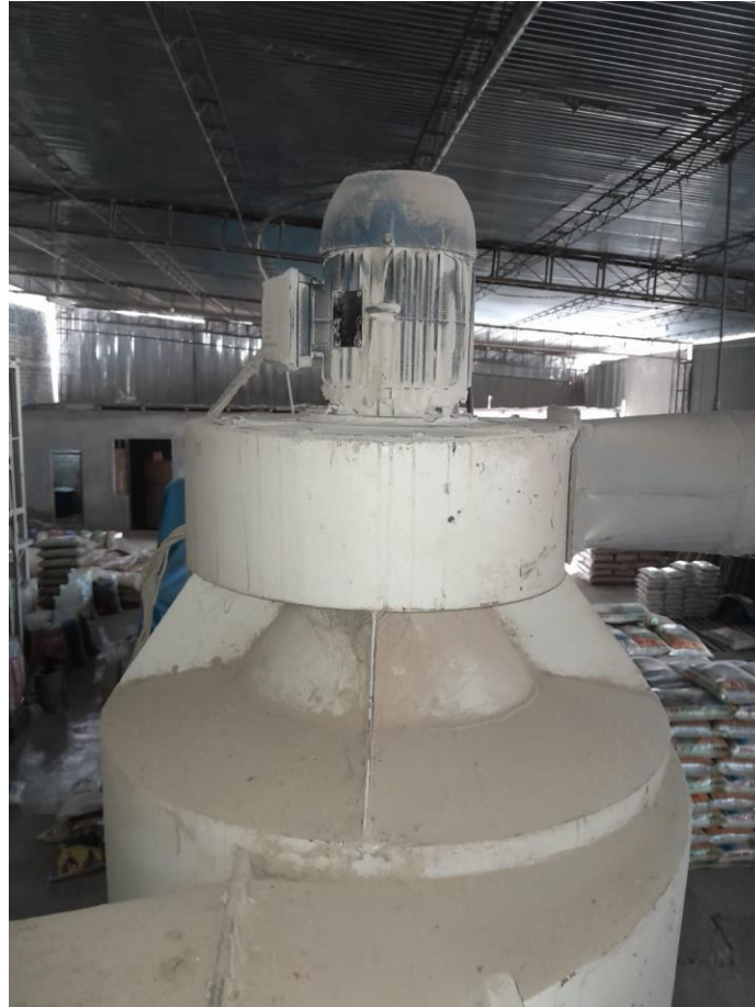
Motor WEG 7.5 HP instalado en la planta industrial
