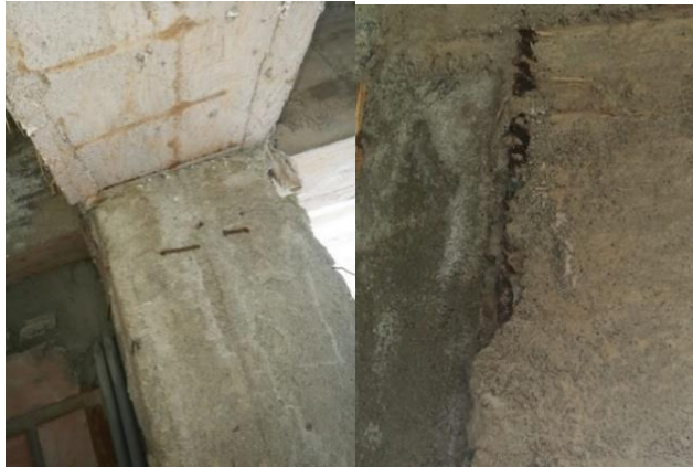
Figura 6. Vigas y columnas sin recubrimiento
