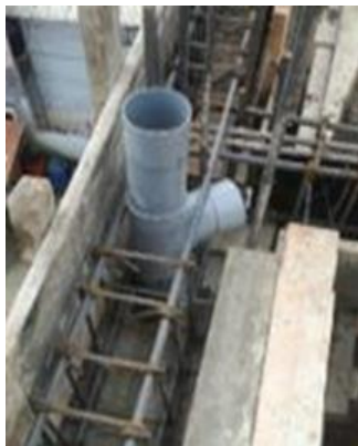
Figura 1. Tuberías en vigas
