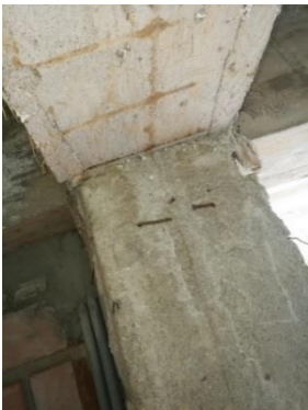
Figura 18. Estribos Sin Recubrimiento
