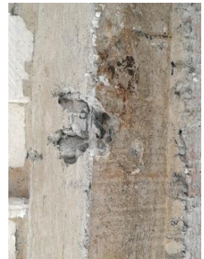
Figura 20. cangrejas en Vigas
