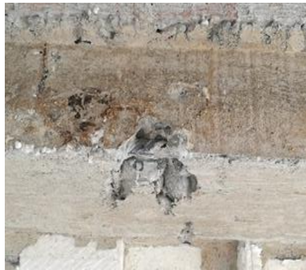
Figura 2. Cangrejas en vigas
