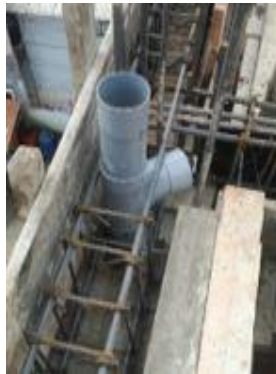
Figura 19. Tubería por Vigas Principales
