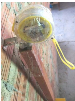
Figura 9. Muros sin plomar
