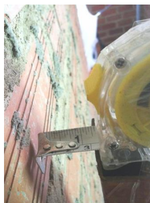
Figura 10. Muros sin plomar
