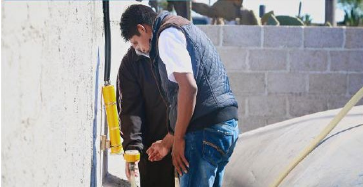
Filtro de biogás ( H_2S )
