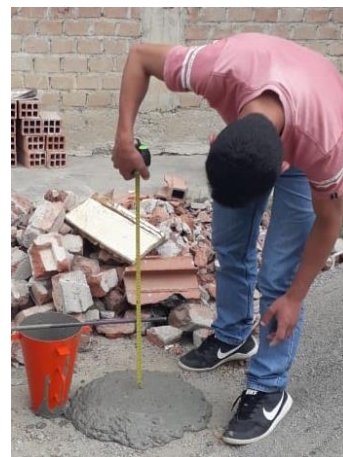
Figura 34. Asentamiento del concreto en construcción informal 01
