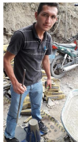
Figura 47. Asentamiento del concreto en construcción informal 03
