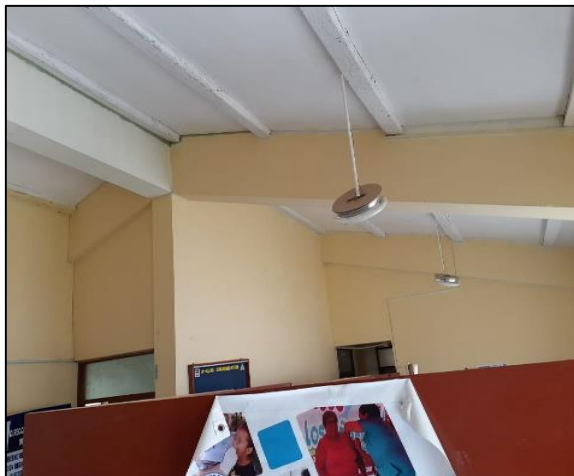
Figura 65. Conexión entre el diafragma y elemento estructural deficiente.
