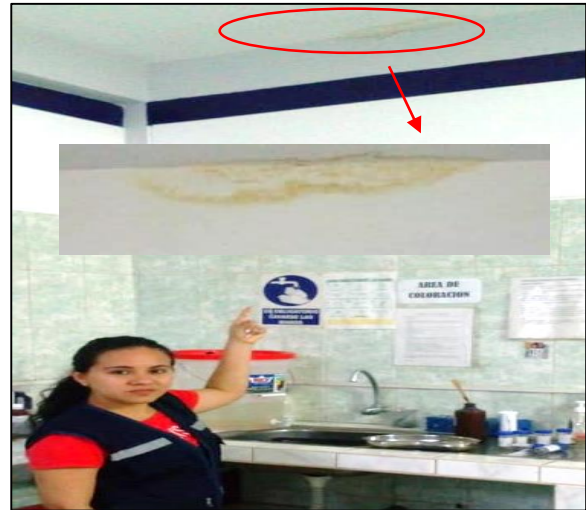
Figura 39. Filtraciones en losa aligerada a causa de la acumulación de agua de lluvias.
