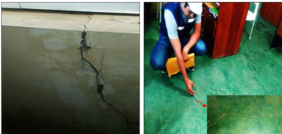
Figura 56. Deterioro del muro a causa del agrietamiento.
