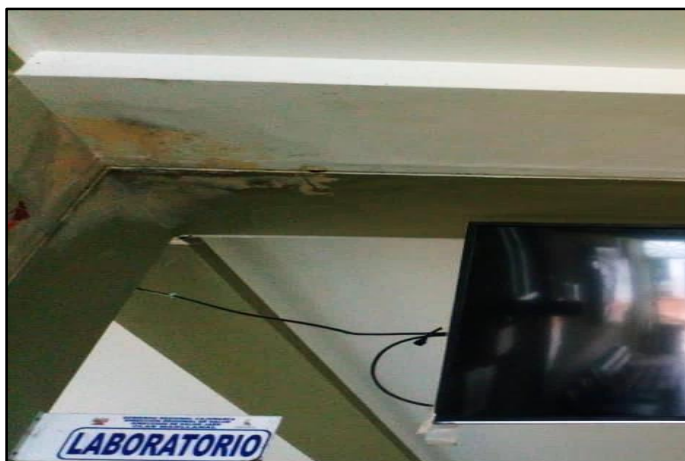
Figura 5. Existe gran humedad en la parte superior de la columna en unión con la losa.
