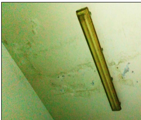
Figura 58. Desprendimiento del material tarrajeo de losa a causa de filtraciones de agua.
