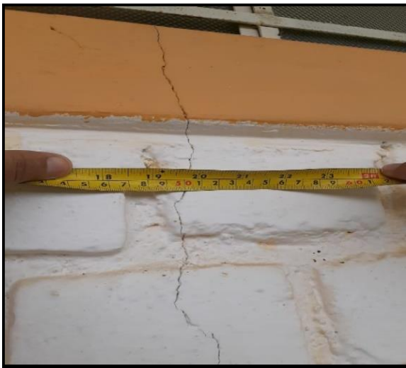
Figura 73. Fisuramiento en el muro de la edificación.
