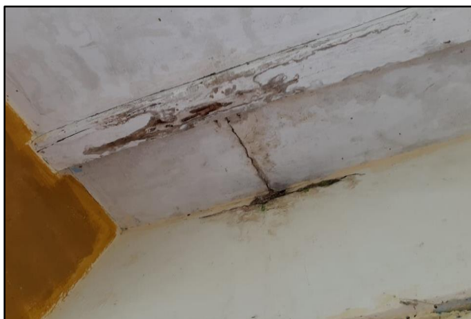
Figura 6. Las vigas de madera y la losa están en mal estado debido a las filtraciones que existe.
