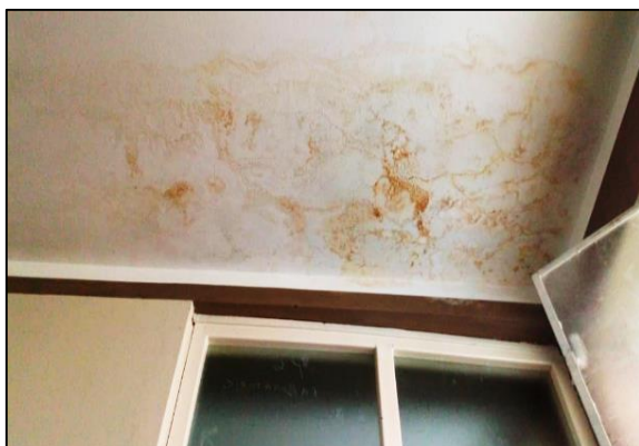
Figura 27. Filtración de agua en la losa de las edificaciones.
