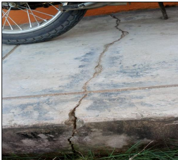
Figura 39. Agrietamiento de vereda por falta de junta de dilatación.
