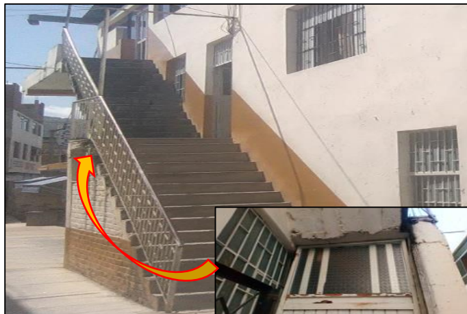
Figura 52. Conexión deficiente de la escalera con sus elementos estructurales y contrapasos que sobrepasan la altura máxima.
