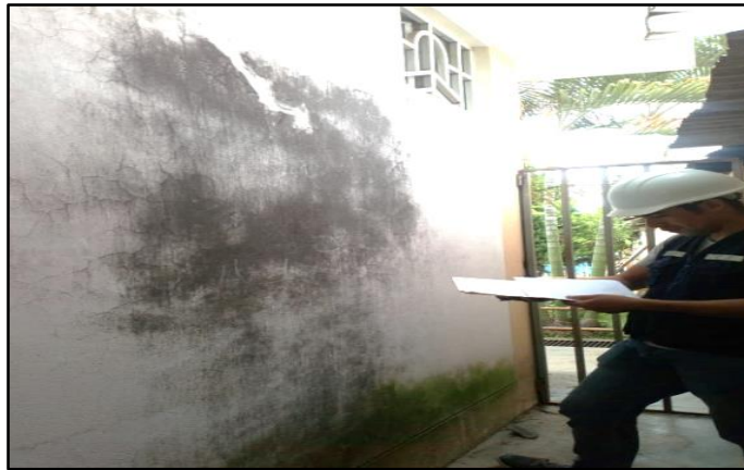
Figura 7. Gran humedad que afecta al muro de ladrillo.
