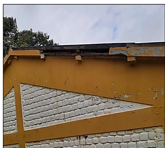
Figura 76. Desprendimiento de cubierta.
