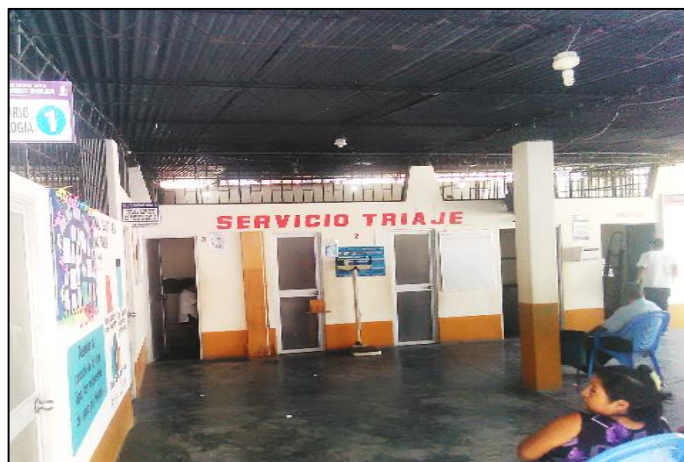
Figura 50. Módulo que no cuenta con diafragma.
