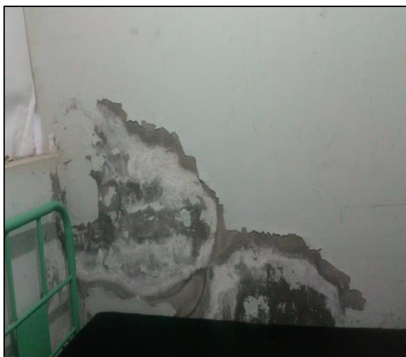
Figura 60. Deterioro de muro por humedad exterior.
