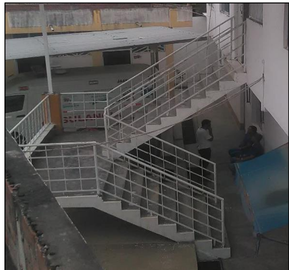
Figura 26. Escalera sin una buena conexión.
