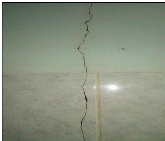
Figura 59. Se observa que el acabado de cerámico ha sido afectado por la grieta transversal.
