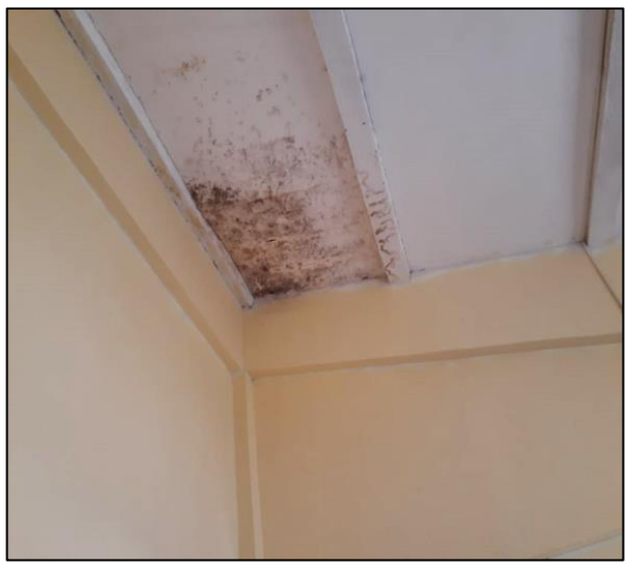
Figura 74. Humedad debido a filtraciones
