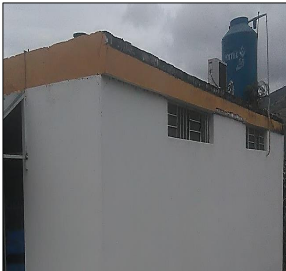
Figura 25. Tanque elevado que no se encuentra conectado al sistema resistente
