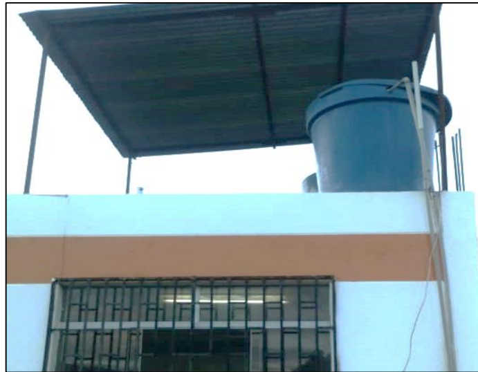
Figura 37. Tanque elevado mal conectado.
