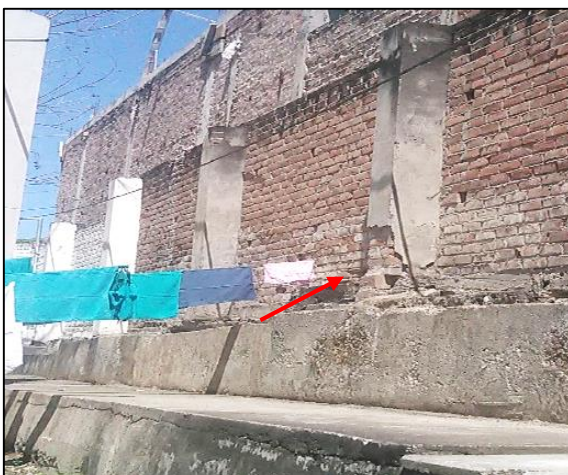
Figura 116. Cerco perimétrico sin diseño estructural.
