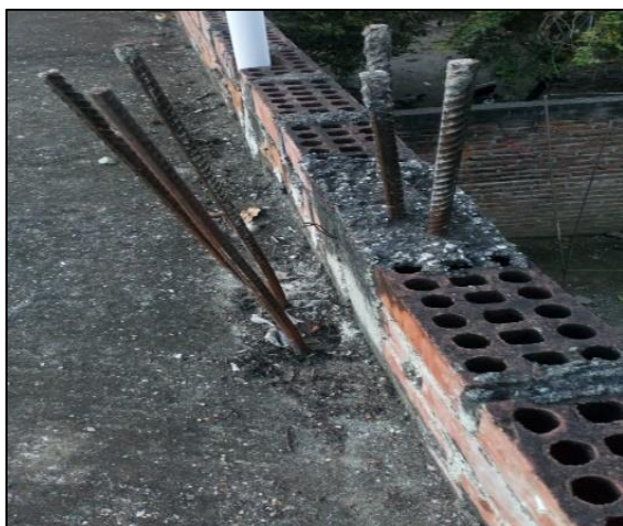
Figura 106. Deficiente o falta de vaciado de columna en parapeto.
