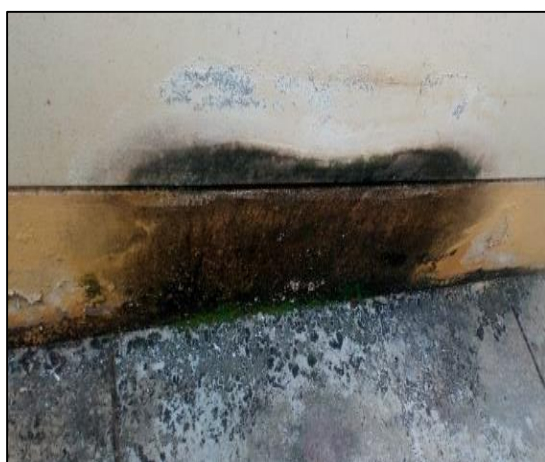
Figura 29. Gran humedad en la parte inferior de la edificación.
