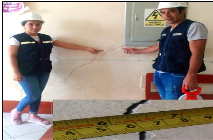
Figura 8. Grietas de 3mm de abertura en muros de la edificación.
