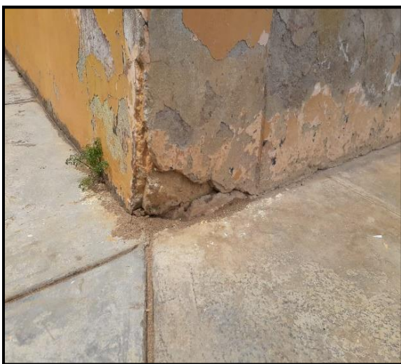
Figura 75. Desprendimiento de recubrimiento en columna.
