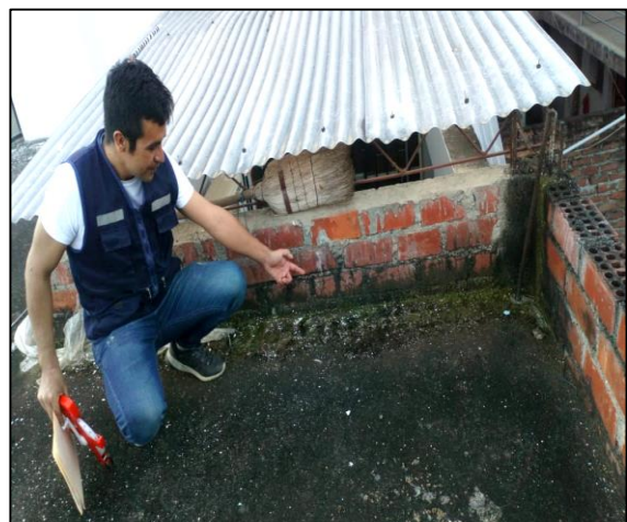
Figura 105. Hongos almacenados a causa de lluvia, que ocasionan filtraciones en los ambiente
