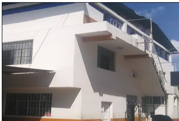
Figura 53. Parapeto deficiente con altura de 60cm de altura y sin barandas de protección.
