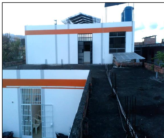
Figura 107. Configuración en elevación deficiente.
