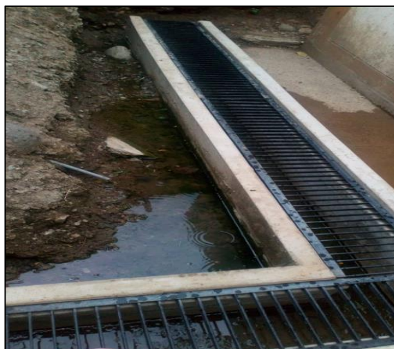
Figura 61. Humedad constante por afloramiento de agua en la parte exterior de las edificaciones.
