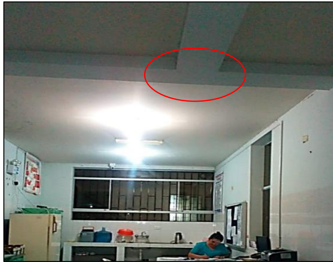
Figura 51. El sistema de diafragmas horizontales se encuentre mal conectado al sistema resistente vertical por falta de un elemento vertical.
