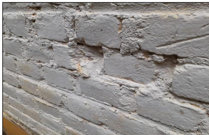
Figura 69. Muro con deficiencias en el asentado de ladrillo.
