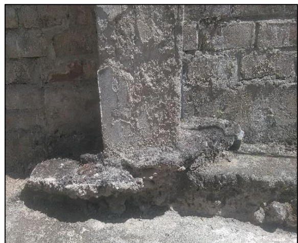
Figura 117. Estructuras en mal estado en cerco perimétrico.
