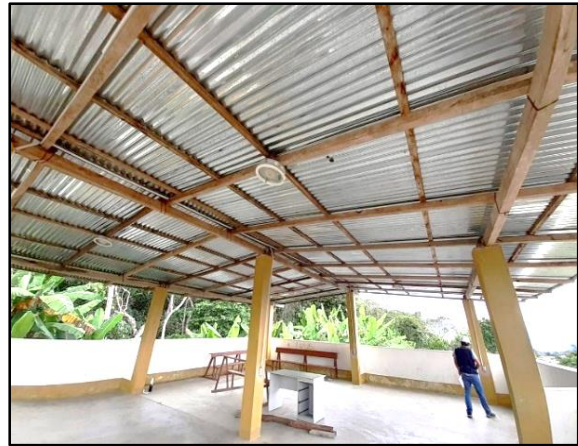
Figura 12. Cubierta de calamina y vigas de madera.
