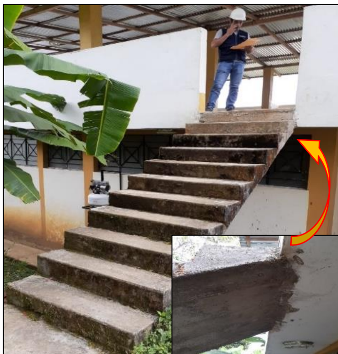
Figura 70. Escaleras que no cuenta con elementos de apoyo estructural, ni barandas de seguridad.
