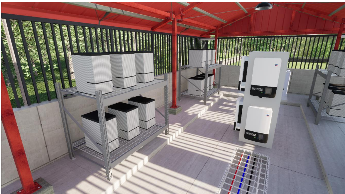
Vista lateral izquierda del interior del cuarto de máquinas.
