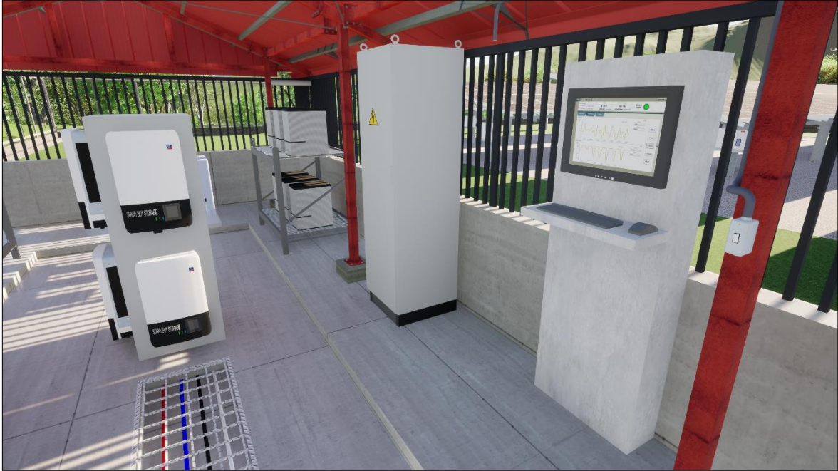
Vista lateral derecho del interior del cuarto de máquinas.
