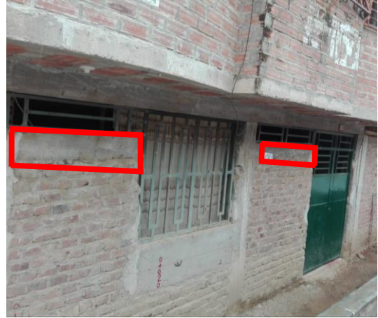
Figura 20. Discontinuidad de vigas de confinamiento observado en vivienda ubicada en la Calle Los Incas N° 165.
