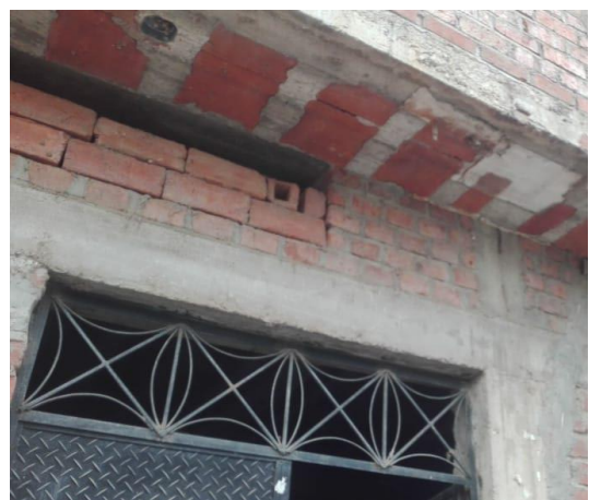
Figura 30. Materiales ubicados de manera incorrecta observados en vivienda ubicada en la calle Unión S/N.
