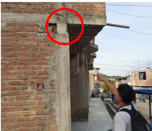
Figura 17. Mal recubrimiento observado en columna de vivienda ubicada en la calle Los Incas N° 165.
