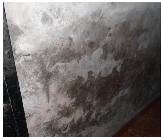
Figura 26. Humedad en pared observada en vivienda ubicada en la calle San José Obrero N° 227.
