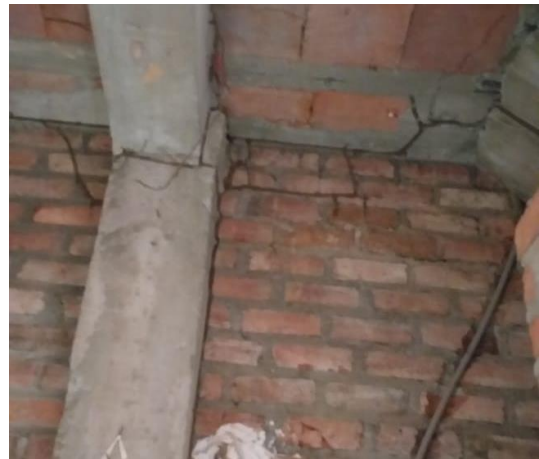
Figura 28. Sección de columnas y vigas diferentes observado en vivienda ubicada en la calle Los Chasquis S/n Cuadra N° 2
