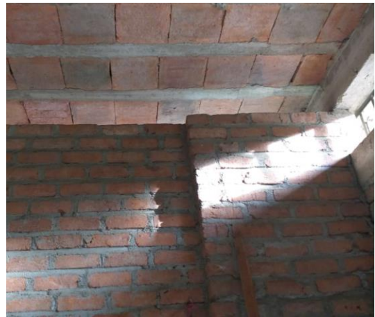
Figura 24. Nula conexión entre muro – losa aligerada observada en vivienda ubicada en la calle Los Incas N° 565.
