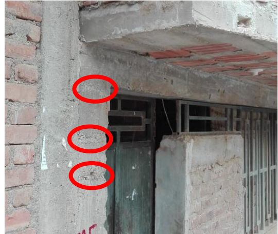
Figura 16. Cangrejas observadas en columna de vivienda ubicada en la calle Los Chasquis S/N cuadra 02
