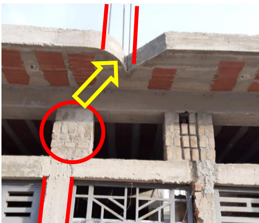
Figura 21. Discontinuidad de columnas observado en vivienda ubicada en la calle Los Chasquis N° 410.
