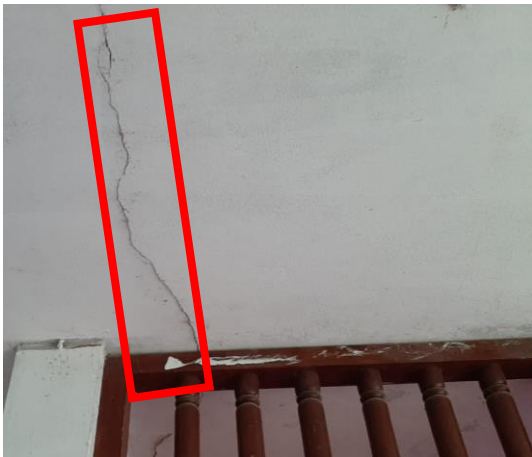
Figura 11. Fisura observada en losa aligerada de vivienda de la calle San José Obrero N° 305.
