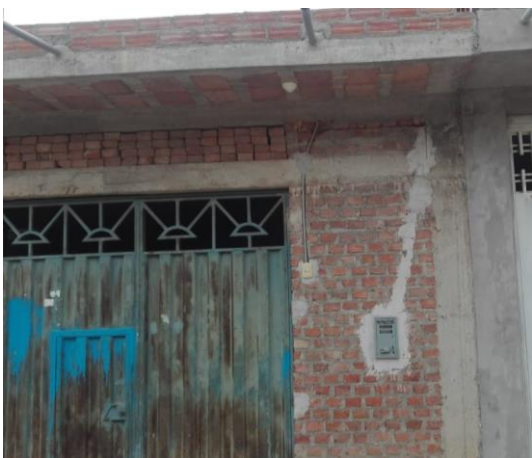
Figura 29. Materiales ubicados de manera incorrecta observados en vivienda ubicada en la calle Los Incas N° 165.
