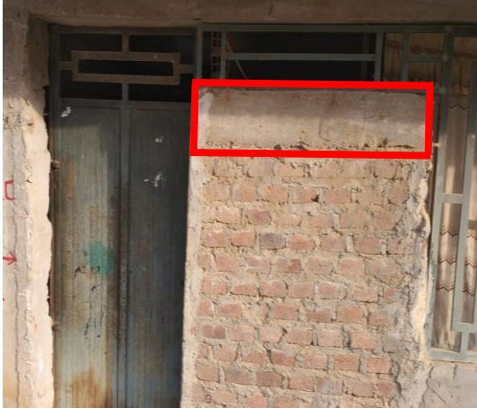
Figura 19. Discontinuidad de vigas de confinamiento observado en vivienda ubicada en la calle Salazar Bondy S/N cuadra 5.
