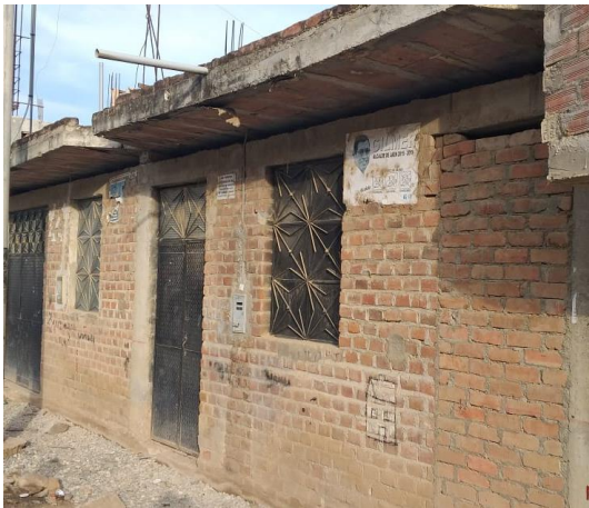
Figura 23. Nula conexión entre viga - losa aligerada observada en vivienda ubicada en la calle Los Romerillos N° 340.
