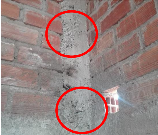
Figura 15. Cangrejas observadas en columna de vivienda ubicada en la calle Río Cunia N° 110.
