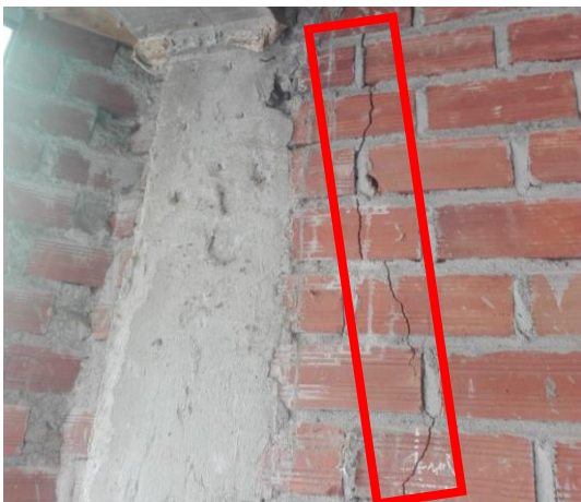
Figura 13. Grieta observada en pared de vivienda ubicada en la calle Los Incas N° 572.
