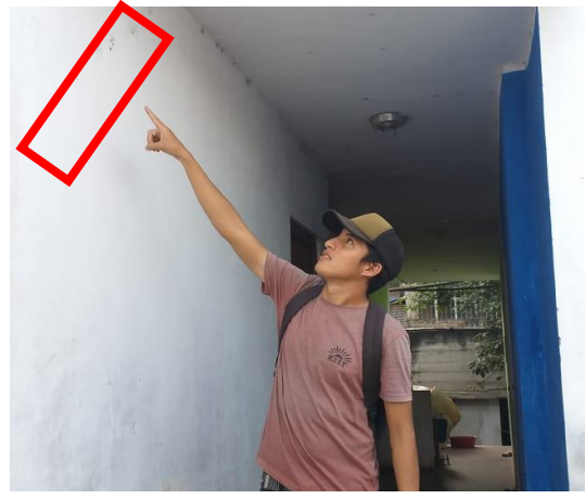
Figura 14. Fisura observada en pared de vivienda ubicada en la calle Los Chasquis S/N Cuadra 03.
