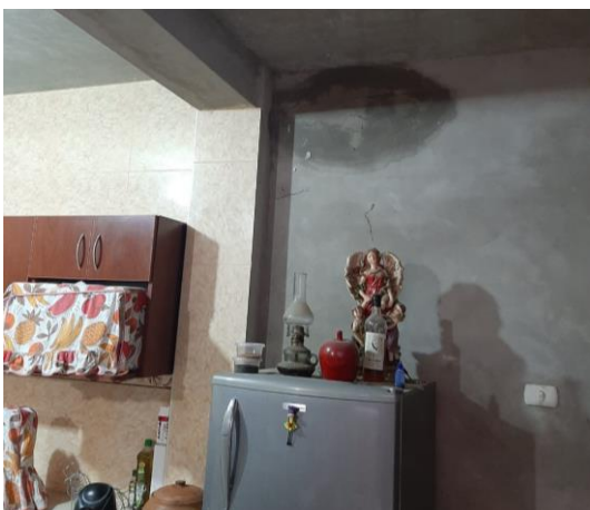
Figura 25. Humedad en pared observada en vivienda ubicada en la calle Vista alegre N° 107
