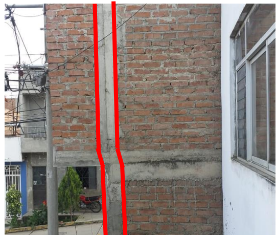
Figura 22. Discontinuidad de columnas observado en vivienda ubicada en la calle Los Acerillos S/N cuadra 02.
