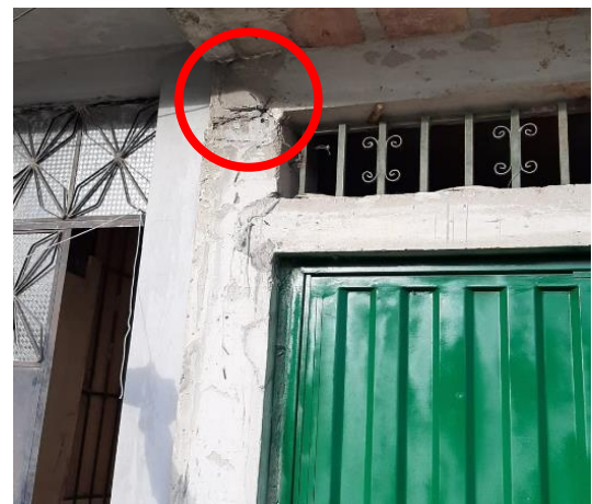
Figura 18. Mal recubrimiento observado en columna de vivienda ubicada en la calle San José Obrero N° 305
