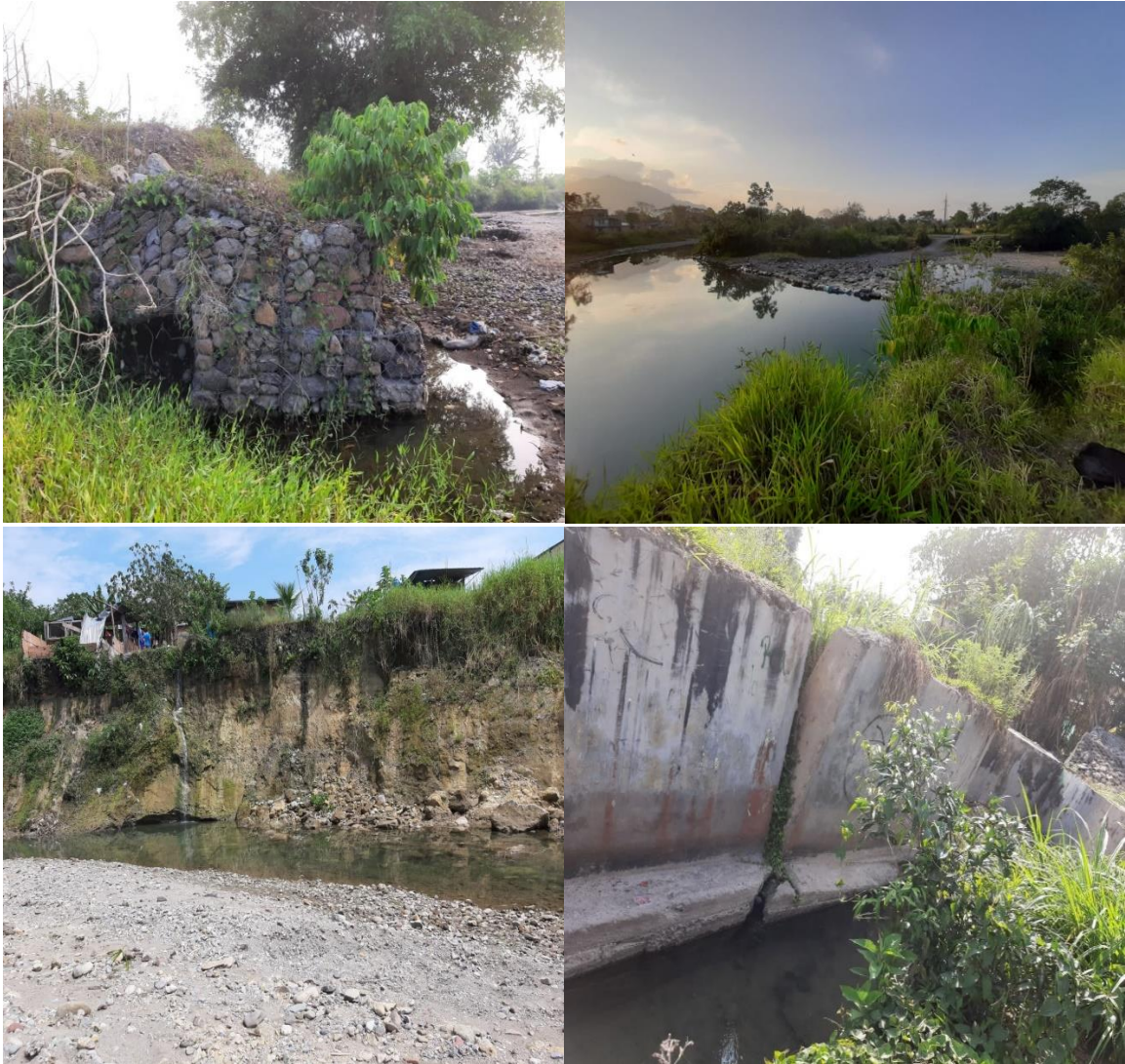
Anexo: 30. Obras de arte en mal estado y viviendas por colapsar debido su imprudencia y a al cauce que erosiona el suelo
