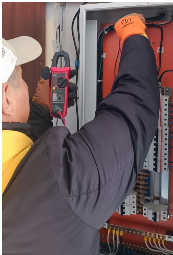
Figura 7 Medición eléctrica directa con pinza amperimétrica sobre conductores principales en tableros eléctricos
