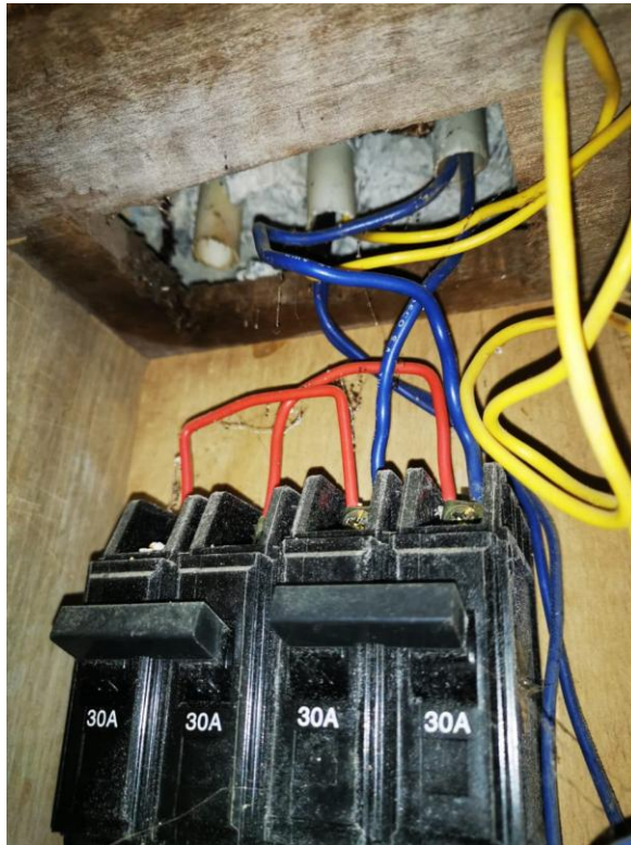
Figura 8 Estado físico de tablero eléctrico
