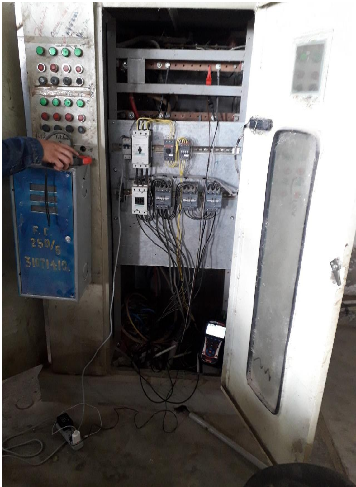
Figura 32. Instalación completa del analizador de redes Fuente: Elaboración propia.
