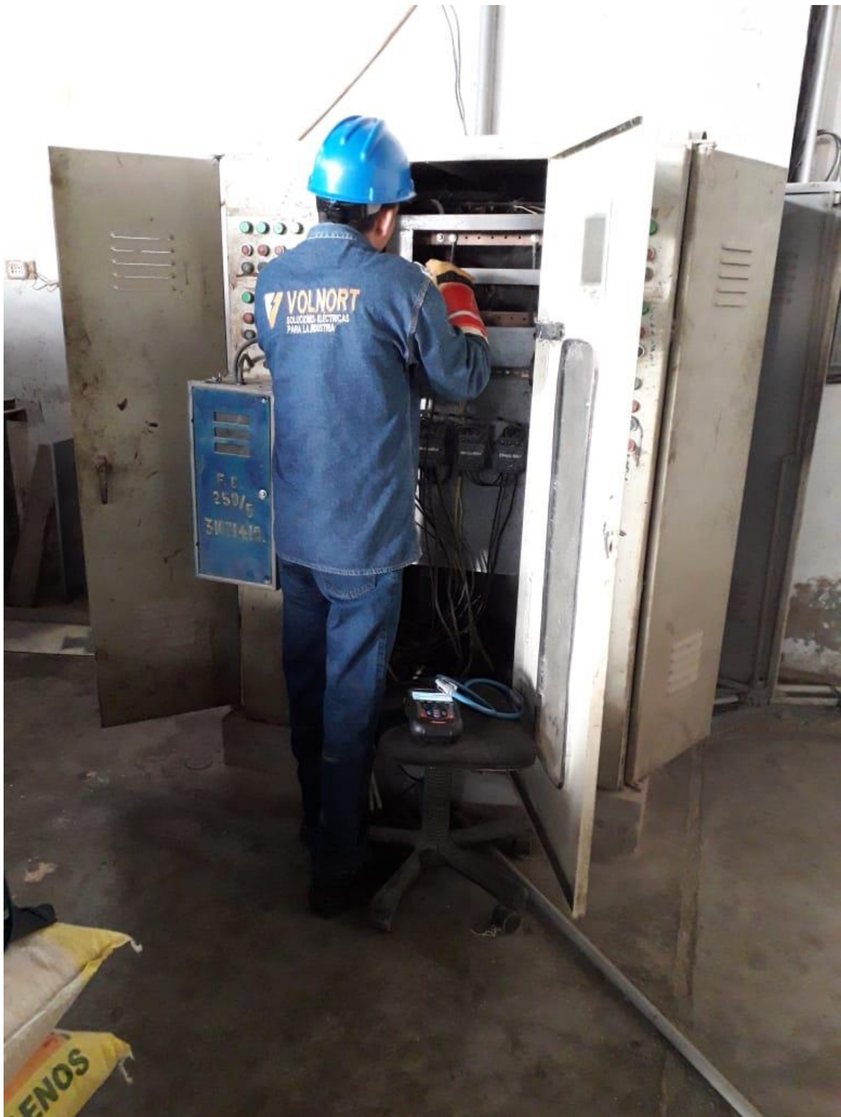
Figura 31. Instalación inicial del analizador de redes Fuente: Elaboración propia.
