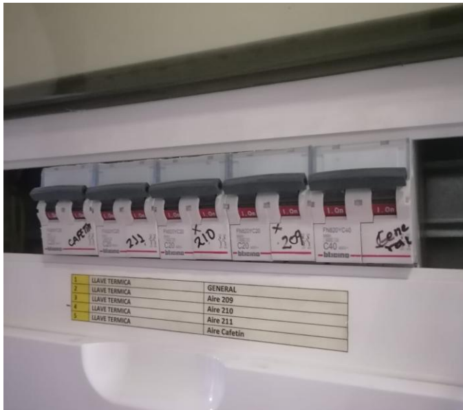
a) Tableros de control del segundo piso (TD-03, TD-04)
