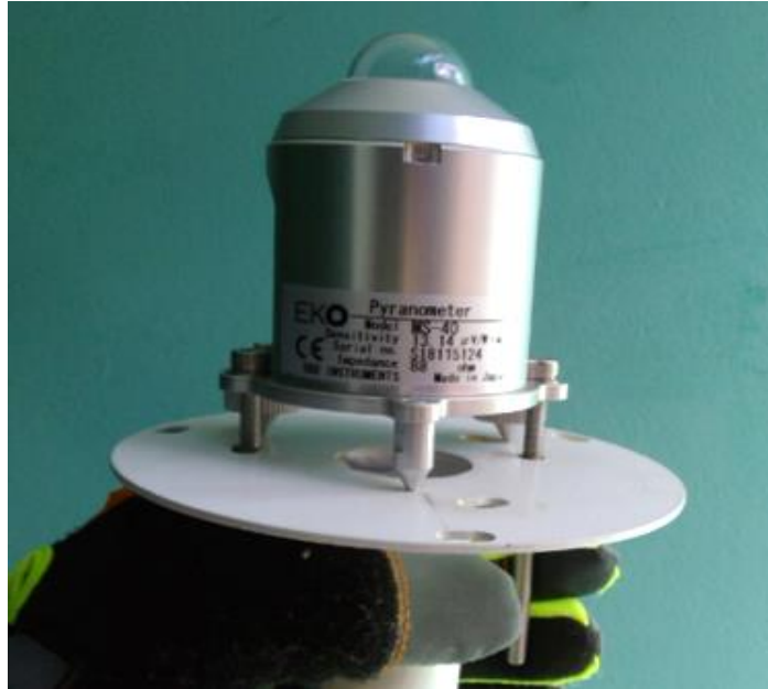
Figura 29. Instalación en base metálica de piranómetro.
