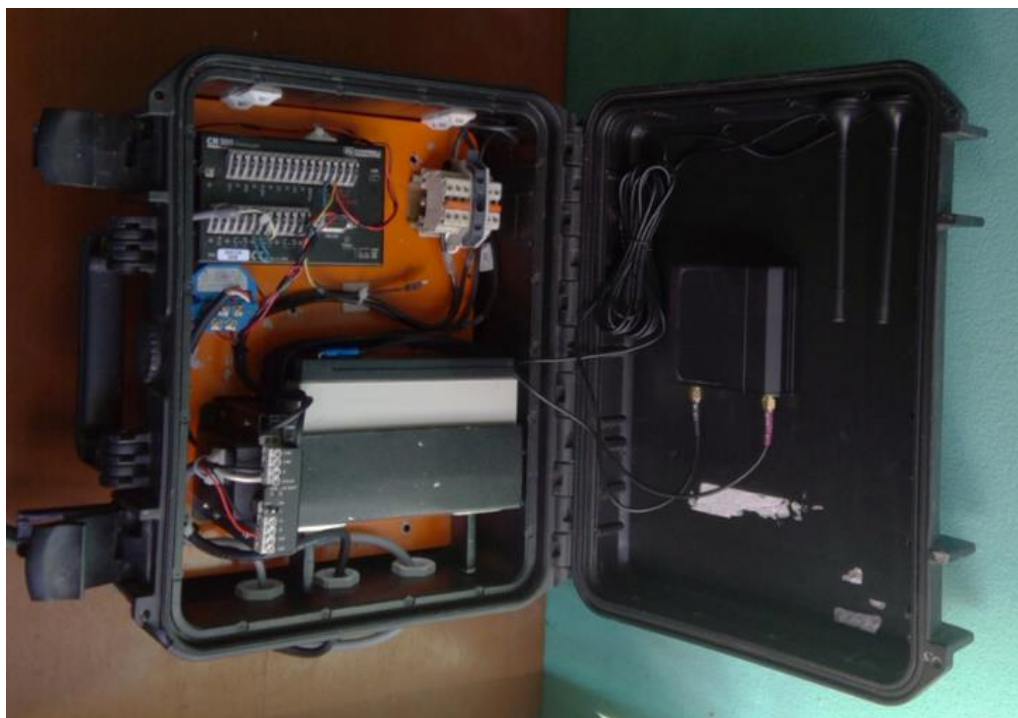
Figura 32. Caja de equipos de automatización y telemetría, resistente para exteriores.
