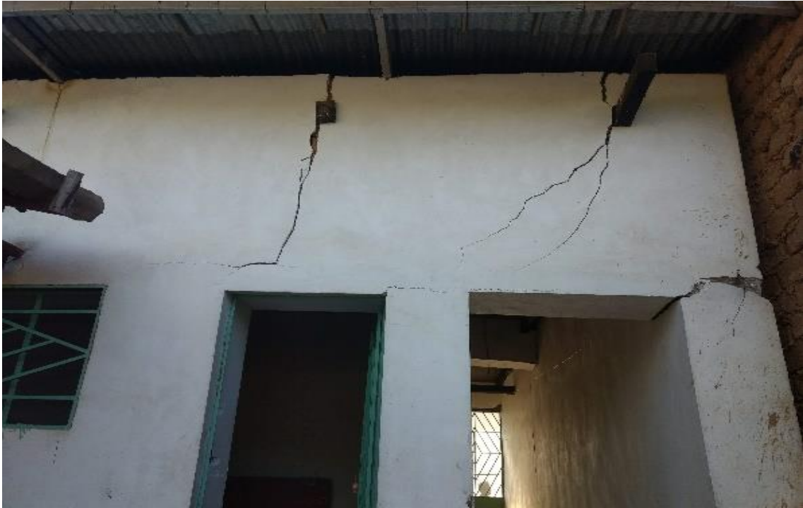
Fotografía 39: Vivienda N°12, grietas verticales y diagonales
