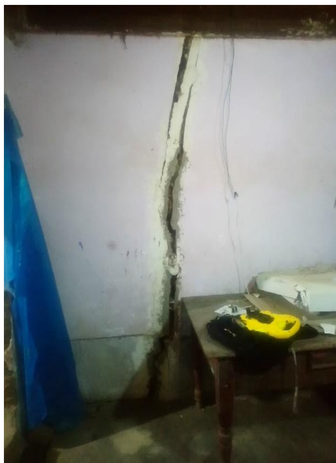
Fotografía 26: Vivienda N° 06, grieta vertical
