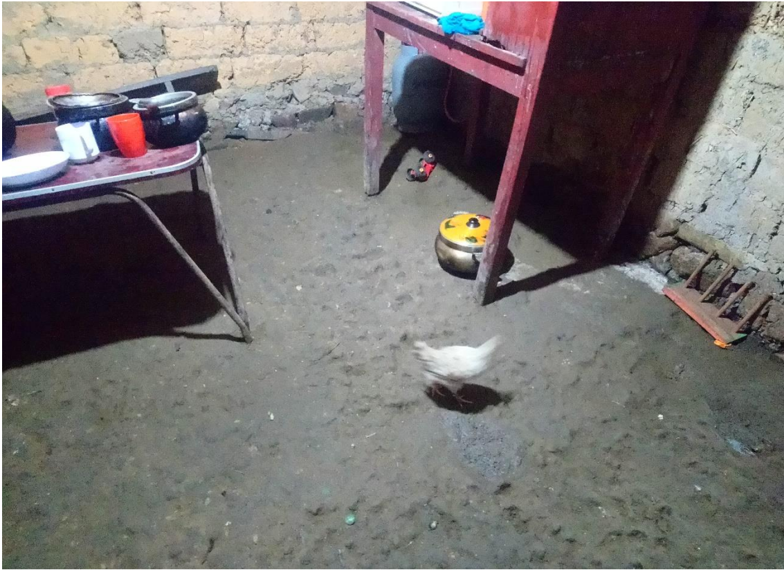
Fotografía 35: Vivienda N° 08, Humedad en el suelo y muro.
