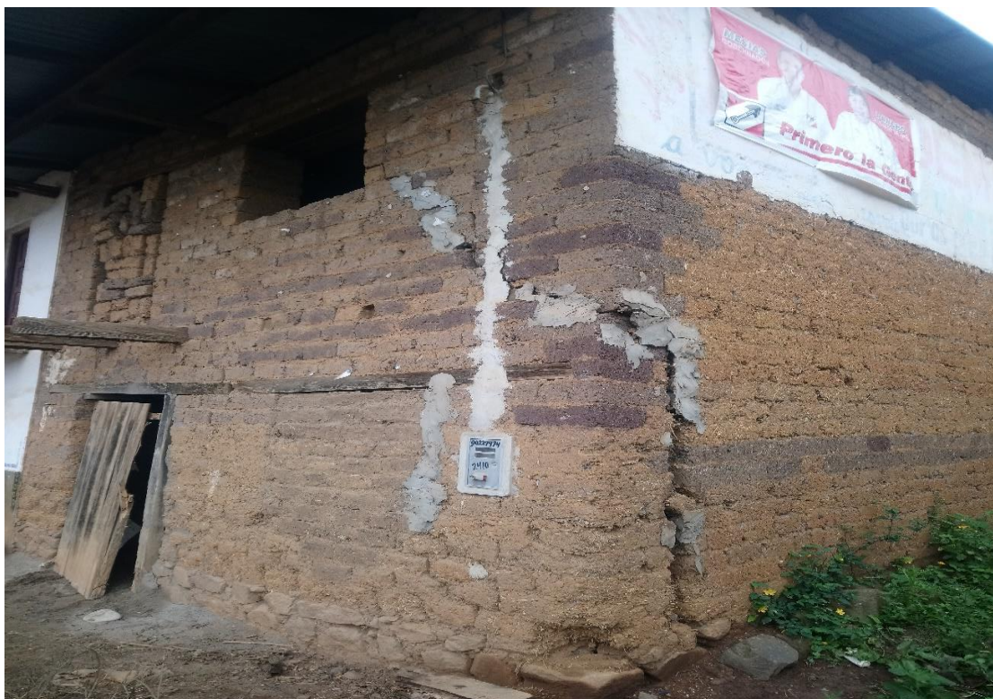
Fotografía 25: Vivienda N° 06 en estudio, grieta diagonal y vertical
