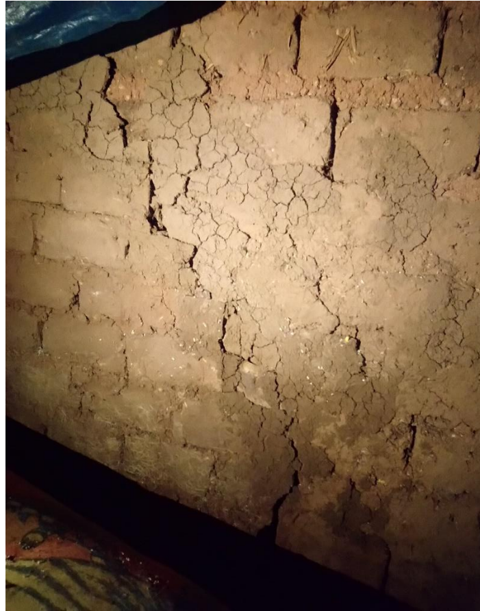
Fotografía 17: Vivienda N° 01, grieta diagonal.
