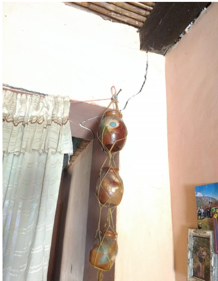
Fotografía 32: Vivienda N° 09, grieta vertical.
