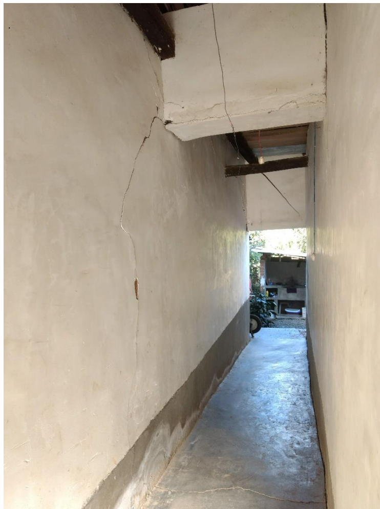
Fotografía 40: Vivienda N°12, grietas verticales y diagonales
