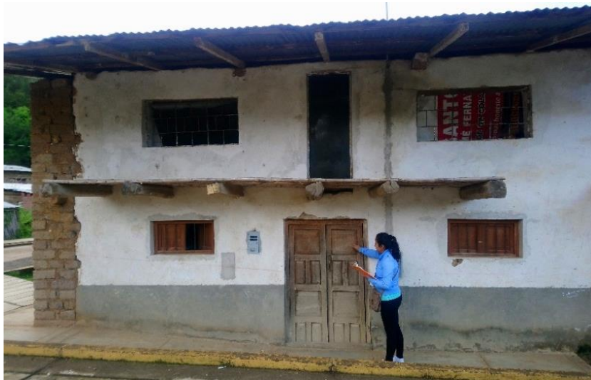
Figura 45. Aplicación de Ficha Técnica de Evaluación N°02 en Viviendas de adobe que presentan lesiones.
