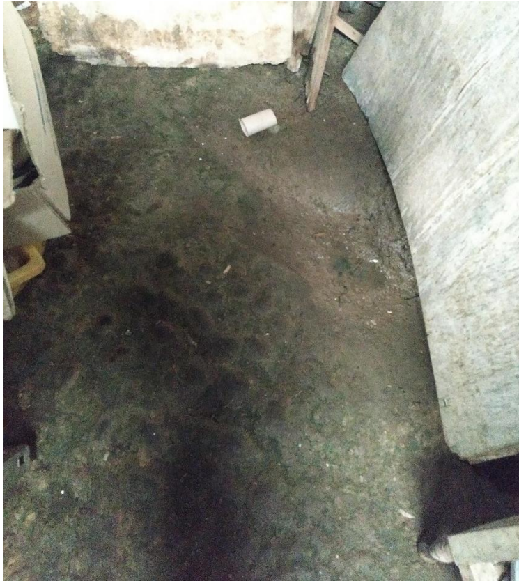
Fotografía 31: Vivienda N° 08, Humedad en el suelo.
