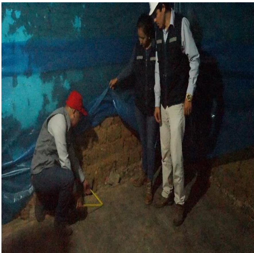
Fotografía 27: Vivienda N° 06, Medición del desplazamiento horizontal del piso con el muro.
