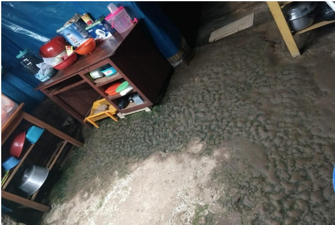
Fotografía 20: Vivienda N° 03, Humedad en el suelo.
