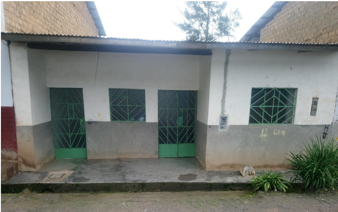
Fotografía 38: Vivienda N°12, Humedad del muro y grieta vertical.
