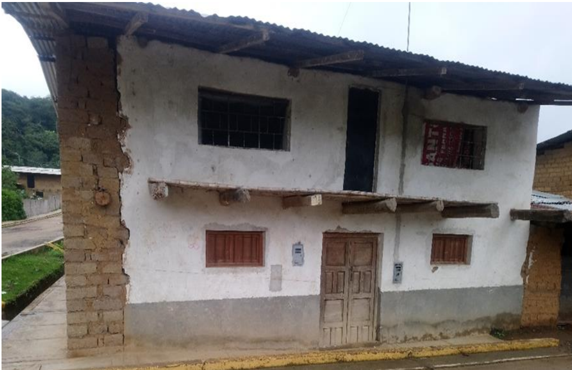
Fotografía 22: Vivienda N° 04 en estudio, grieta vertical.
