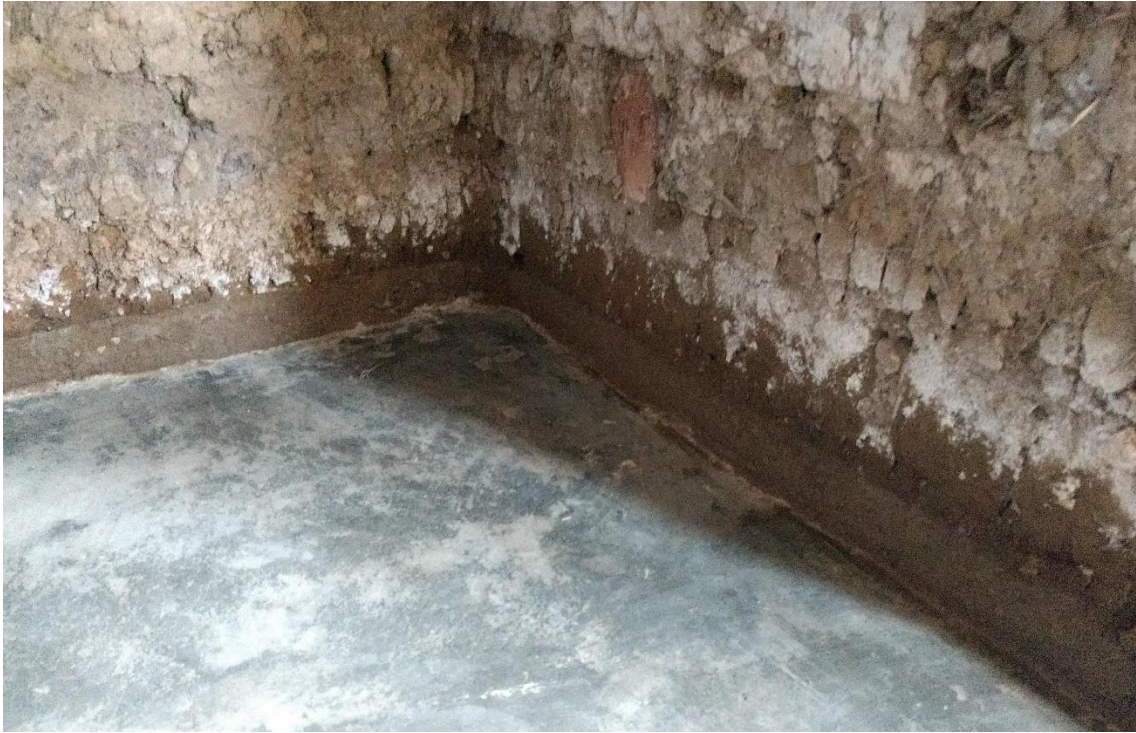
Fotografía 21: Vivienda N° 03, Humedad en la pared.
