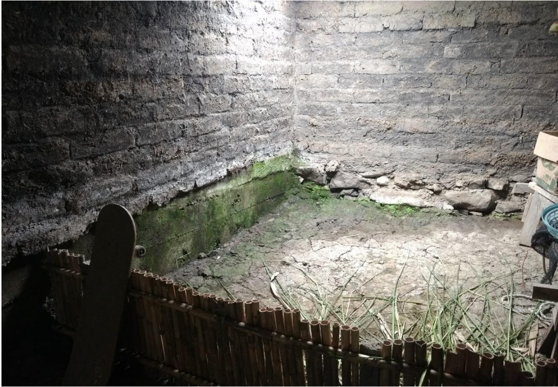
Fotografía 29: Vivienda N° 07, Humedad en el suelo y muro.
