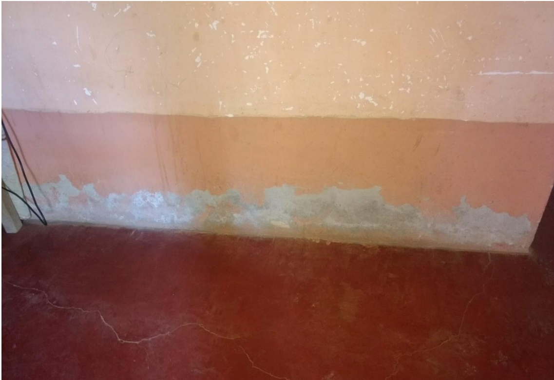
Fotografía 33: Vivienda N° 09, Humedad en el muro.
