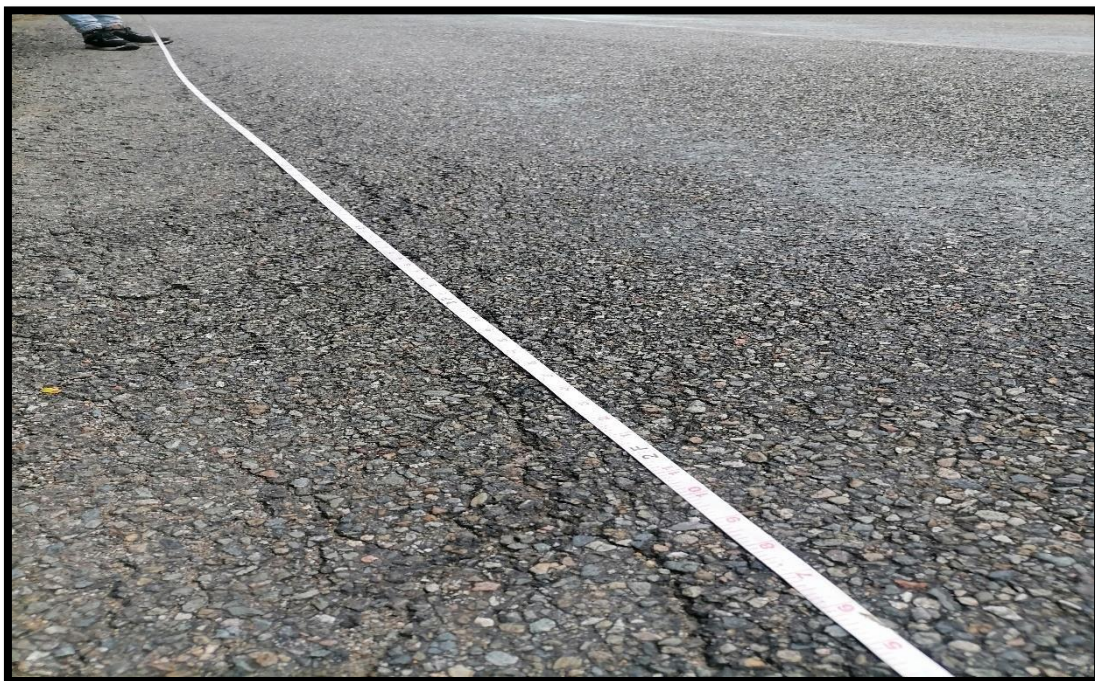
Figura 43: Unidad de muestra – 04. Fisuras en bloque
