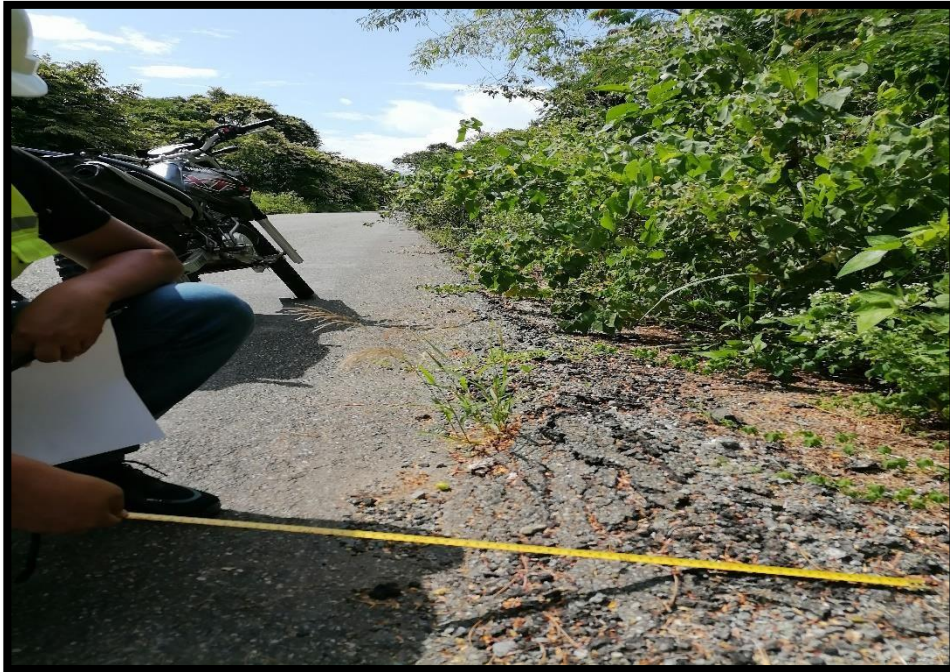
Figura 12: Desnivel carril-berma de severidad M
