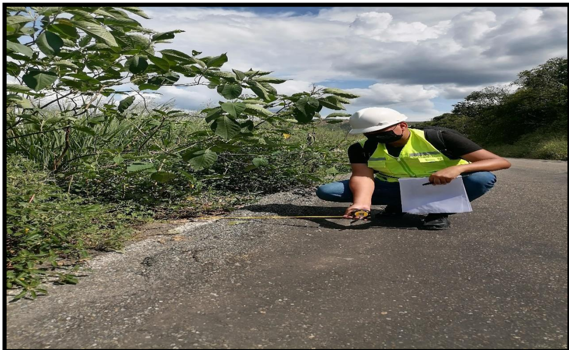
Figura 49: Unidad de muestra – 10. Abultamientos y hundimientos
