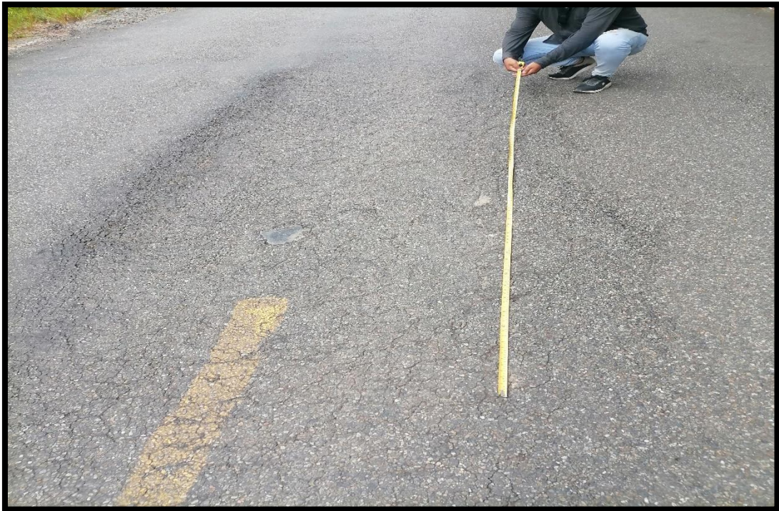
Figura 66: Unidad de muestra – 27. Fisuras en bloque
