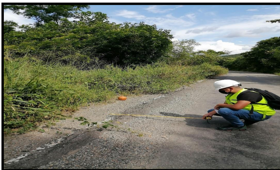
Figura 9: Abultamientos y hundimientos de severidad H
