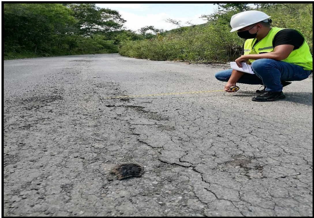
Figura 62: Unidad de muestra – 23. Desprendimiento de agregados
