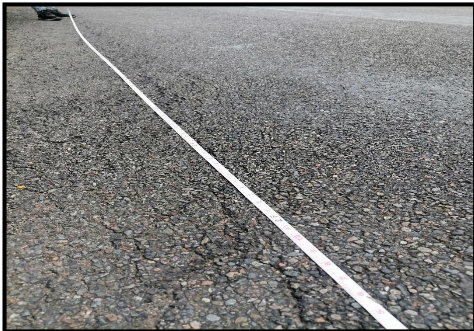
Figura 7: Falla piel de cocodrilo severidad L.
