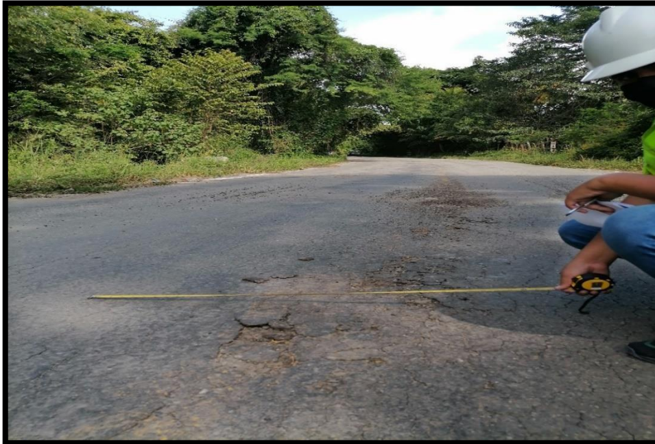
Figura 16: Ahuellamiento de severidad M
