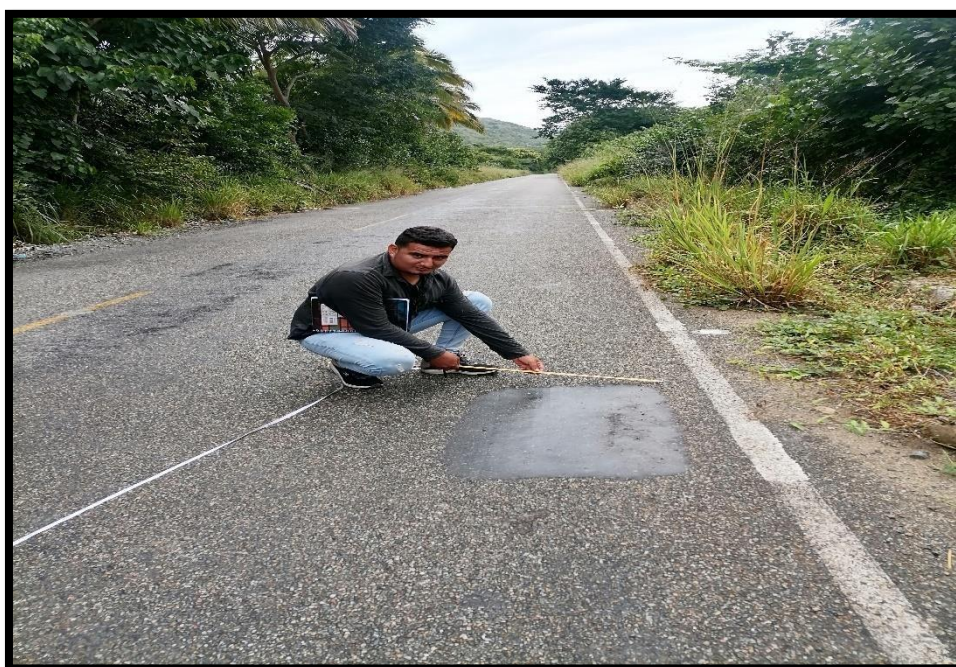
Figura 13: Parches y parches de cortes utilitarios de severidad L
