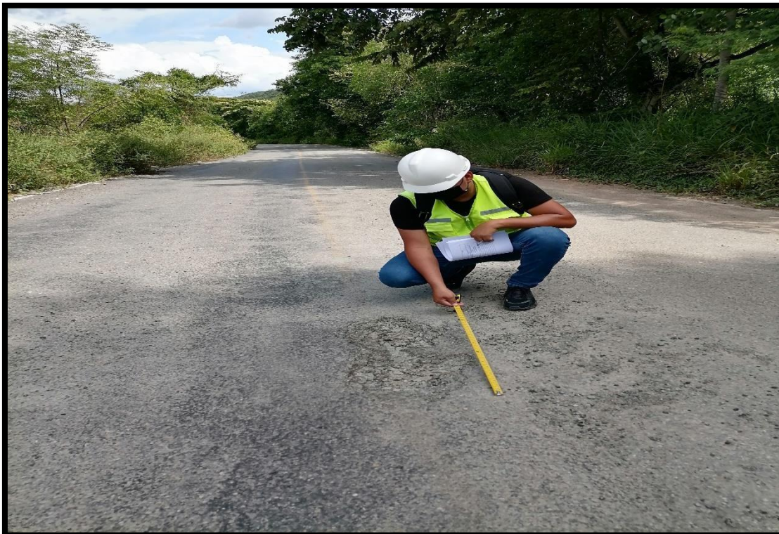
Figura 45: Unidad de muestra – 06. Desprendimiento de agregados.
