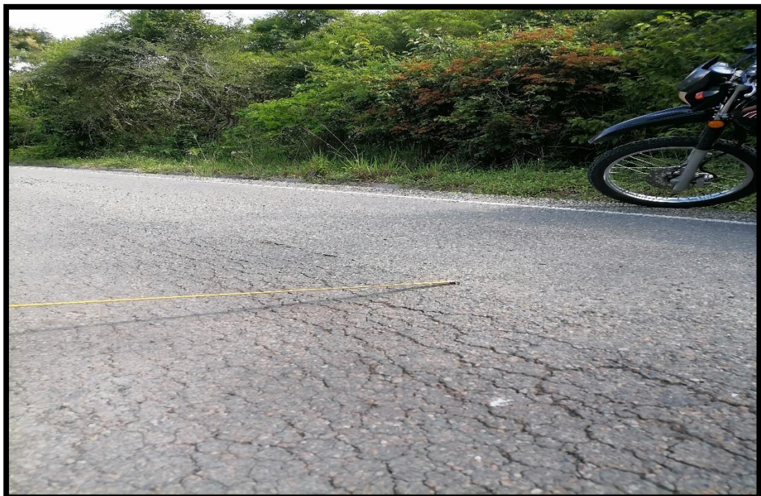
Figura 53: Unidad de muestra – 14. Fisuras en bloque
