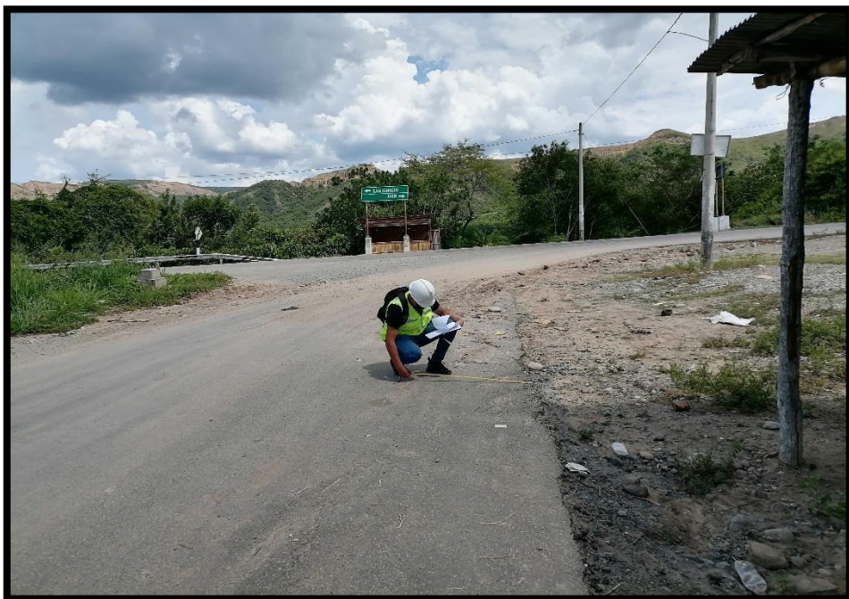
Figura 11: Fisuras de borde de severidad L
