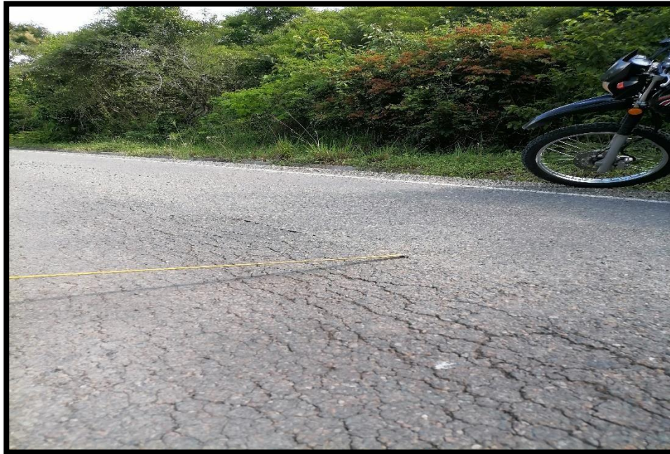
Figura 8: Falla fisuras en bloque de severidad M.
