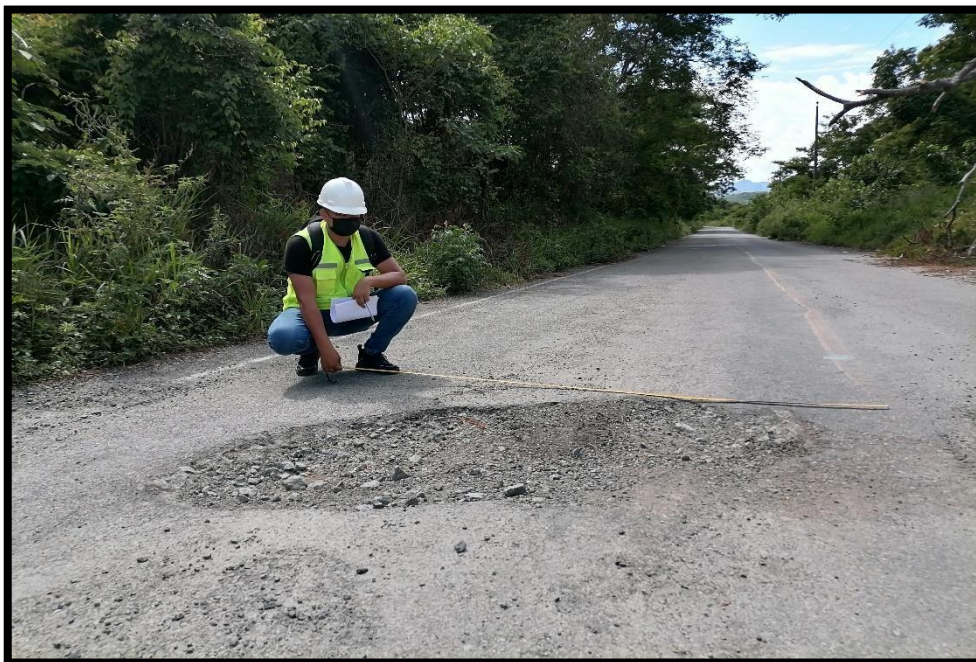
Figura 15: Huecos de severidad H
