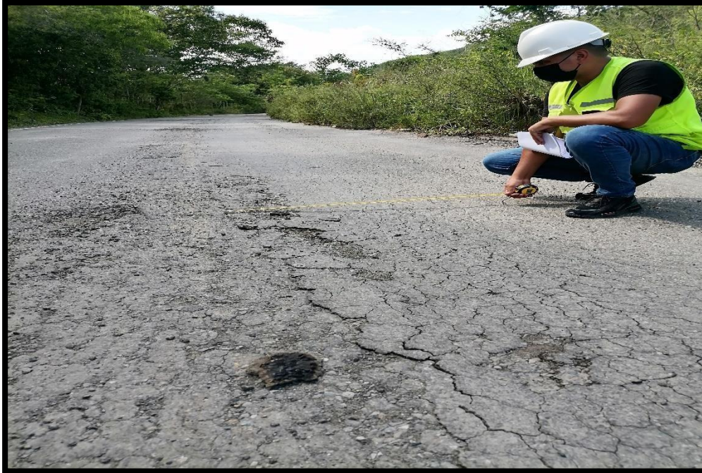
Figura 18: Desprendimiento de agregados de severidad H
