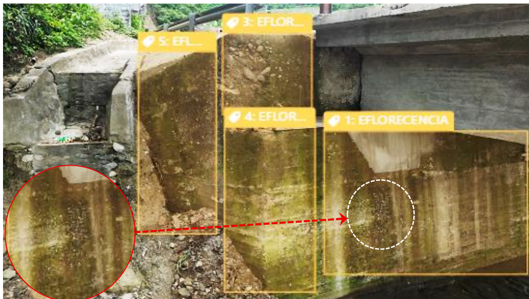
Figura 37 Asignación de etiquetas de eflorescencia en el Puente Tamborapa.
