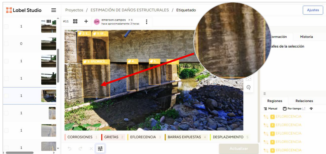
Figura 36 Identificación de eflorescencia en el Puente Tamborapa.
