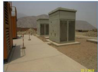
S.E. Transformación 1,5 MVA – 0,48/22,9 kV
