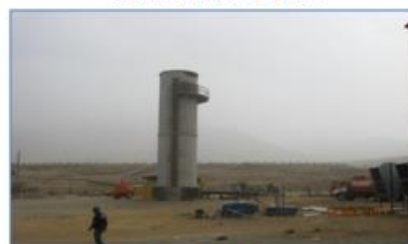
Quemador de Biogás
