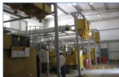
Grupos de Generación 3 x 1,6 MW
