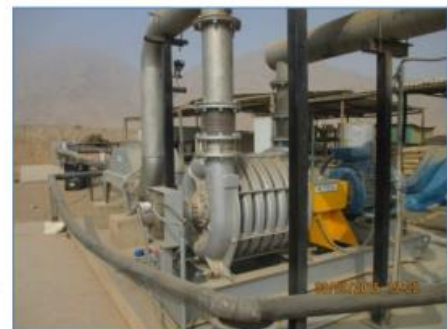
Planta de tratamiento de biogás
