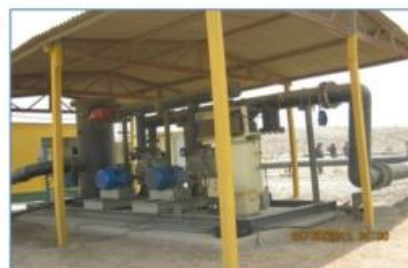
Planta de tratamiento de Biogás
