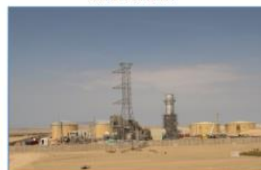
Vista panorámica de la central
