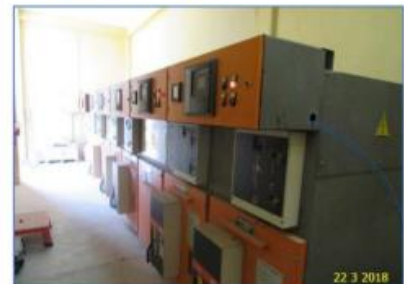
Celdas de Control en Subestación de salida
