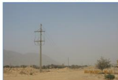
Línea de subtransmisión 22,9 kV
