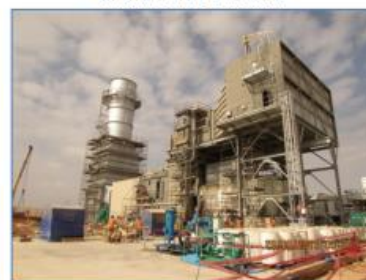
Turbogenerador y equipos auxiliares
