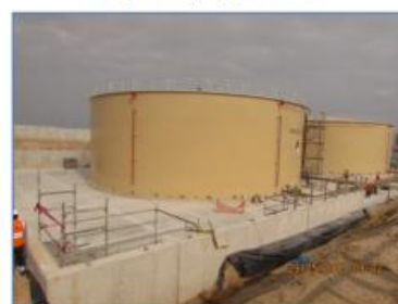
Tanques de almacenamiento de combustible Diésel B5
