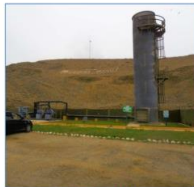
Planta de tratamiento de biogás
