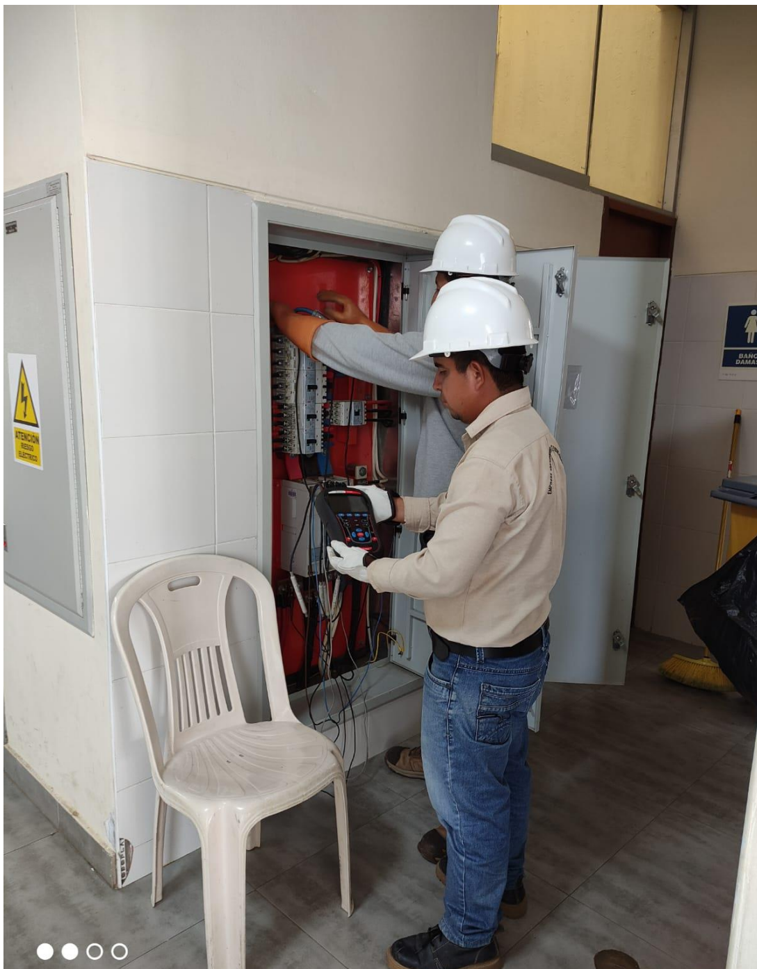
Figura 4. Los investigadores realizando mediciones eléctricas en tablero de distribución trifásico mediante analizador portátil.
