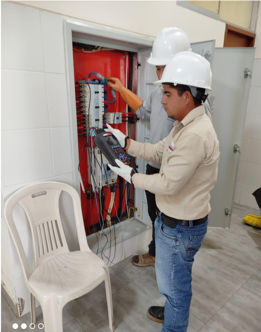
Figura 3. investigadores realizando monitoreo de parámetros eléctricos con analizador portátil en un tablero de distribución trifásico. También se evidencia el uso adecuado de elementos de seguridad: guantes aislantes, cascos y herramientas dieléctricas, garantizando condiciones seguras durante la intervención.
