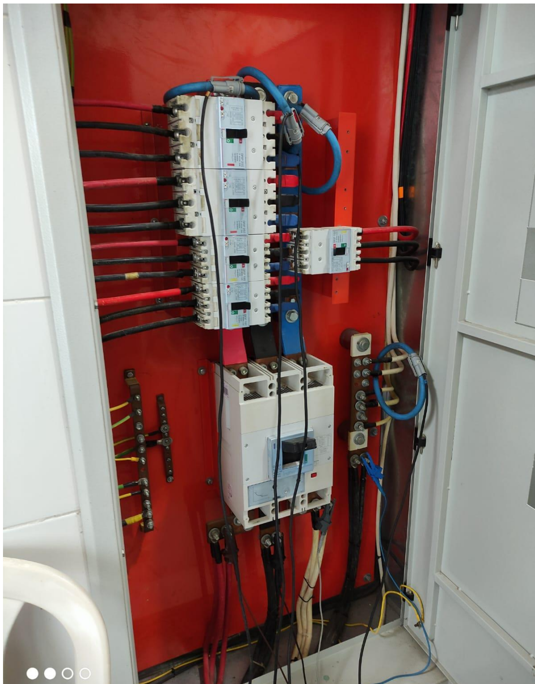
Figura 5. Tablero de distribución eléctrica trifásico con interruptor principal tipo MCCB, interruptores termomagnéticos secundarios, diferencial trifásico y barras de puesta a tierra y neutro. Se observa conexión temporal de cables para medición eléctrica.
