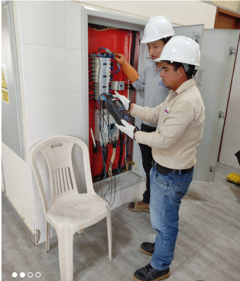
Figura 2. Operación de monitoreo eléctrico en tablero de distribución por parte los investigadores con EPP adecuado. Se observa el uso de guantes, cascos y analizador portátil para verificar parámetros de red eléctrica en una instalación de baja tensión.
