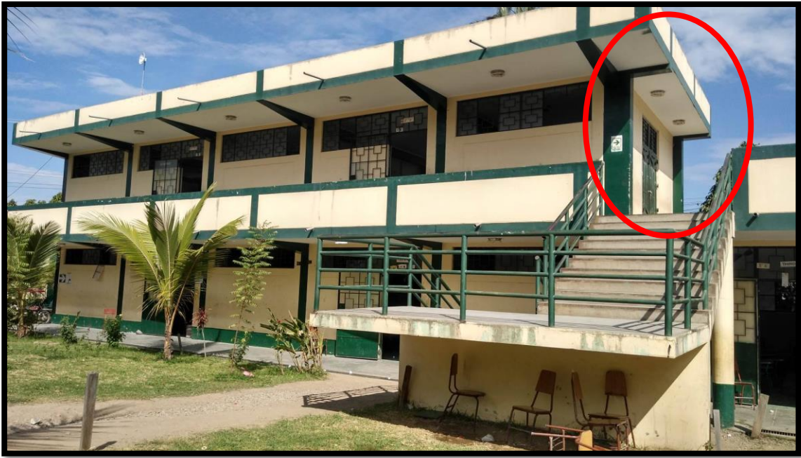
Ilustración 12: Posible irregularidad geométrica vertical en el 2° piso del Módulo VI.
