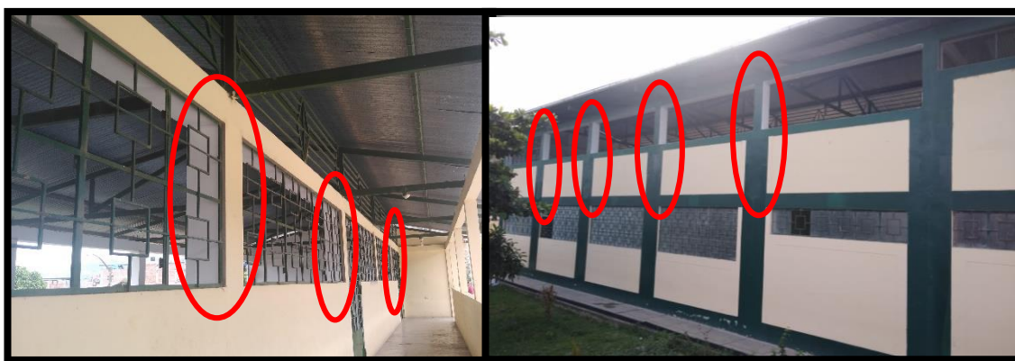
Ilustración 26: Reducción abrupta de la sección de columnas _módulos IV y VIII; en el eje A-A (imagen derecha), y en el eje C-C (imagen izquierda)
