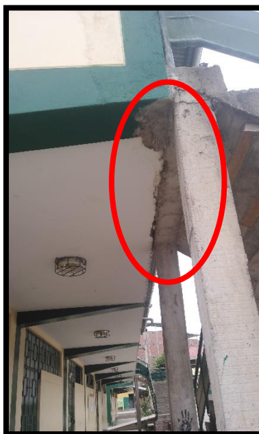
Ilustración 11: Inadecuada distancia de separación entre Módulo IV y escalera.
