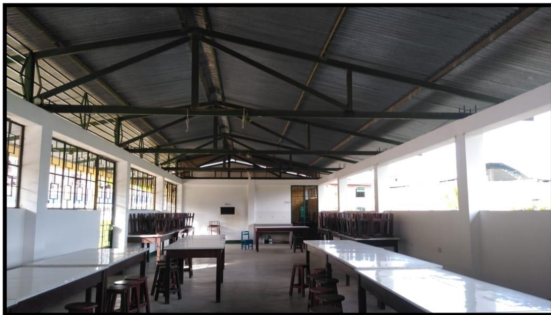
Ilustración 16: Techo de cobertura liviana (calamina zinc + tijerales metálicos), en el 2° nivel de los módulos IV y VIII.
