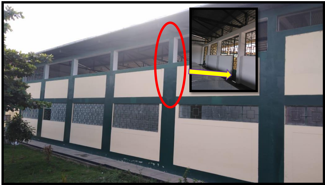
Ilustración 14: Reducción abrupta de área de elementos verticales resistentes (columnas), en los módulos IV y VIII.
