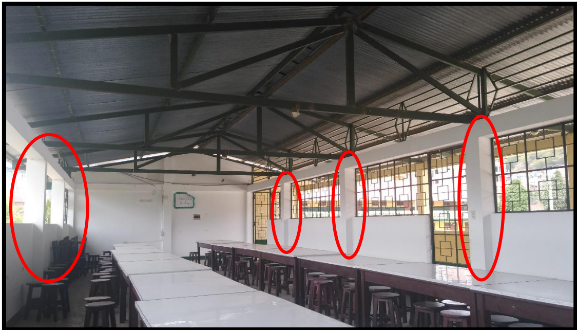
Ilustración 41: Problema de columna corta, localizados en los ejes A-A y C-C, del 2° piso de los módulos IV y VIII.
