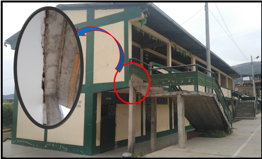
Ilustración 35: Deficiente separación entre el módulo IV y la escalera, separación=1cm.
