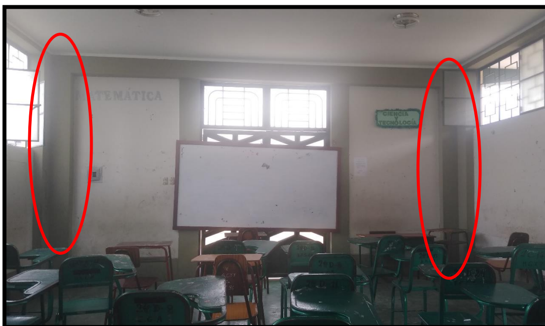
Ilustración 42: Problema de columna corta, localizado en el eje 6-6, del 2° piso del módulo VI.
