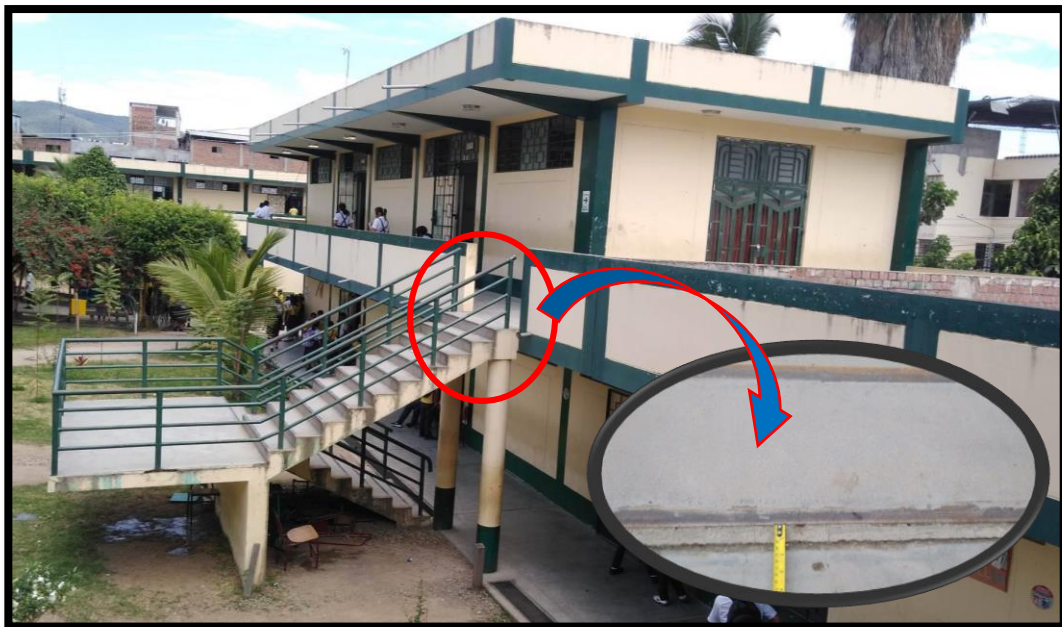
Ilustración 38: Deficiente separación entre el módulo VI y la escalera, separación=3cm.
