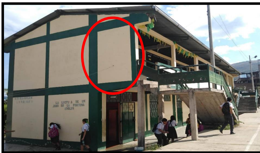
Ilustración 10: Aparece muro portante en el 2° nivel, módulo IV.
