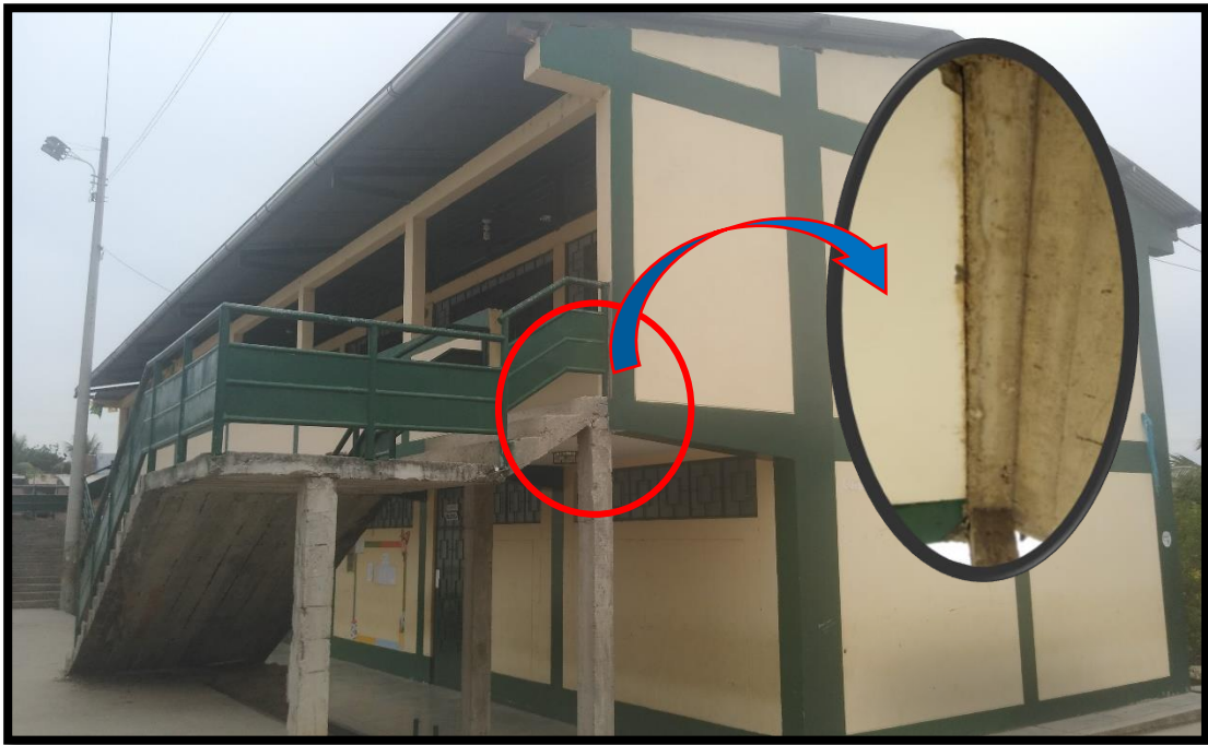
Ilustración 36: Deficiente separación entre el módulo VIII y la escalera, separación=1cm.
