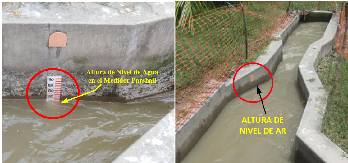
Figura N° 40. Canaleta Parshall de PTAR Nueva.
