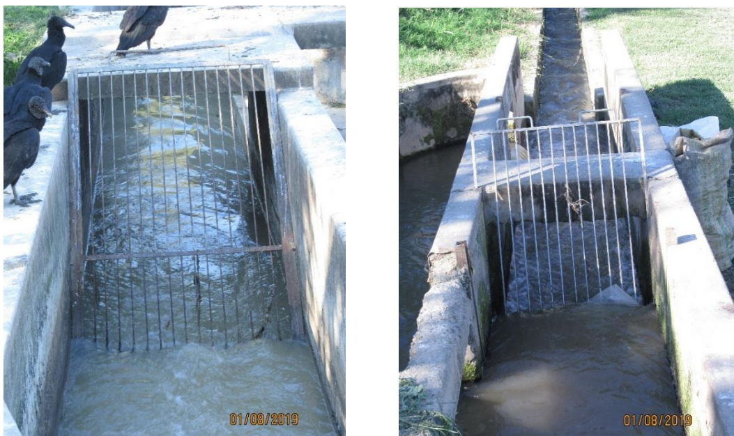
Figura N° 6. Rejas Rectas de limpieza manual (reja de desbaste de gruesos)
