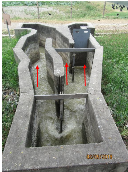
Figura N° 13. Repartidor de caudales.
